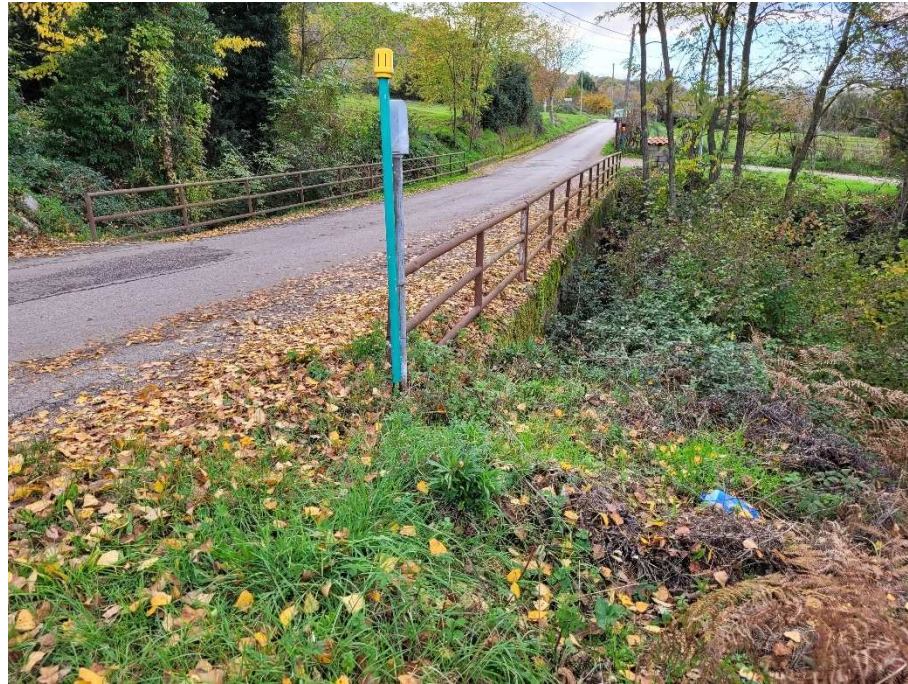
Foto 6 – Vista di via Contrada Croce nel punto di attraversamento del corso d’acqua demaniale, guardando verso Ovest.
