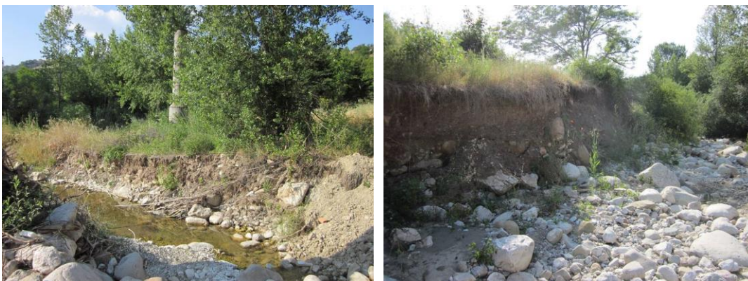
Figura 43. L'attività torrentizia della Fiumara è visibile dalle condizioni dell'alveo
