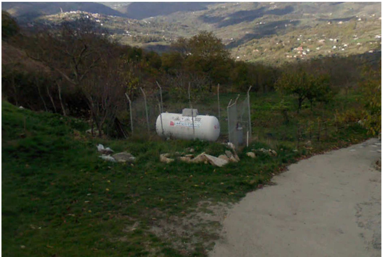
Figura 2 – Cisterna di GPL analizzata
