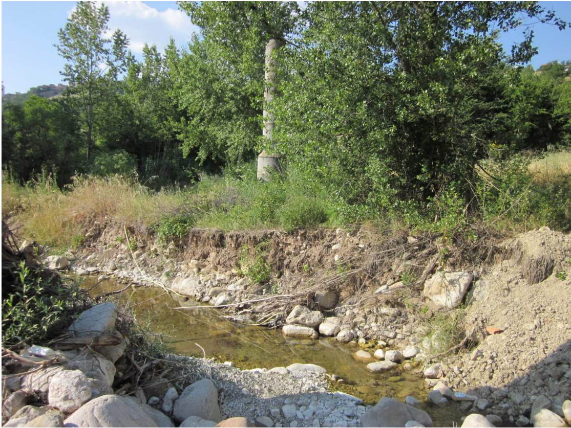
Figura 6. Evidenti segni di erosione laterale lungo il corso della fiumara di Ruoti (3).
