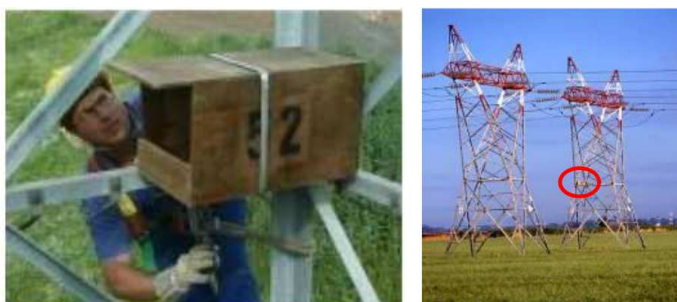
Figura 9. Esempi di nidi artificiali per l'avifauna installabili nel terzo medio ed inferiore dei tralicci del nuovo elettrodotto.
