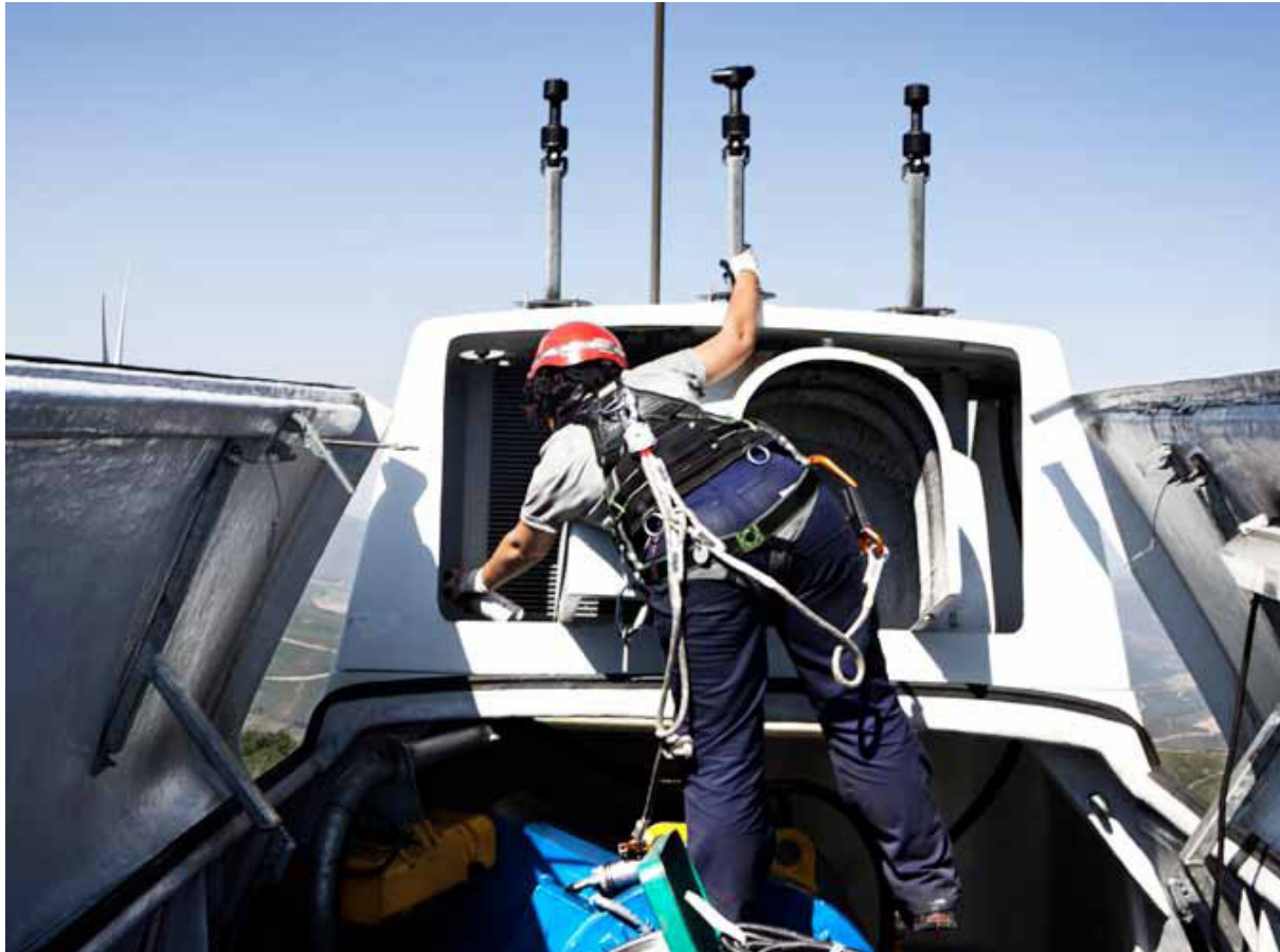
Fig. 4-1b. Navicella della turbina V112 a cielo aperto
