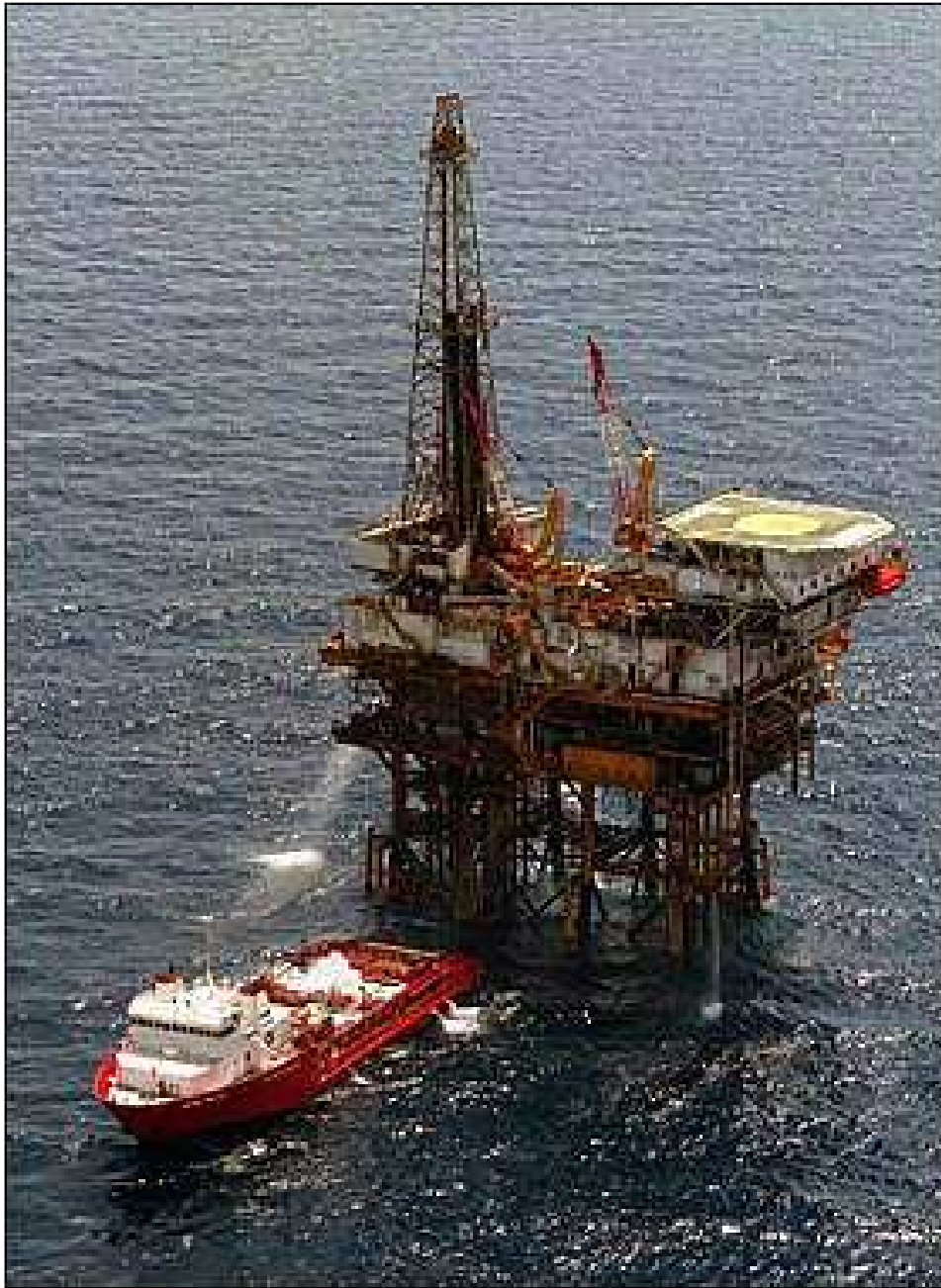
Fig. 3-4h. Piattaforma della messicana Pernex danneggiata da un'esplosione durante una violenta mareggiata (Ottobre 2007)
