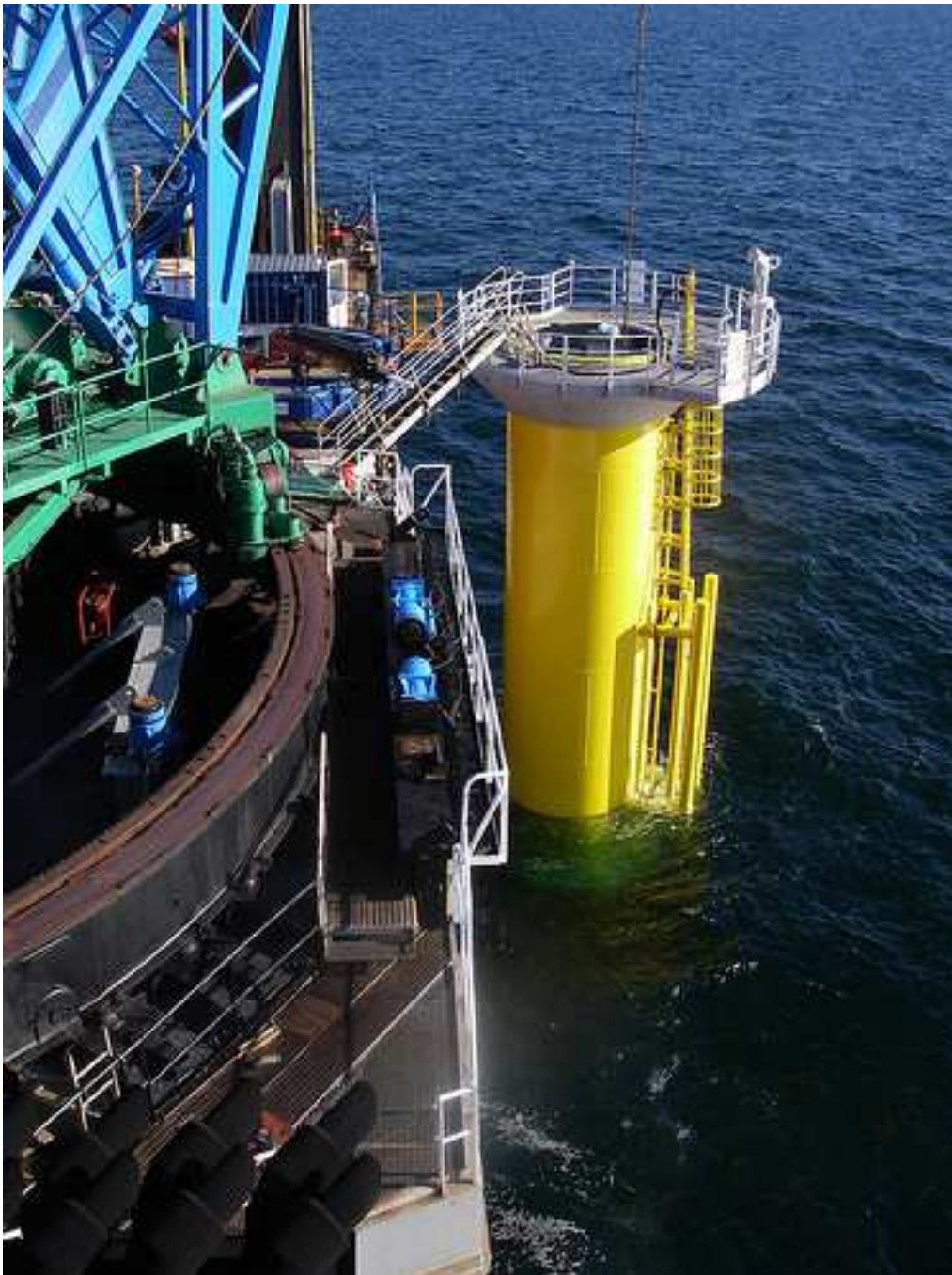
Fig. 2-4. Struttura fondaria a monopila per turbina eolica durante i montaggi (Horns Rev)
