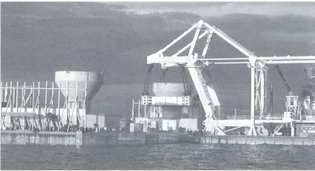
Fig. 3-1i. Preparazione di fondazioni a gravità per il varo a Thornton Bank (Elsan)
