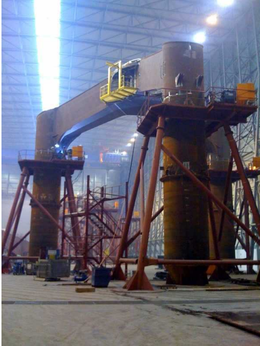
Fig. 3-3l. Fondazione per la turbina BARD da 5 MW in costruzione presso l'officina di Cuxhaven
