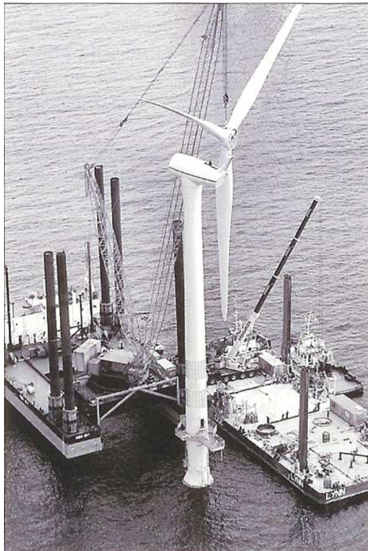
Fig. 3-2a. Impiego di piattaforme autosollevanti (tipo jack-up) nell'installazione di turbina eolica su fondazione monopila
