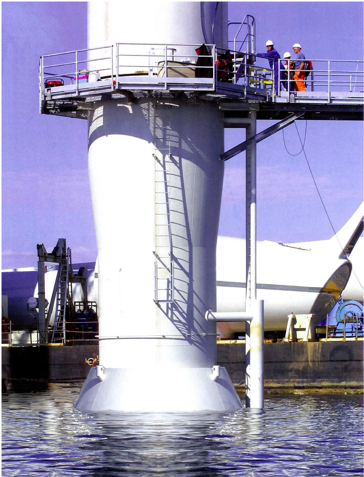
Fig. 3-2b. Sezione di collegamento tra fondazione monopila e torre dell'aerogeneratore durante le fasi del montaggio (si notano i tubi della landing structure e dei J-tube; sullo sfondo, alcuni elementi della turbina, dislocati sui mezzi navali impiegati per i montaggi)
