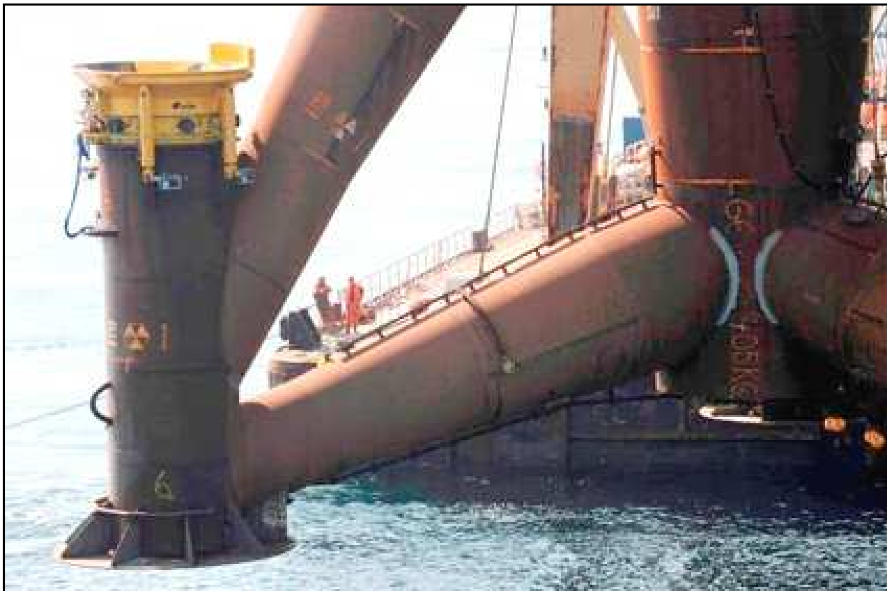
Fig. 3-3q. Particolare del tronchetto di tubazione di guida dei pali fondari del tripode durante l'installazione a mare (Alpha Ventus)
