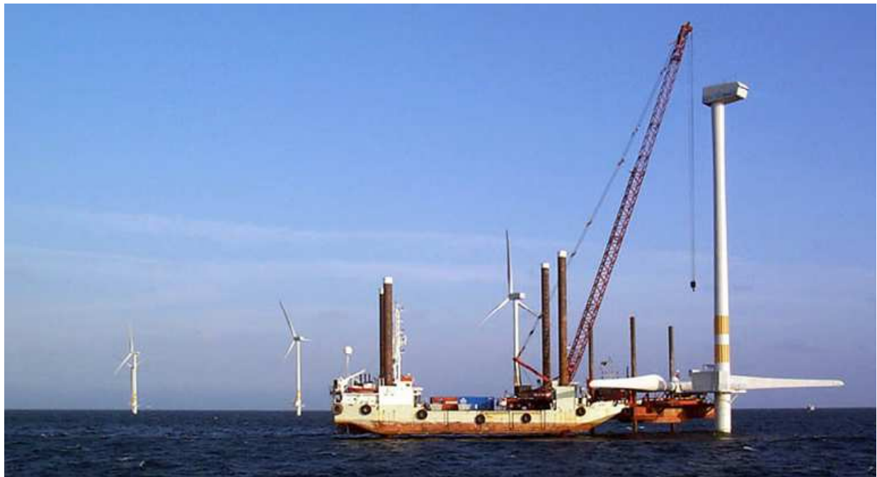
Fig. 3-2g. Montaggio di navicella e di rotore su aerogeneratore, impostato su fondazione a monopila (GE Wind)
