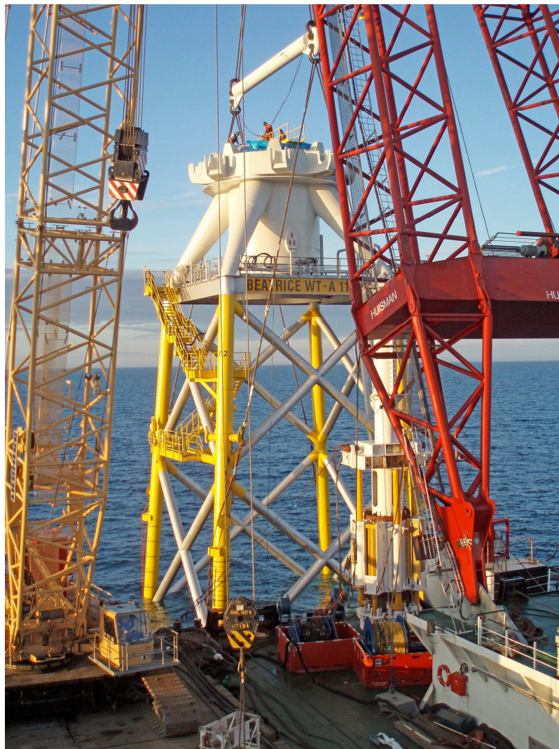
Fig. 3-4a. Fondazione a castello a quattro montanti per turbina eolica REpower M5, mentre si sta predisponendo lo zoccolo di base della torre ad elemento di transizione (Beatrice)
