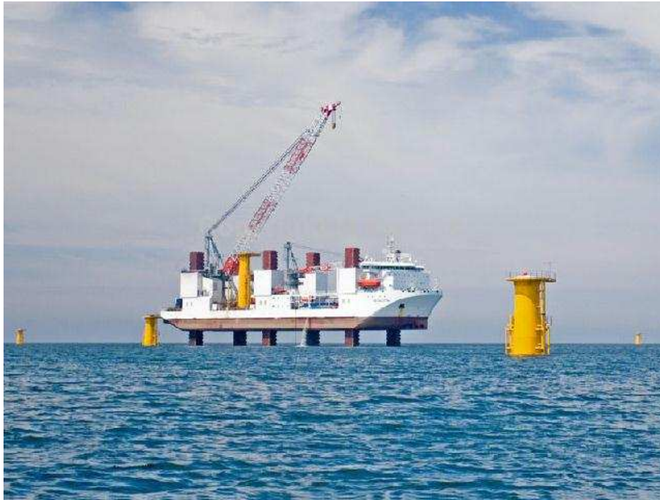
Fig. 2-4a. Campo eolico di Walney.1 nel Mar d'Irlanda di 73 kmq di specchio acqueo a 15 km dalle coste dell'isola omonima, composto da 51 unità da 3,6 MW (Siemens SWT-3,6-107) impostate su fondazioni a monopila in fondali da 19-23 m di profondità
