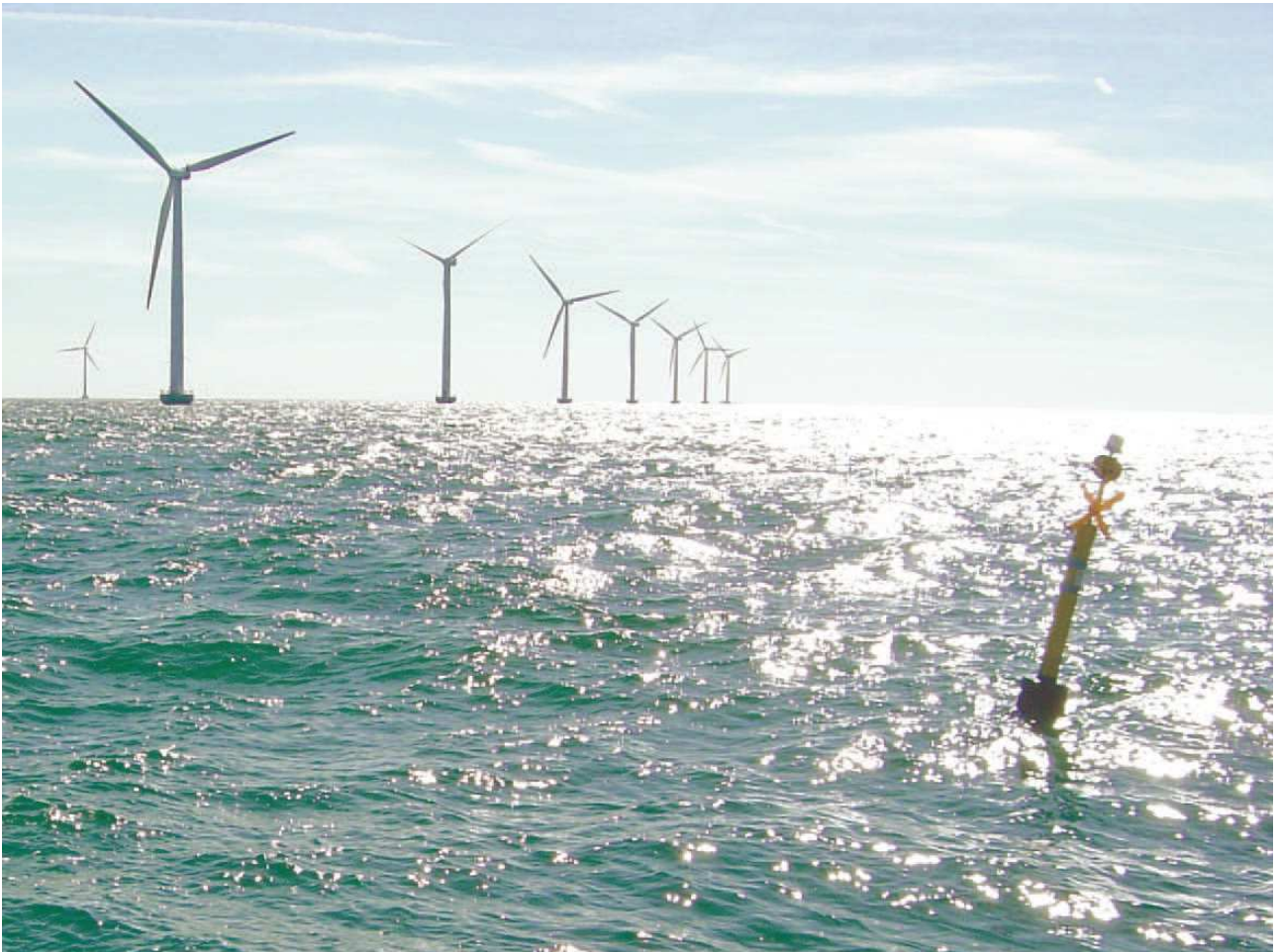
Fig. 1-1a. Impianto di Nysted
