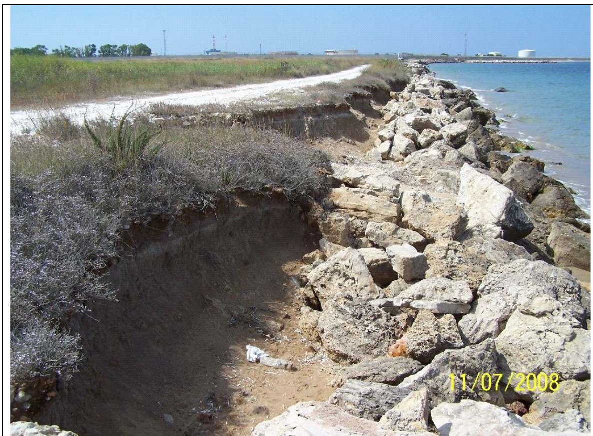
Foto 14 – Tratto di costa in forte erosione tra Capo di T.re Cavallo e P.ta della Contessa.
