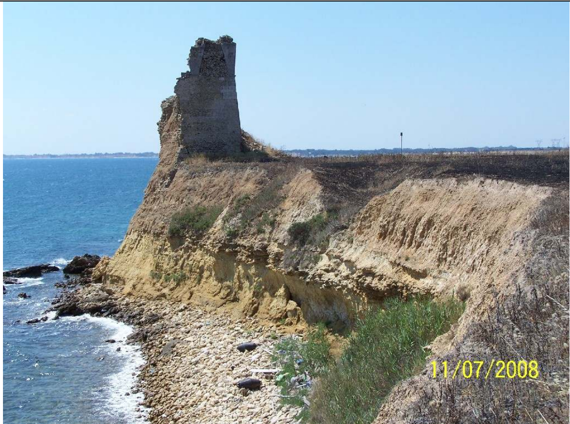
Foto 16 – Scalzamento al piede della falesia presso Torre Mattarelle.
