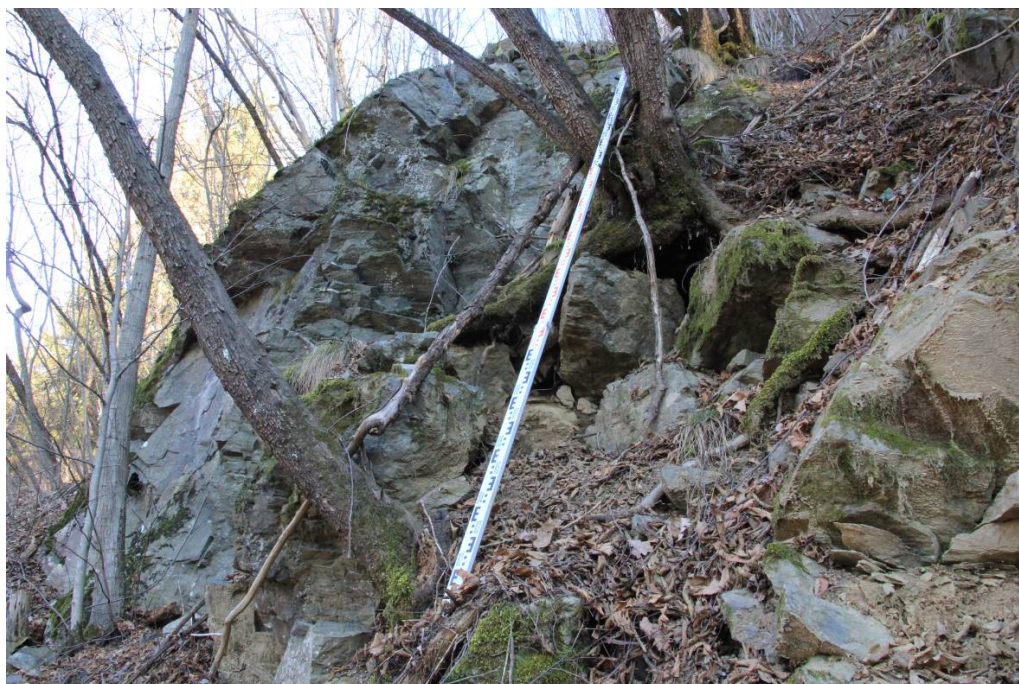
Figura 29. Vegetazione in crescita all'interno dell'ammasso roccioso fratturato.
