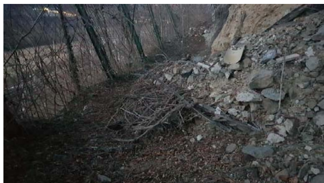
Figura 32 Dettaglio di controventatura delle barriere esistenti sepolto parzialmente sotto un accumulo di detrito.
