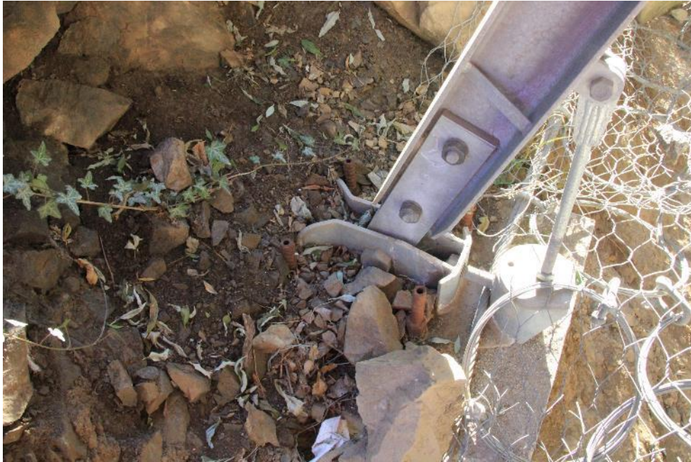
Figura 23. Tirafondi e dadi fortemente ossidati.
