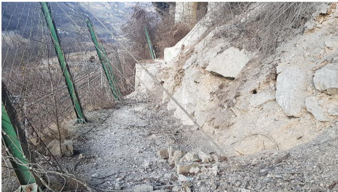
Figura 32. Tratto in sovrapposizione delle barriere esistenti all'altezza della pila n. 22 del viadotto autostradale "Novale".
