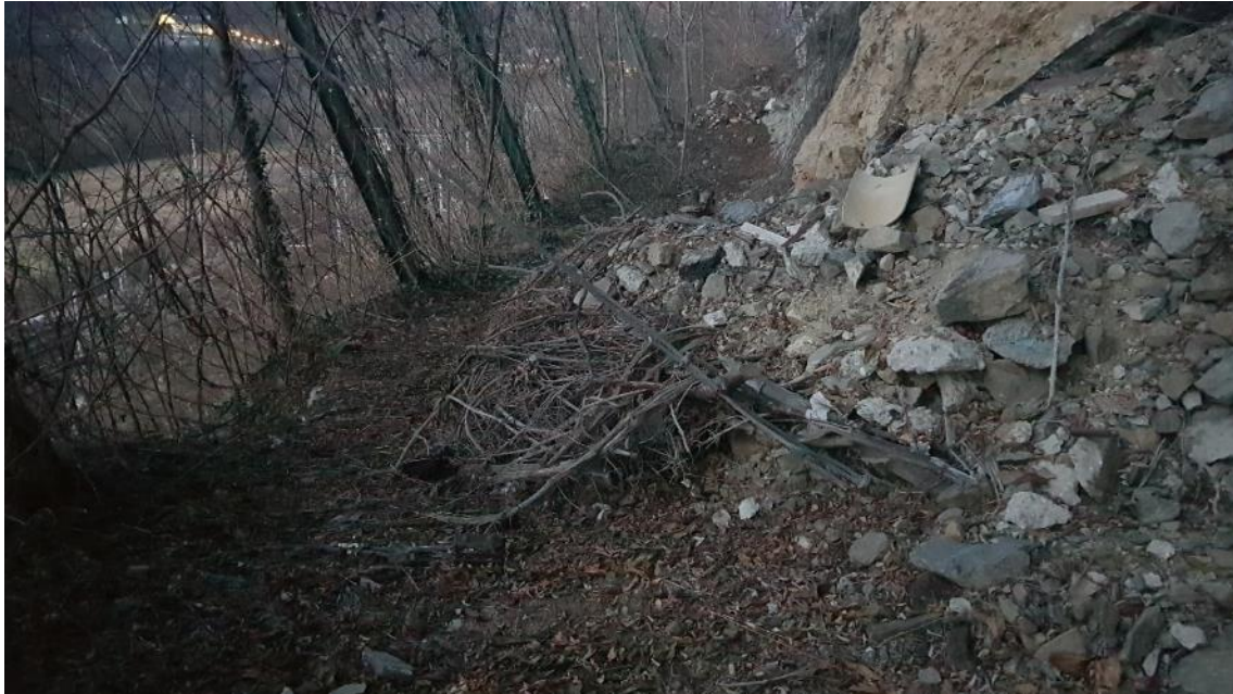
Figura 21. Dettaglio di controventatura delle barriere esistenti sepolto parzialmente sotto un accumulo di detrito.
