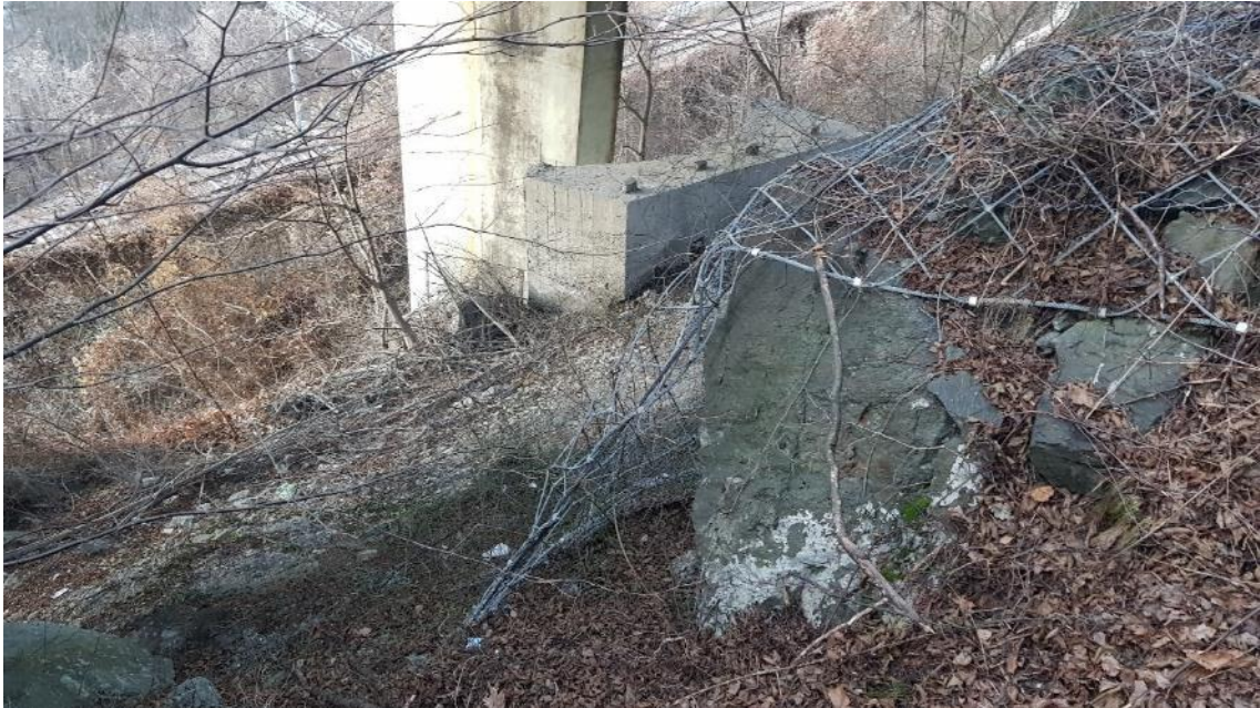
Figura 26. Pannelli in fune localizzati a monte della pila n. 21 del viadotto autostradale “Novale” con scarsa aderenza e privi di funi di armatura.
