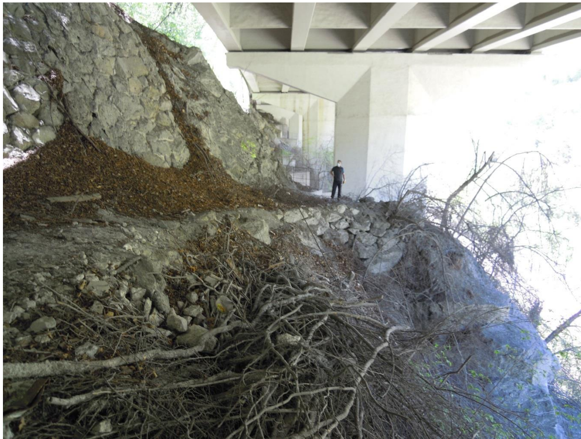
WP 375_Posizioni 16 e 17. Estensimetro a filo lunghezza ca. 3-4,0 m e estensimetro a barra (da verificare post pulizia del pendio)
