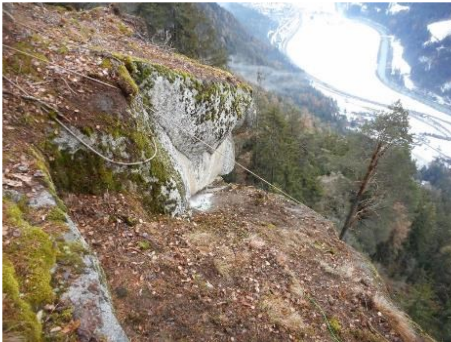
Fig. 2. Estensimetro a barra Fe1 installato in corrispondenza di un blocco roccioso in prossimità della recente nicchia di distacco.
