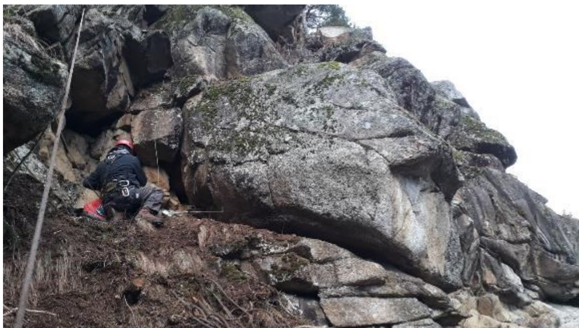
Fig. 5. Estensimetro a barra Fe5 installato su un blocco completamente svincolato posto nella porzione W dell'ammasso roccioso.
