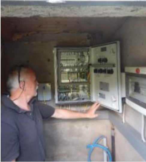
Figura 3. Quadro di controllo della pompa del pozzo Autostrada.
