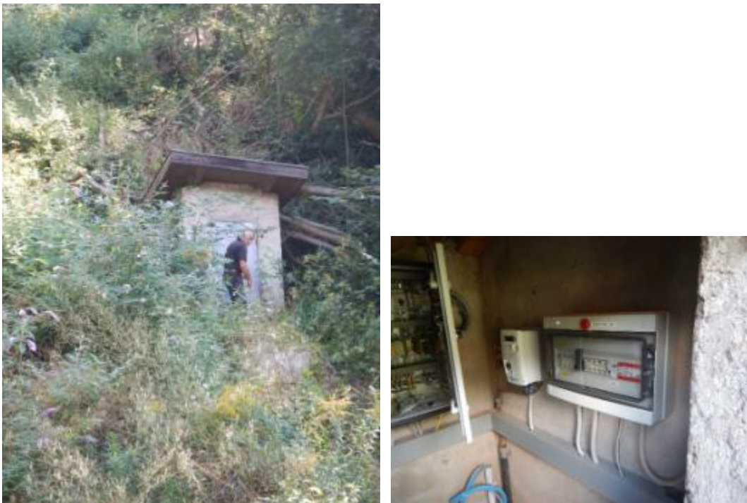
Figura 2. Cabina elettrica a servizio del pozzo Autostrada.
