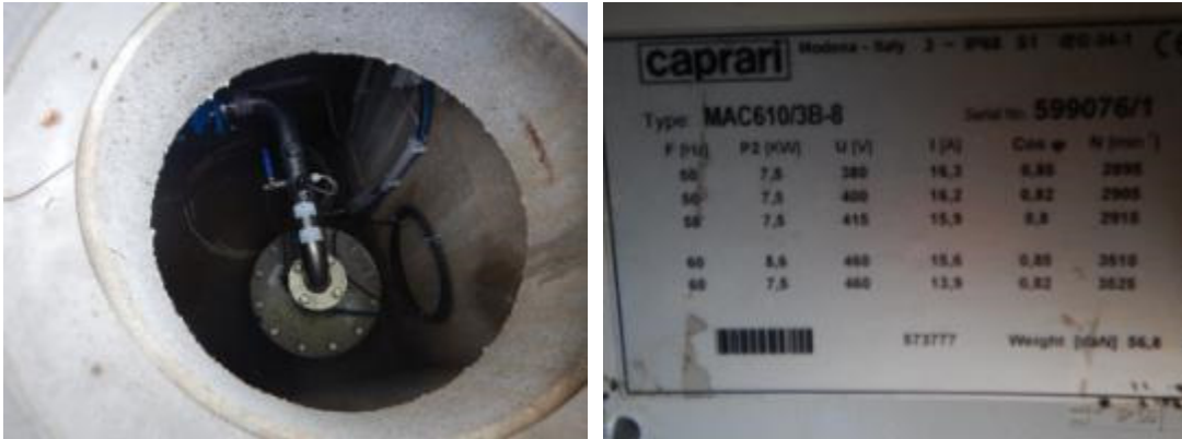
Figura 1. Pozzo Autostrada e dati di targa dell'elettropompa.
