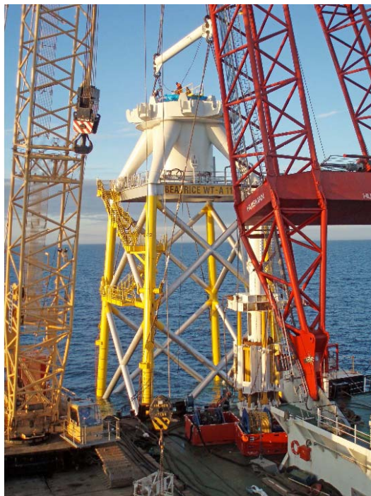
Fig. 3.10 : Fondazione a castello a quattro montanti per turbina eolica 5M, mentre si sta predisponendo lo zoccolo di base della torre (REpower)
