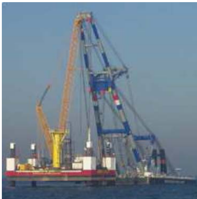
Fig. 4.44 : Avvio dell'installazione della turbine eolica su fondazione a monopila mediante jack-up "LISA A" e pontone autosollevante, entrambi equipaggiati con gru (Robin Rigg)
