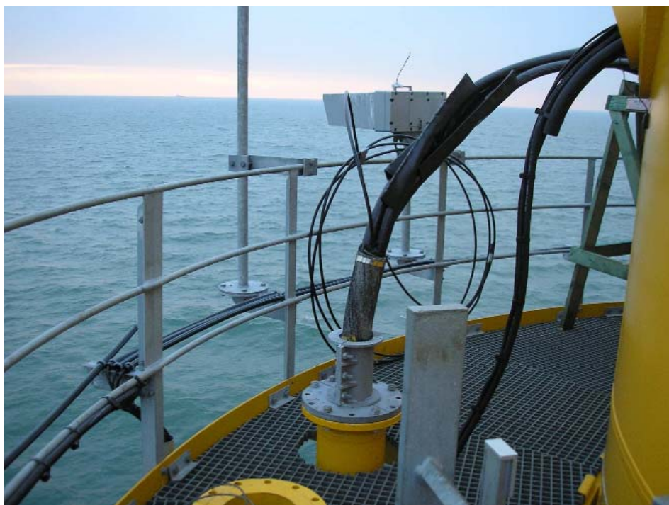
Fig. 3.20 : Uscita dei cavi dal tubo di guida e connessioni con i quadri all'interno dell'aerogeneratore
