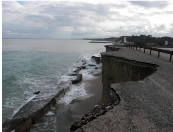
crollo area panoramica a Sud della centrale ENEL di Cerano.
