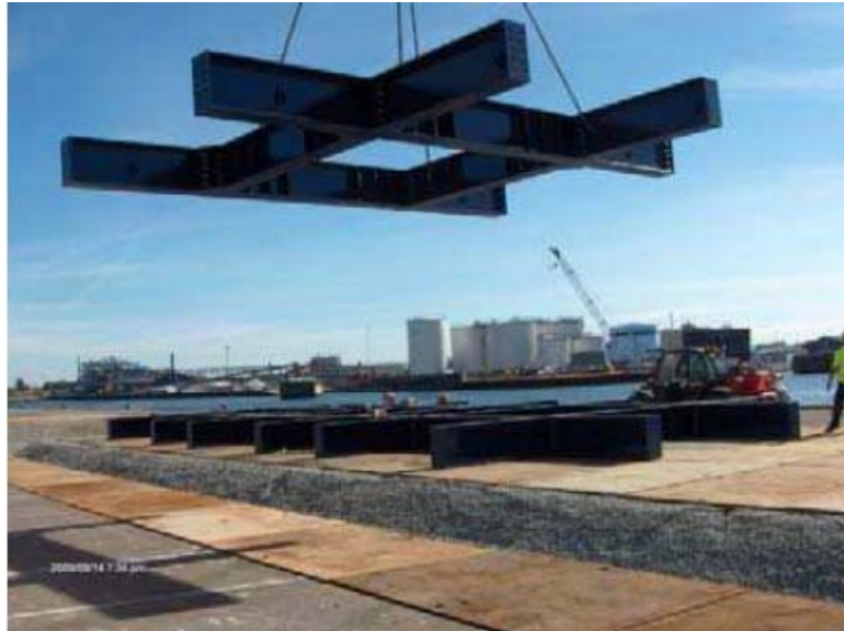
Fig. 4.16 : Grigliato a grosse travi di legno per reggere torri complete/sezione di base nell'area prospiciente il punto di carico dei battelli per il sito con strato di ghiaia di diversa granulometria per livellamento (Vestas)
