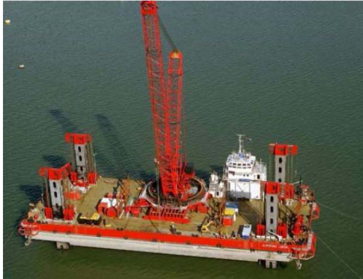
Fig. 4.32 : Vista aerea di piattaforma autosollevente (jack-up), equipaggiata con gru dalla massima altezza di gancio di 120m (A2SEA)
