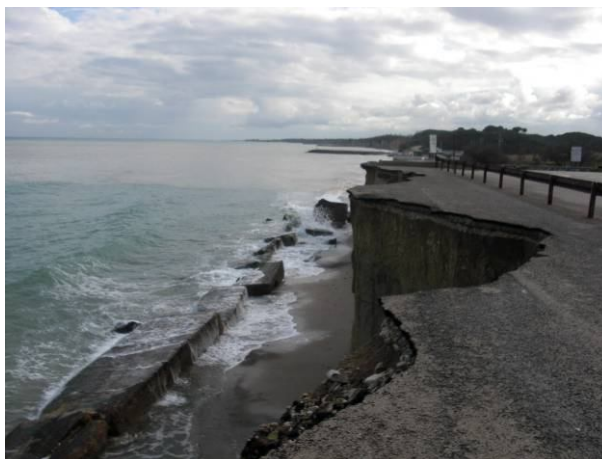
Fig. 32 crollo area panoramica a Sud della centrale ENEL di Cerano
