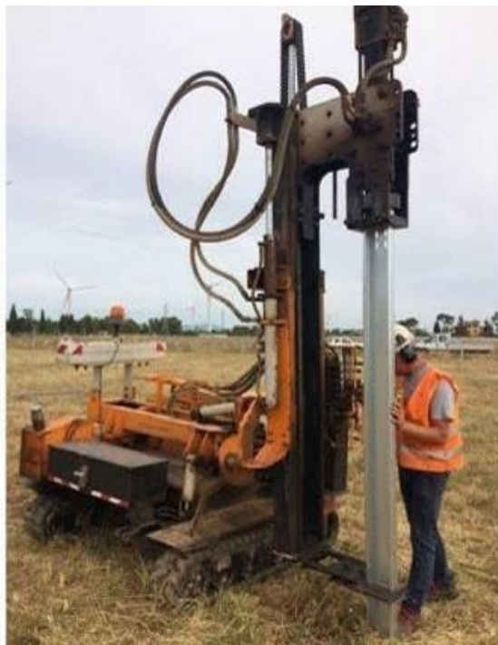
Fig. 46_ Esempio di supporto costituito da palo in acciaio infisso direttamente nel terreno mediante battipalo
