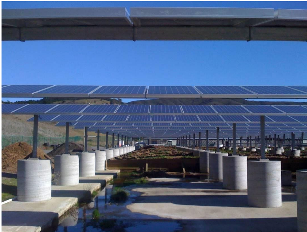
Fig. 48 Esempio di impianto fotovoltaico con fondazioni formate da zavorre costituite da plinti in cemento
