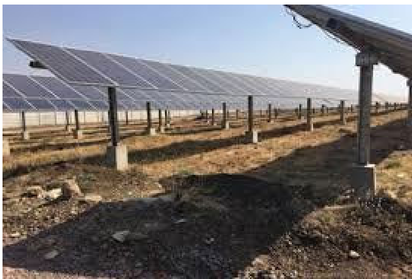
Fig.47 _ Esempio di impianto fotovoltaico con fondazioni ottenute mediante perforazione del terreno e
