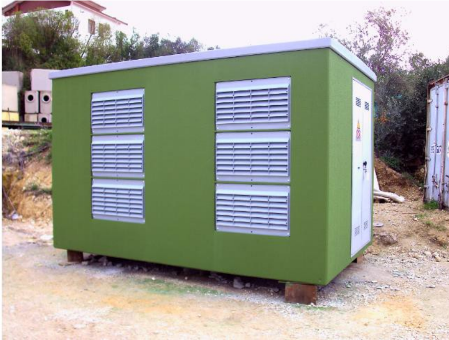
Figura 22: Tipico della cabina elettrica di smistamento prefabbricata
