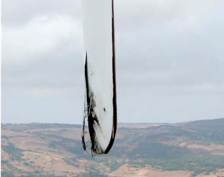
Figura 3: Estremità di pala danneggiata da fulminazione atmosferica
