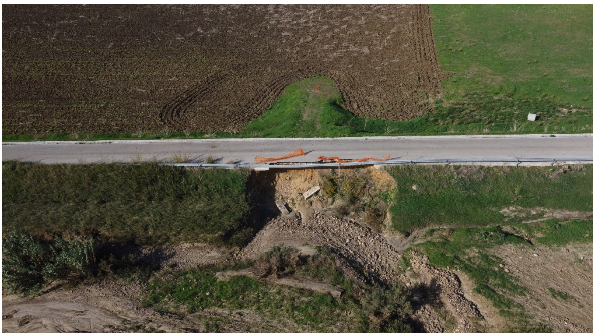
Interferenza 7 – Attraversamento zona in frana, Comune di Salemi
