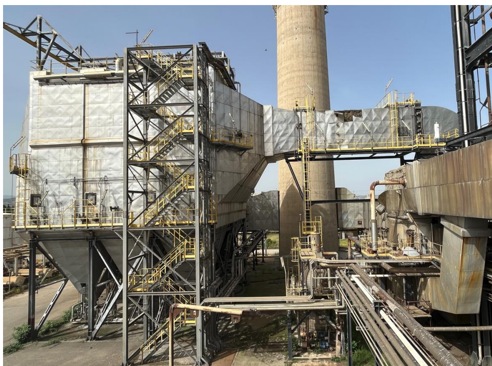
Figura 30 – Le linee fumi delle caldaie G100 e G200 oggetto di demolizione (sigle A1 e A2 di figura 29)
