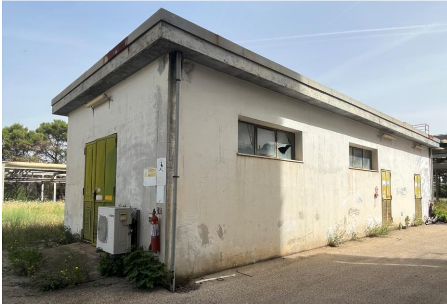
Figura 33 – cabina elettrica in c.a. (sigla D di figura 29)
