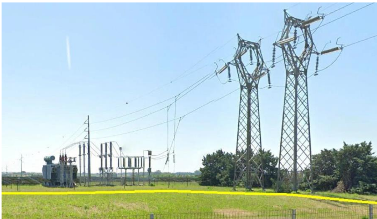
Figura 3-8 – Foto dello stallo di TR nella CP Furbara, derivato mediante stralli a terra della linea Santa Marinella – Cerveteri..
