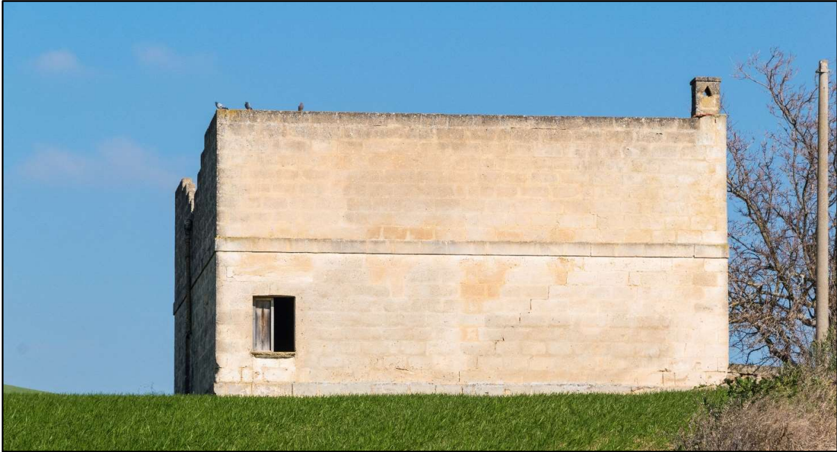
Foto 79a: R107-Fabbricato Diruto
