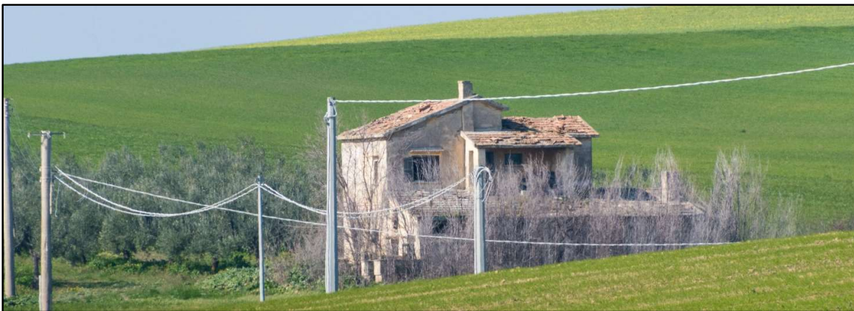
Foto 71a: R99-Fabbricato Diruto
