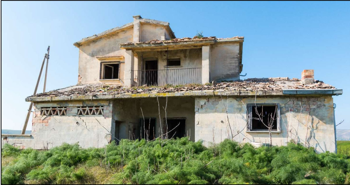
Foto 33a: R44-Fabbricato Diruto
