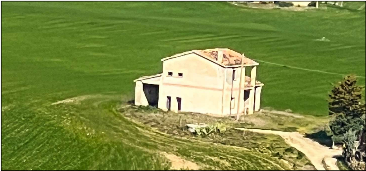
Foto 5a: R05-Fabbricato Diruto
