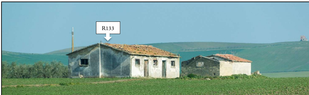
Foto 100a: R133-Fabbricato Diruto
