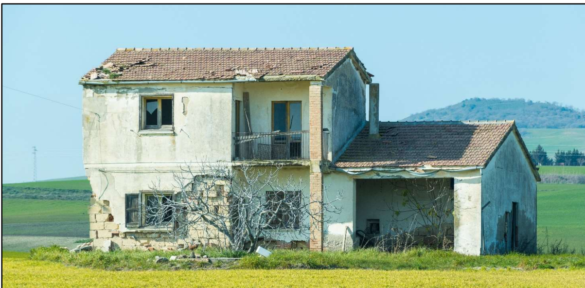
Foto 92a: R123-Fabbricato Diruto
