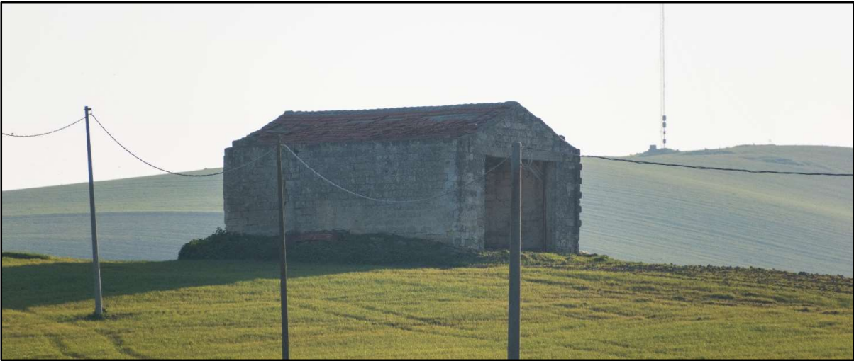
Foto 12a: R12-Fabbricato Diruto
