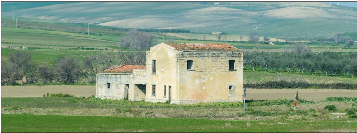
Foto 83a: R111-Fabbricato Diruto
