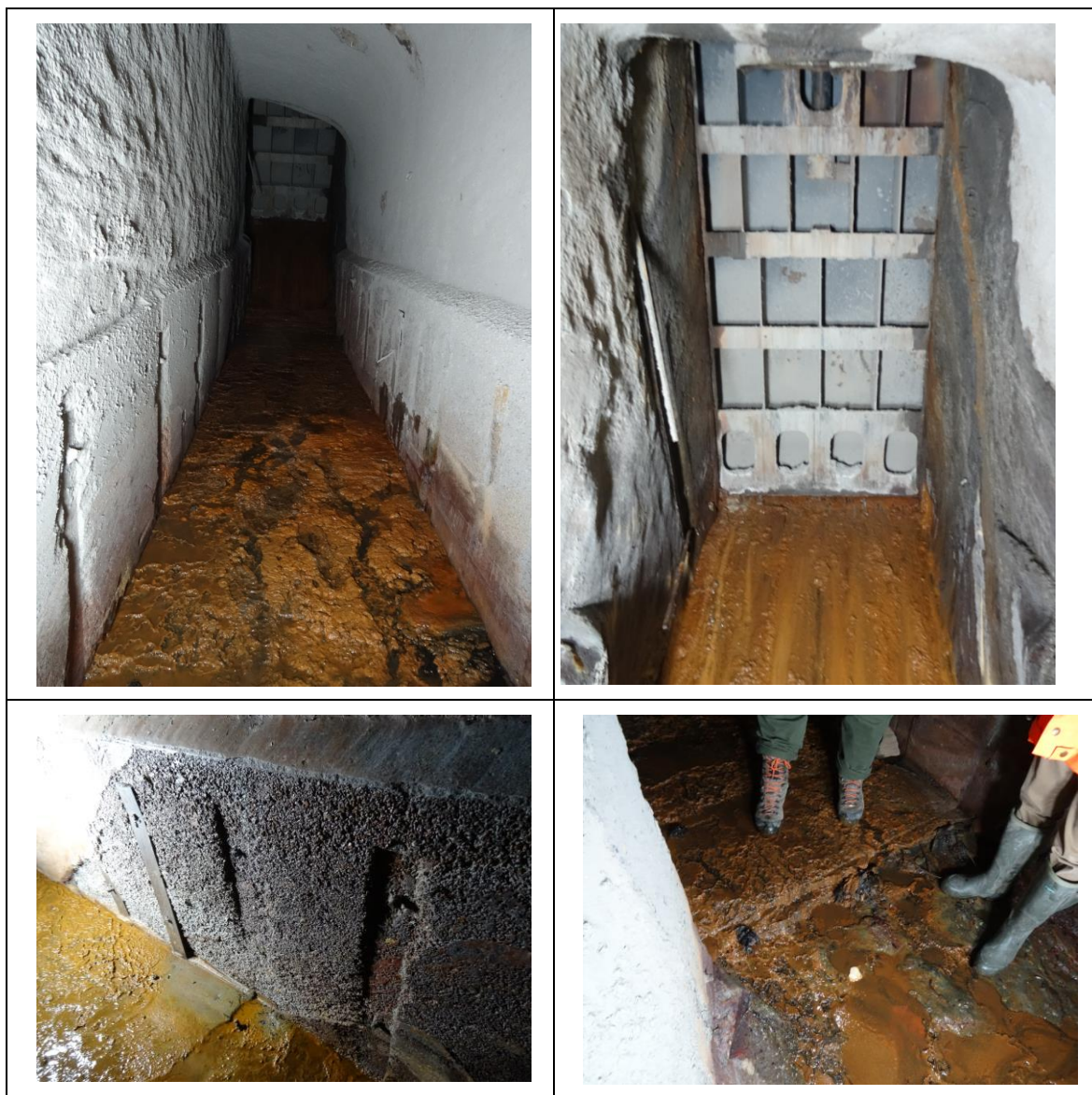
Figura 2-5: Cunicoli nel segmento di galleria a valle delle paratoie, con evidenza dei danni alle blindature (sopralluogo del 09.03.2021)
