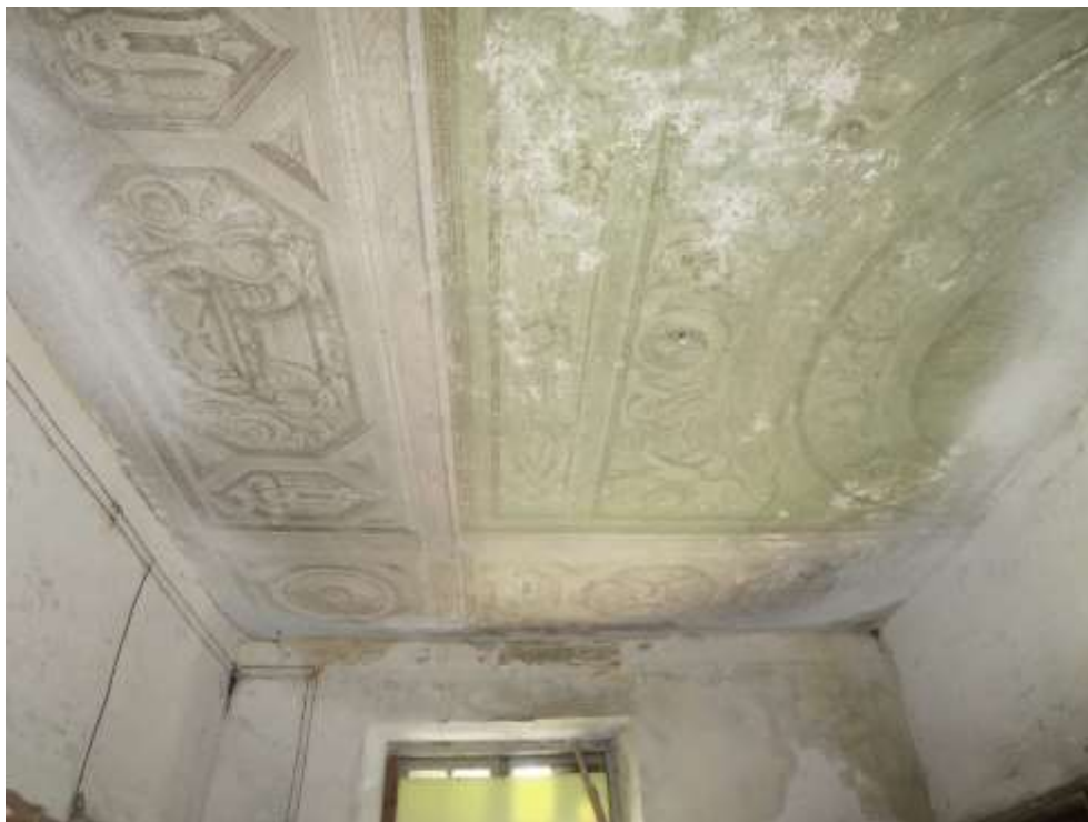
Figura 3-8:--Elementi di pregio presenti nei controsoffitti del piano primo all'interno del vano n°5
