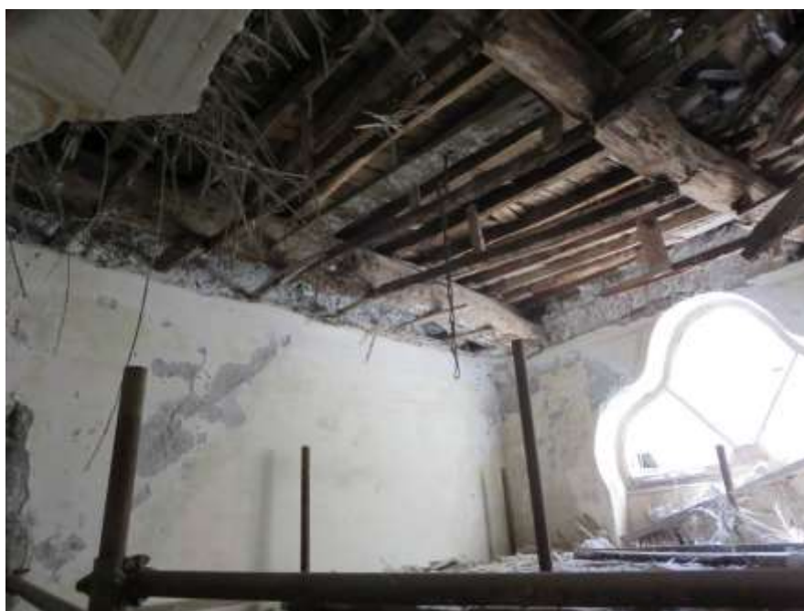
Figura 6-13. PUNTELLAZIONE SOLAI DANNEGGIATI – stato di fatto del solaio nel vano 16 al piano primo
