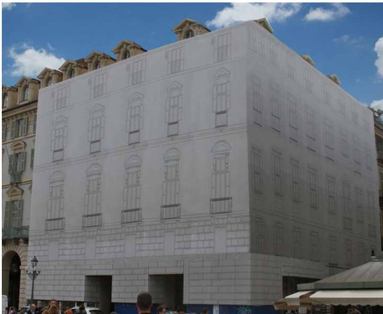
Figura 6-7. PONTEGGIO ESTERNO – Esempio di ponteggio con telo stampato con i prospetti principali dell'edificio
