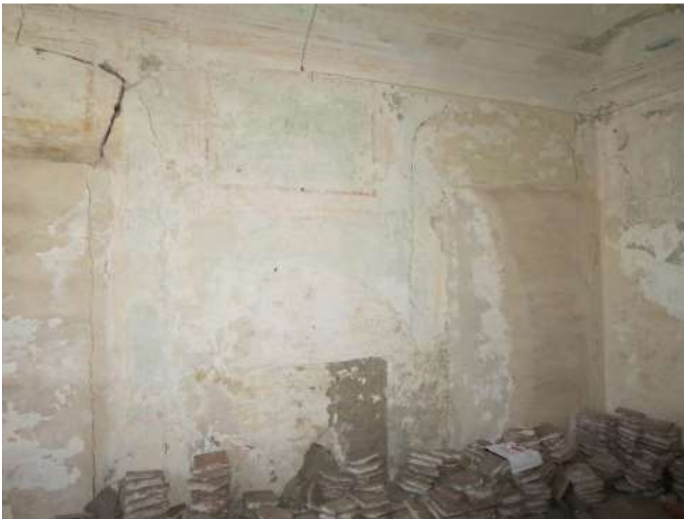
Figura 3-12:--Presenza di muffe e infiltrazioni nei controsoffitti del piano primo all'interno del vano n°6
