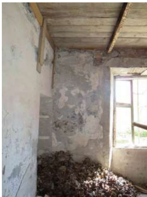
Figura 6-5. RIMOZIONE MATERIALE PRESENTE – Esempio di vano con all'interno materiale da rimuovere (vano 14)
