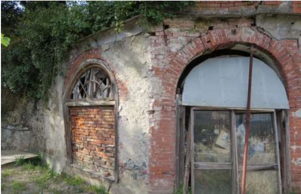
Figura 2-15: SERRA - Vista esterna dei crolli presenti nell'edificio denominato "SERRA"
