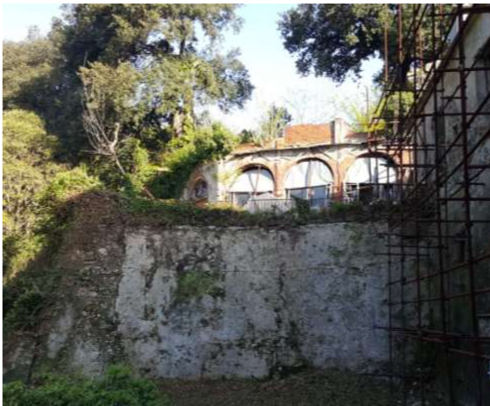
Figura 6-16. MURO CONTROTERRA – Immagine muro controterra esistente
