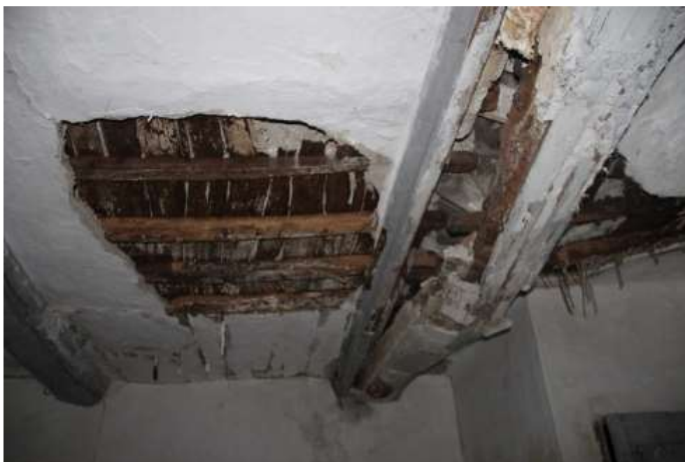
Figura 2-13: ANNESSO RUSTICO - Vista interna dal piano terra della porzione di solaio crollato
