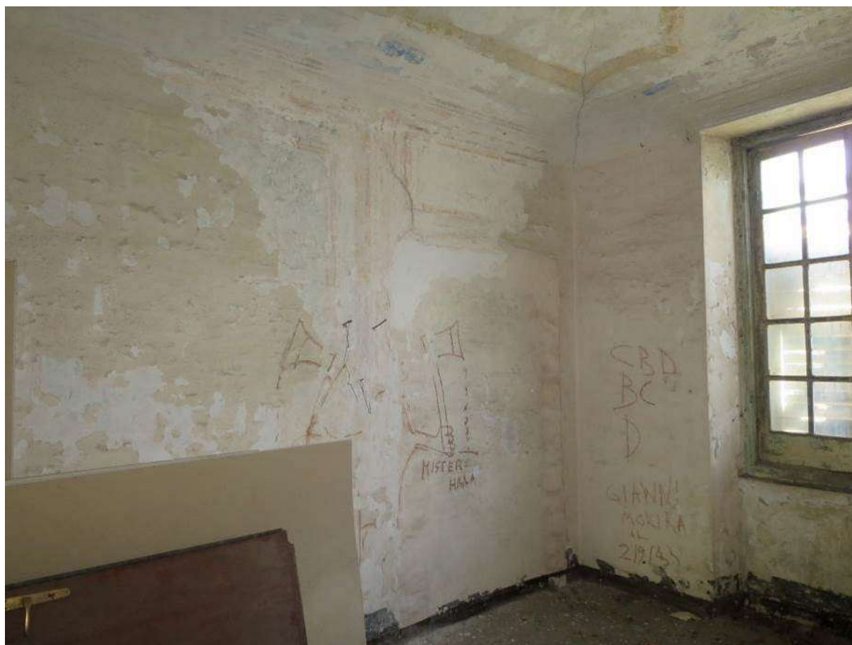
Figura 4-134. PALAZZO PARETO – P1 - Vano 11 – Parete D
