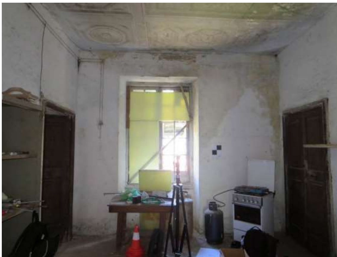
Figura 4-100. PALAZZO PARETO – P1 - Vano 5 – Parete A
