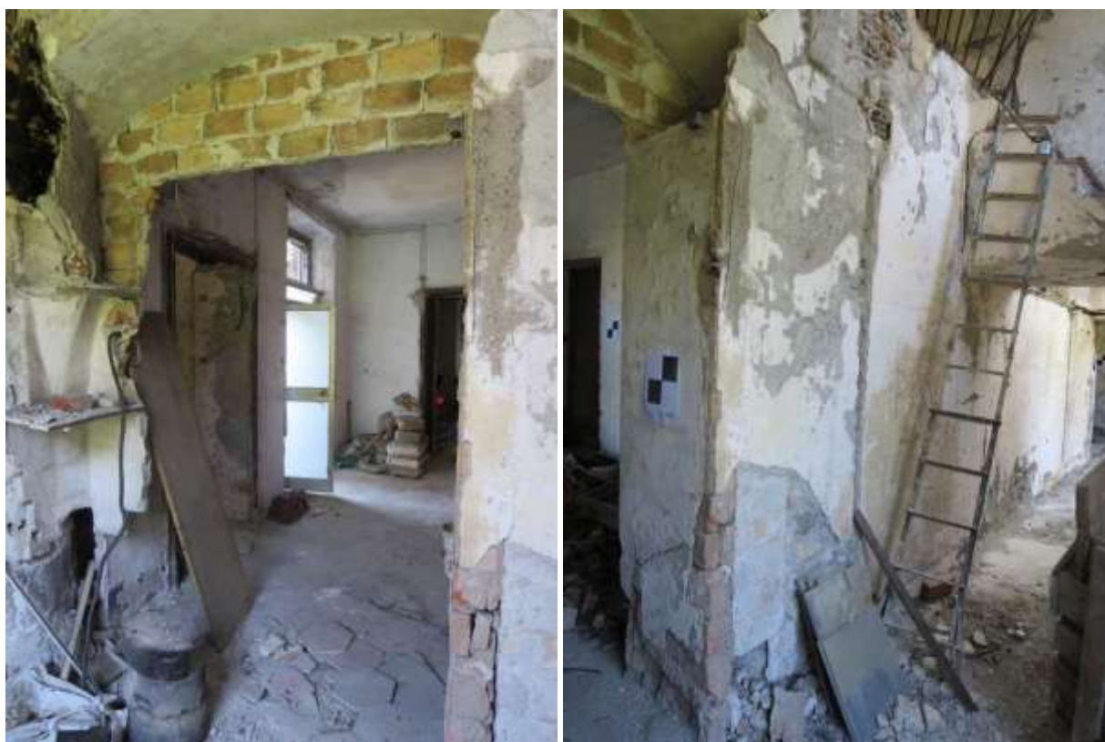
Figura 4-90. PALAZZO PARETO – P1 - Vano 3" – Parete A
