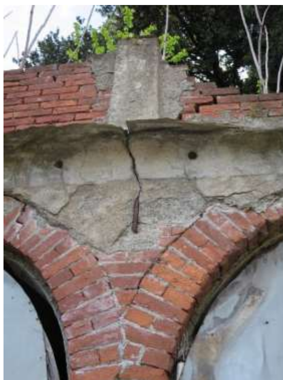
Figura 5-10. SERRA – Particolare incatenamento esistente
