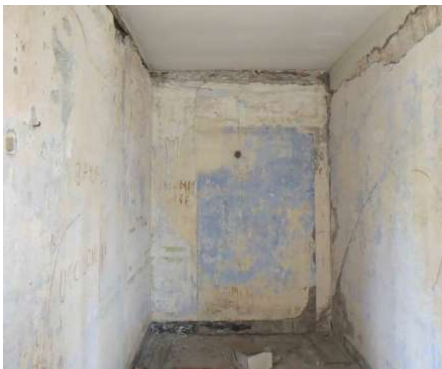
Figura 4-124. PALAZZO PARETO – P1 - Vano 9 – Parete D
