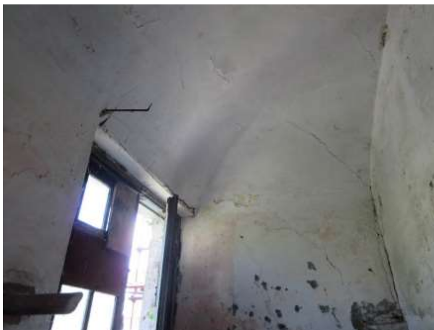
Figura 4-137. PALAZZO PARETO – P1 - Vano 12 – Pareti D, A e soffitto
