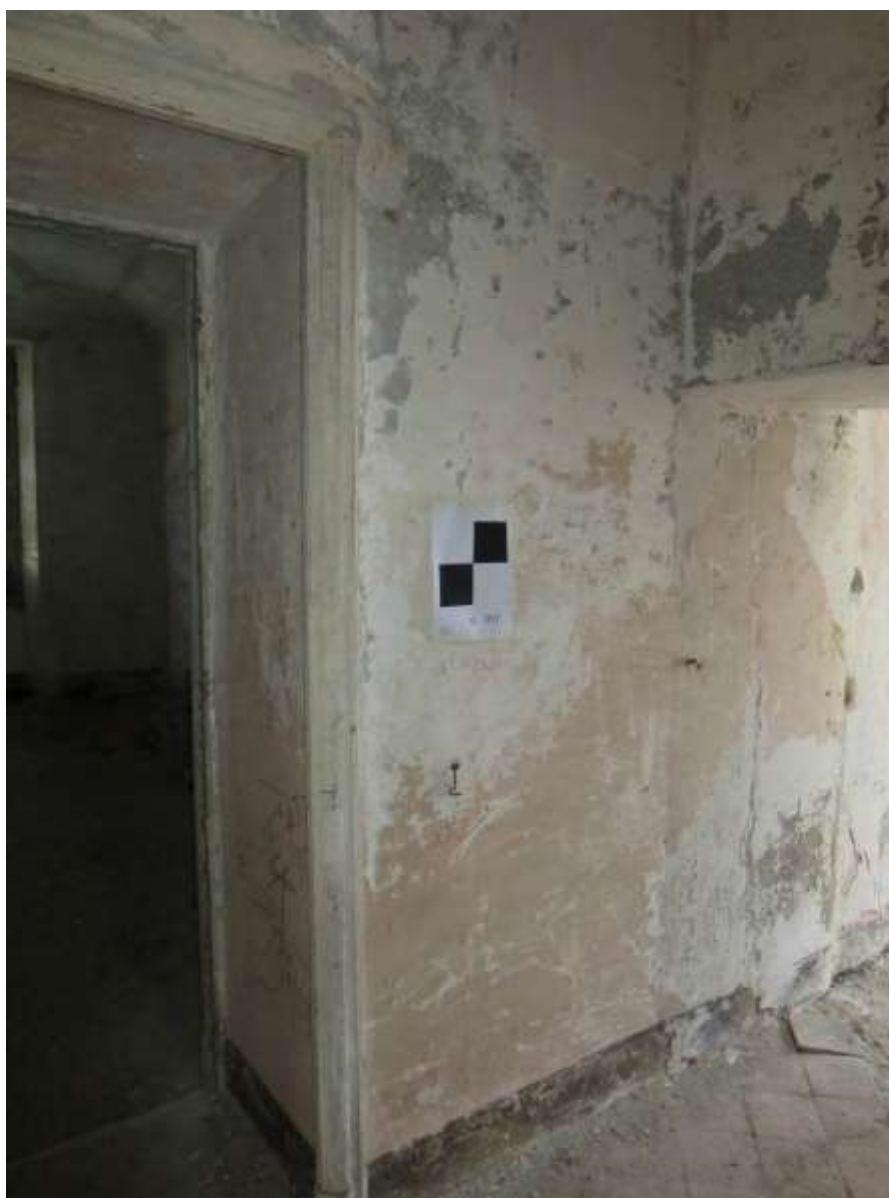
Figura 4-141. PALAZZO PARETO – P1 - Vano 13 – Parete A
