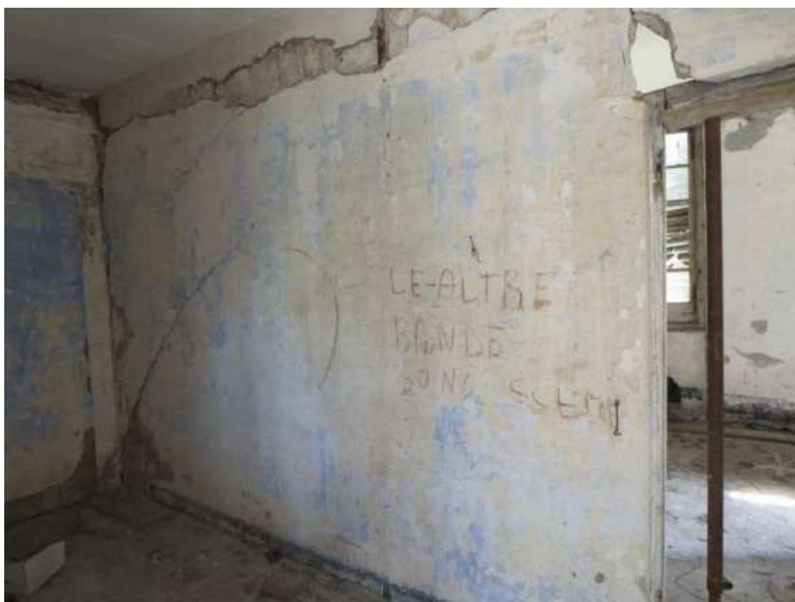
Figura 4-120. PALAZZO PARETO – P1 - Vano 9 – Parete A
