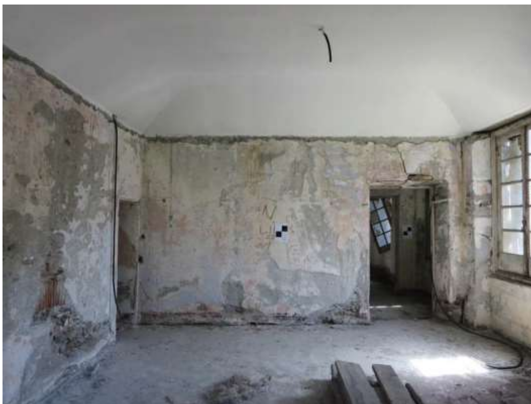
Figura 4-115. PALAZZO PARETO – P1 - Vano 8 – Parete A
