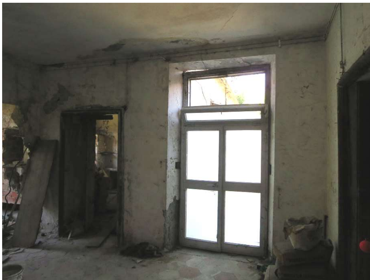
Figura 4-113. PALAZZO PARETO – P1 - Vano 7 – Parete D
