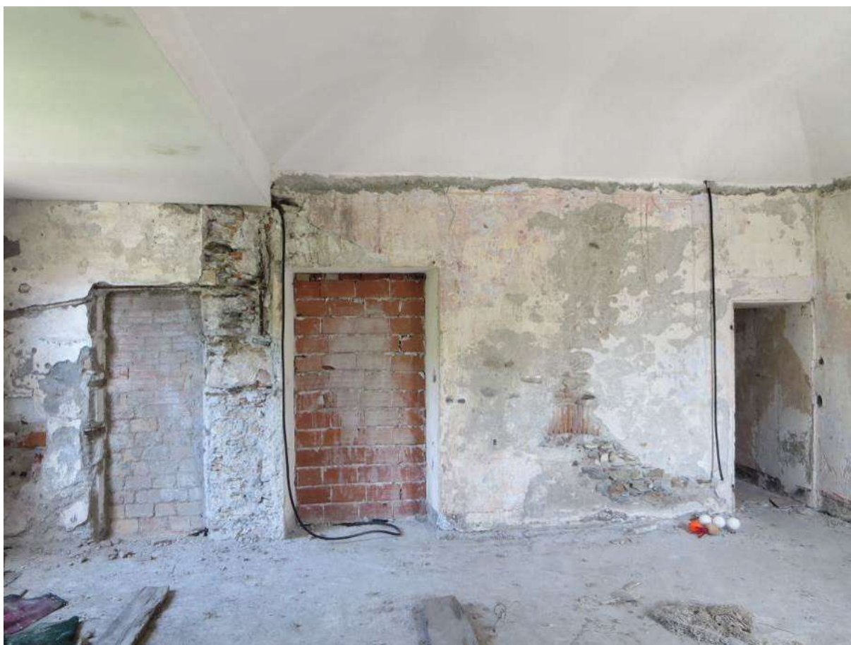
Figura 4-118. PALAZZO PARETO – P1 - Vano 8 – Parete D
