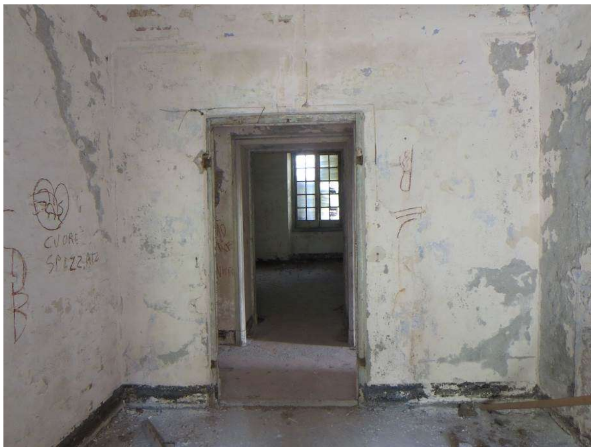
Figura 4-146. PALAZZO PARETO – P1 - Vano 14 – Parete A
