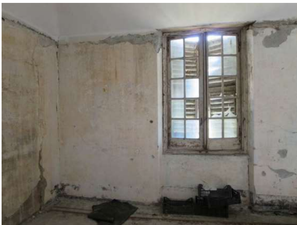
Figura 4-126. PALAZZO PARETO – P1 - Vano 10 – Parete A
