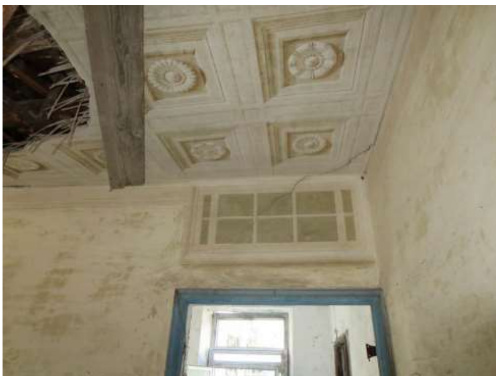
Figura 4-164. PALAZZO PARETO – P1 - Vano 16 – Parete D
