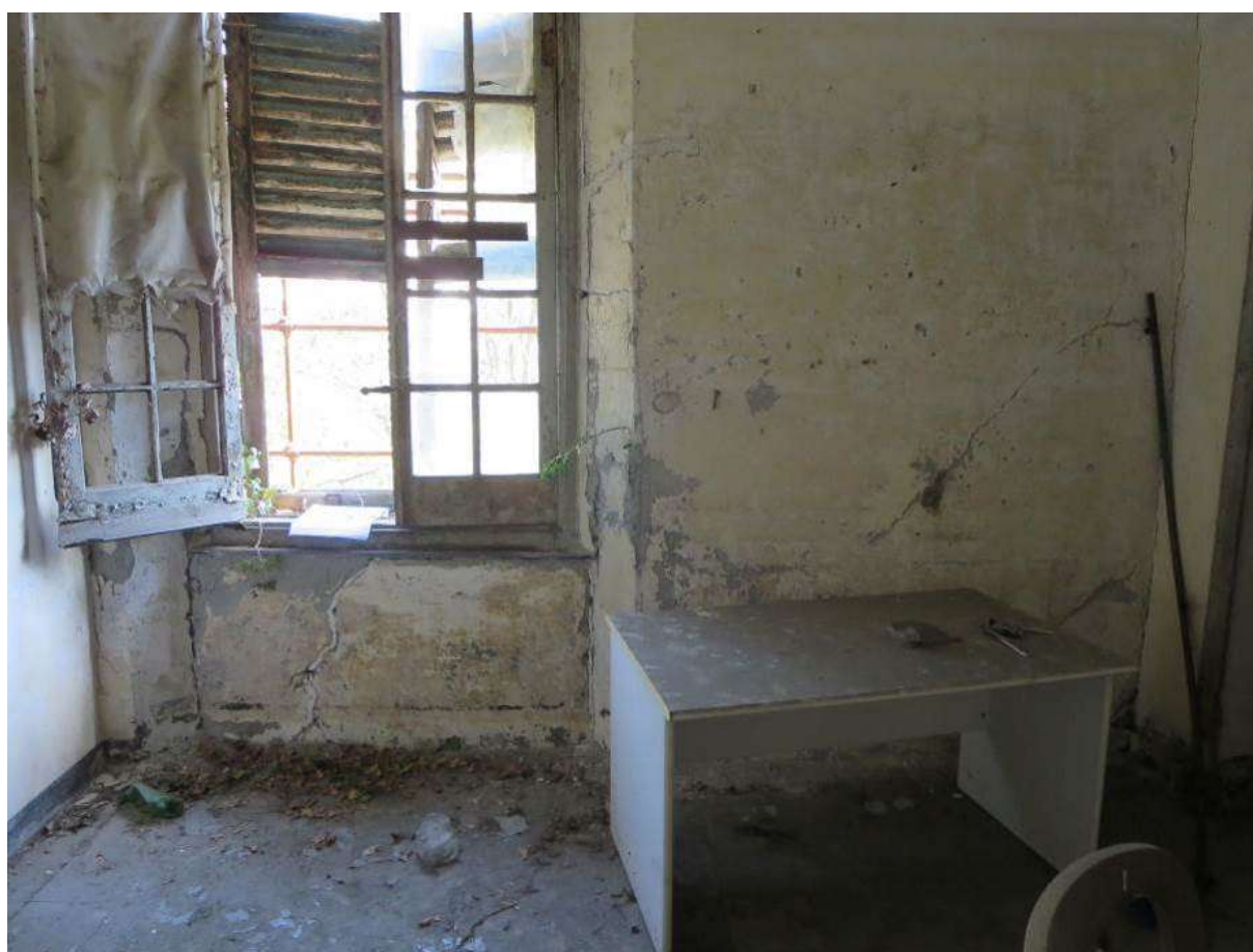
Figura 4-95. PALAZZO PARETO – P1 - Vano 4 – Parete A
