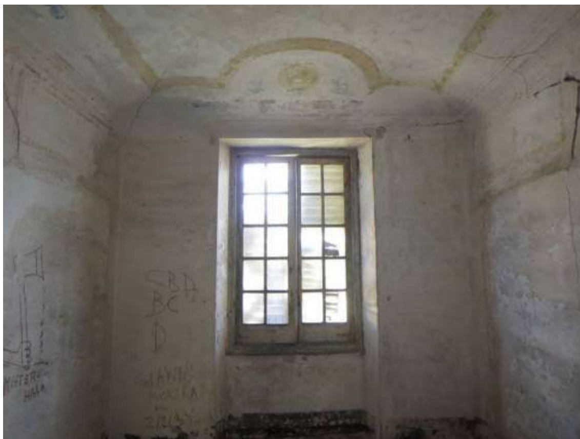
Figura 4-131. PALAZZO PARETO – P1 - Vano 11 – Parete A
