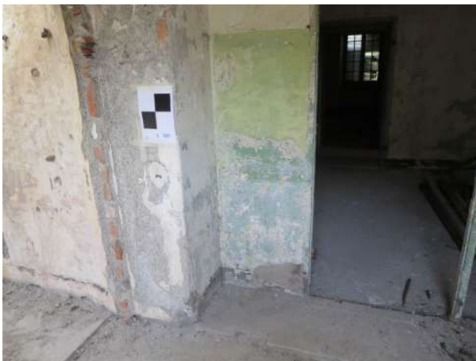
Figura 4-152. PALAZZO PARETO – P1 - Vano 15 – Parete A
