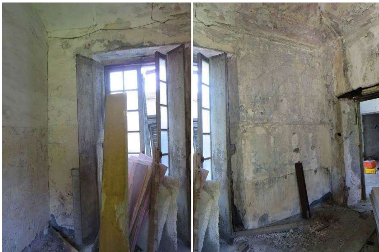
Figura 4-80. PALAZZO PARETO – P1 - Vano 2 – Parete A
