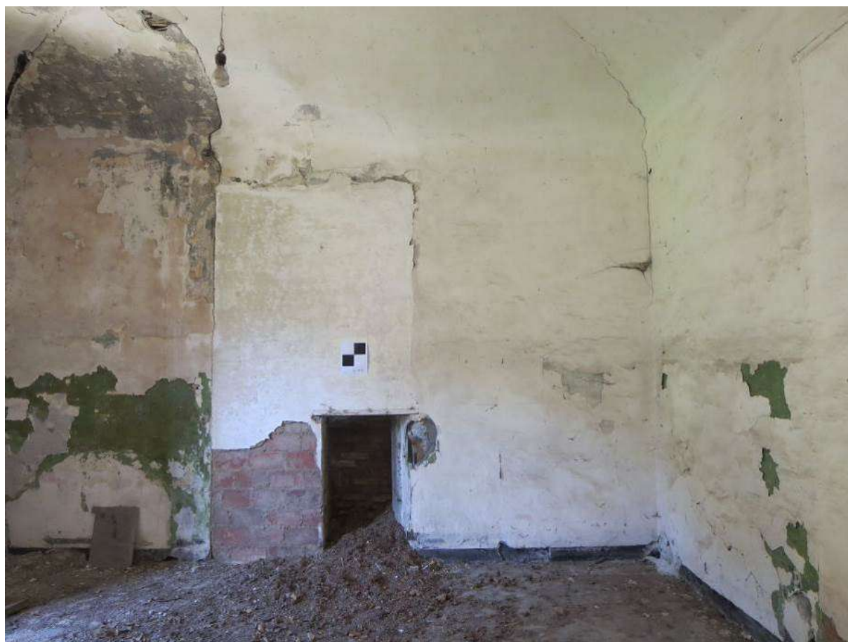
Figura 4-78. PALAZZO PARETO – P1 - Vano 1 – Parete D
