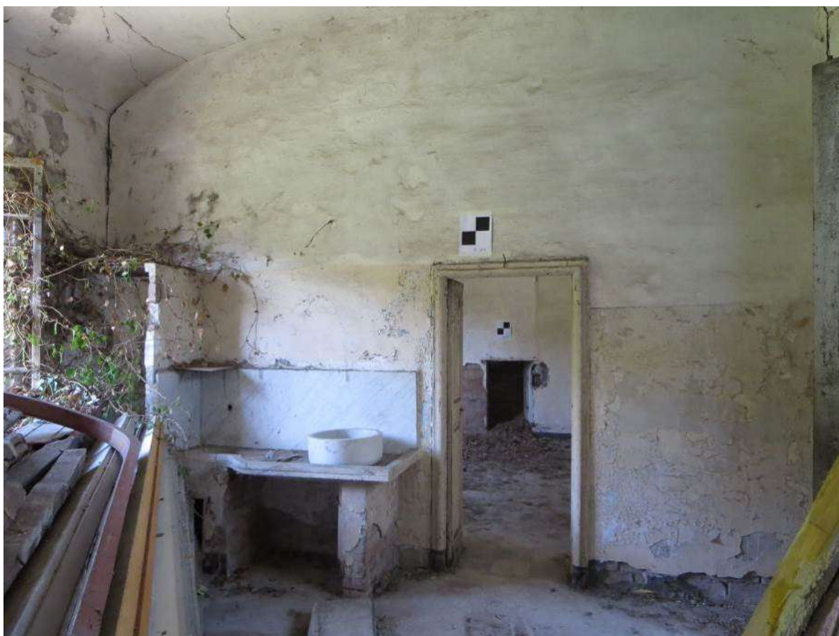
Figura 4-83. PALAZZO PARETO – P1 - Vano 2 – Parete D
