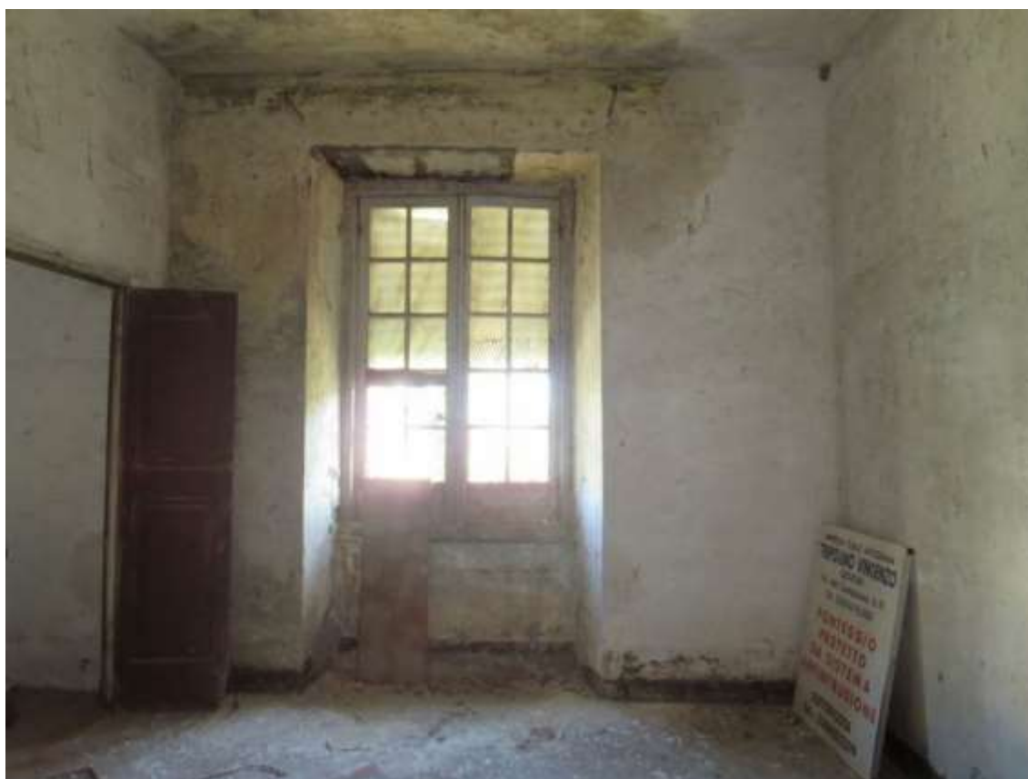
Figura 4-105. PALAZZO PARETO – P1 - Vano 6 – Parete A
