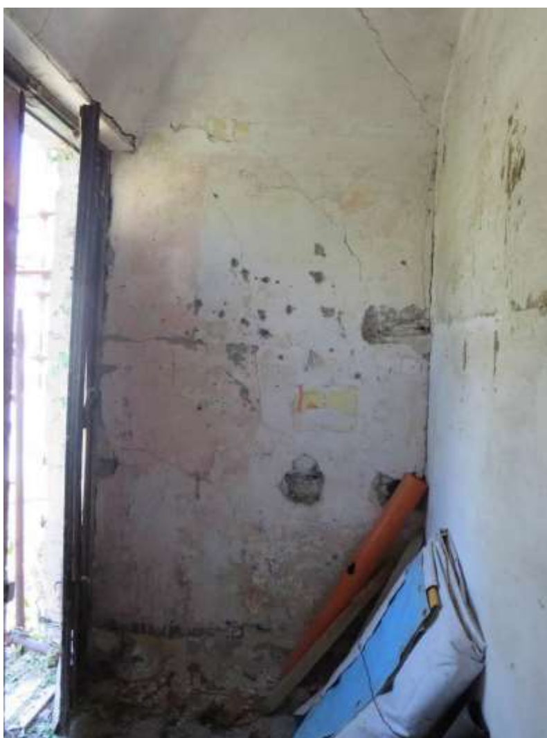
Figura 4-136. PALAZZO PARETO – P1 - Vano 12 – Parete A
