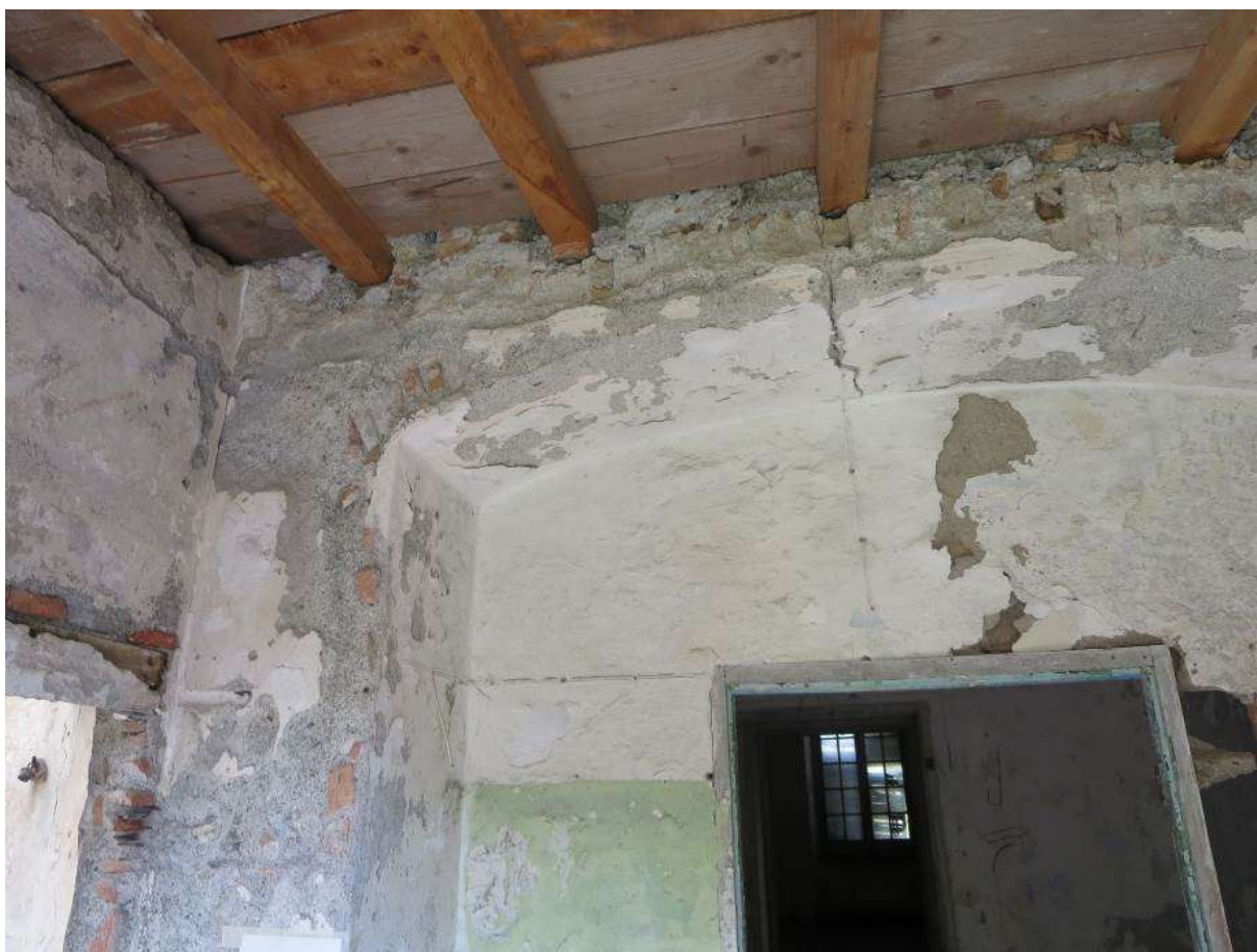
Figura 4-151. PALAZZO PARETO – P1 - Vano 15 – Parete A
