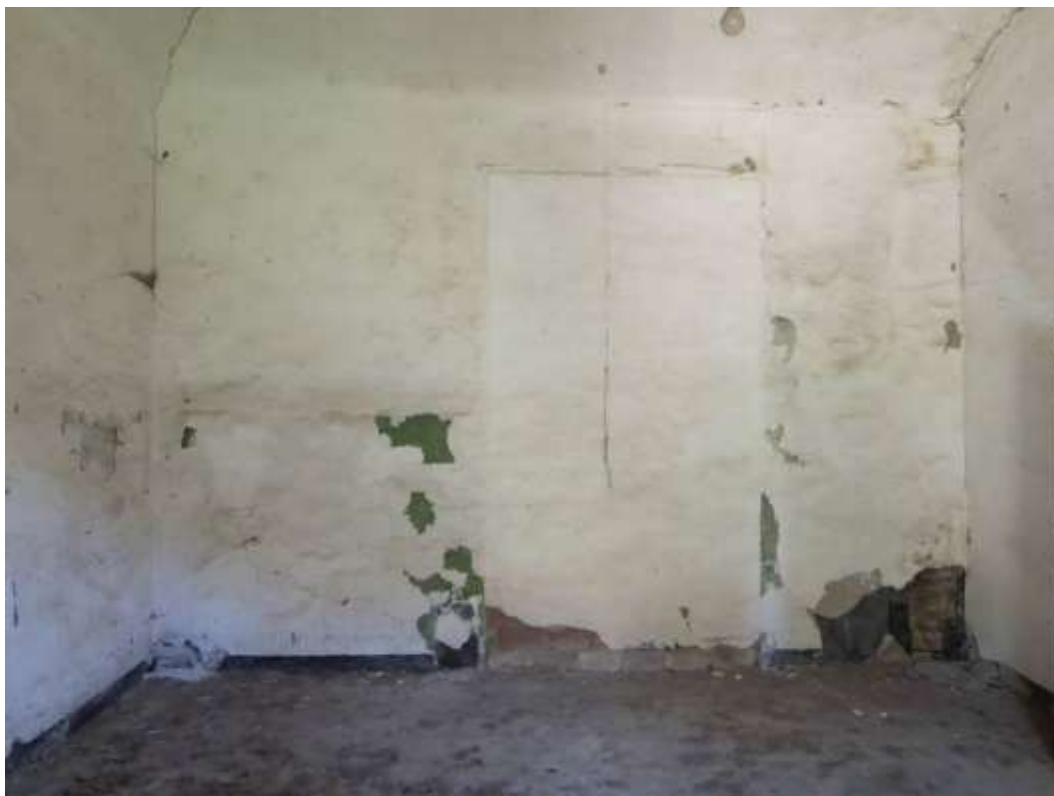
Figura 4-75. PALAZZO PARETO – P1 - Vano 1 – Parete A
