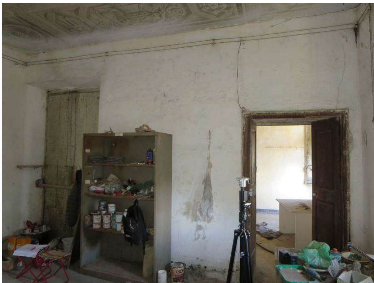
Figura 4-103. PALAZZO PARETO – P1 - Vano 5 – Parete D
