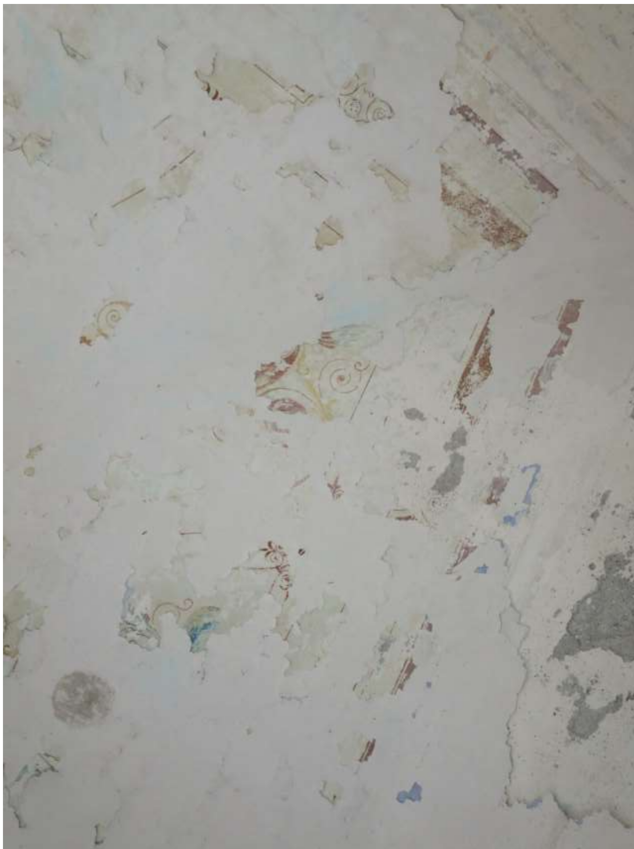
Figura 4-195. PALAZZO PARETO – P1 - Vano 14 – Resti di decorazioni a Soffitto
