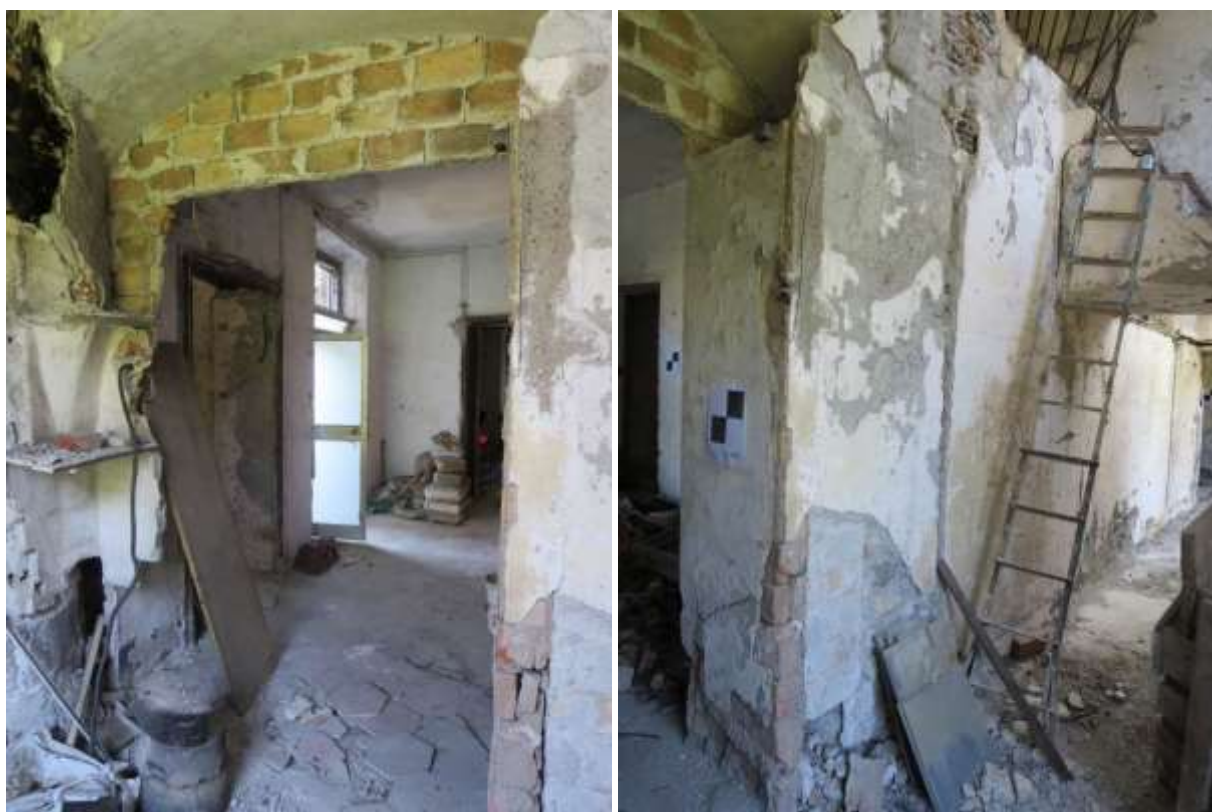
Figura 4-117. PALAZZO PARETO – P1 - Vano 3" – Parete A
