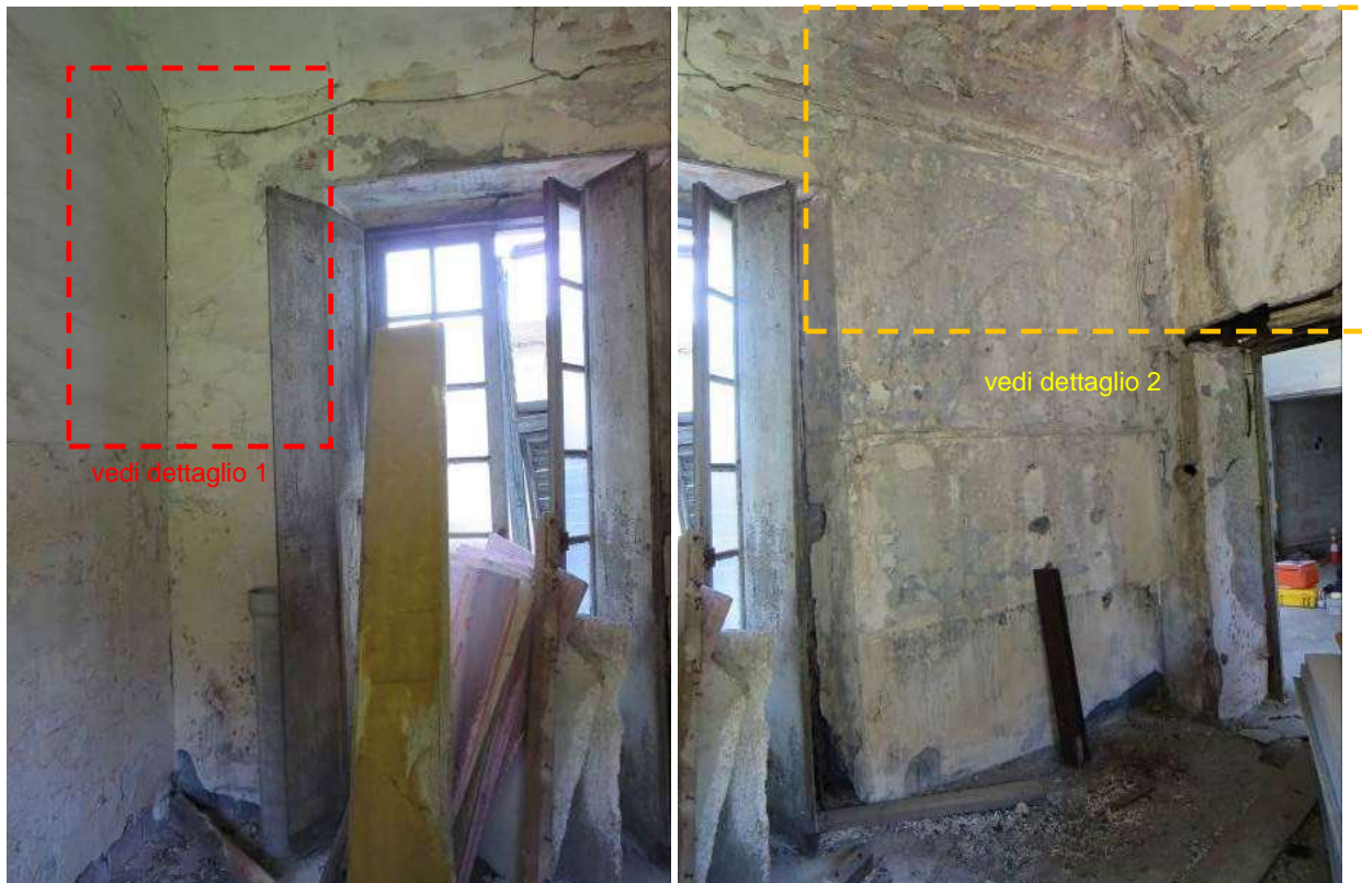
Figura 4-105. PALAZZO PARETO – P1 - Vano 2 – Parete A
