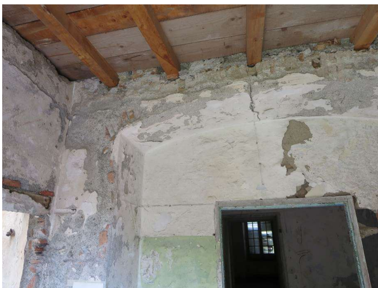
Figura 4-198. PALAZZO PARETO – P1 - Vano 15 – Parete A
