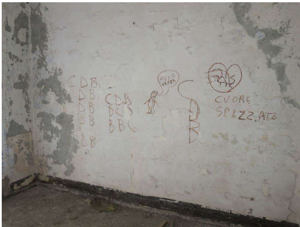
Figura 4-192. PALAZZO PARETO – P1 - Vano 14 – Parete D
