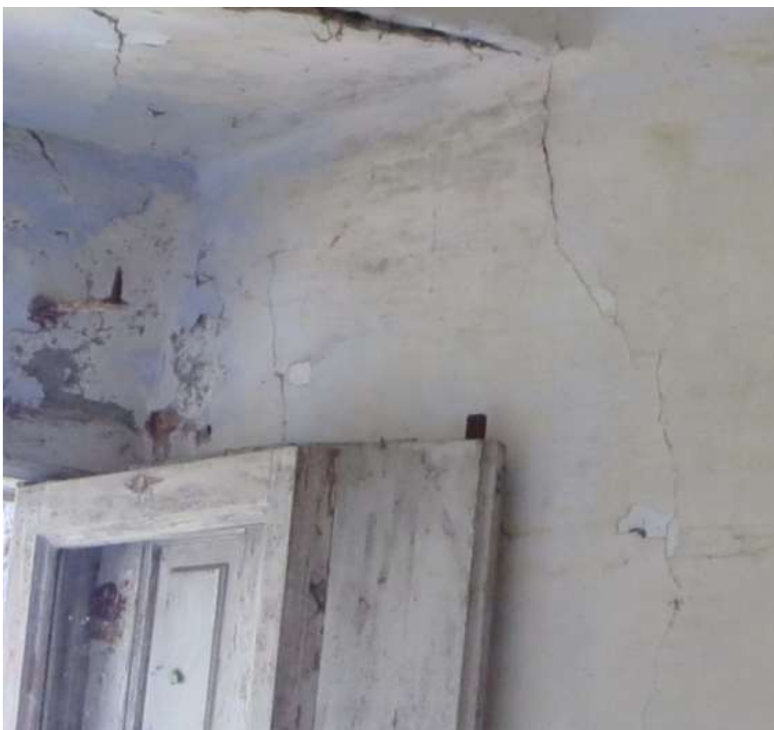
Figura 4-29. PALAZZO PARETO – PT - Vano 4 – Dettaglio 1 fessure Parete A
