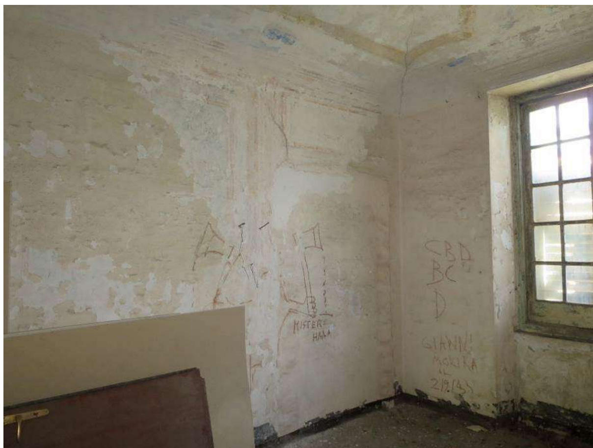
Figura 4-176. PALAZZO PARETO – P1 - Vano 11 – Parete D
