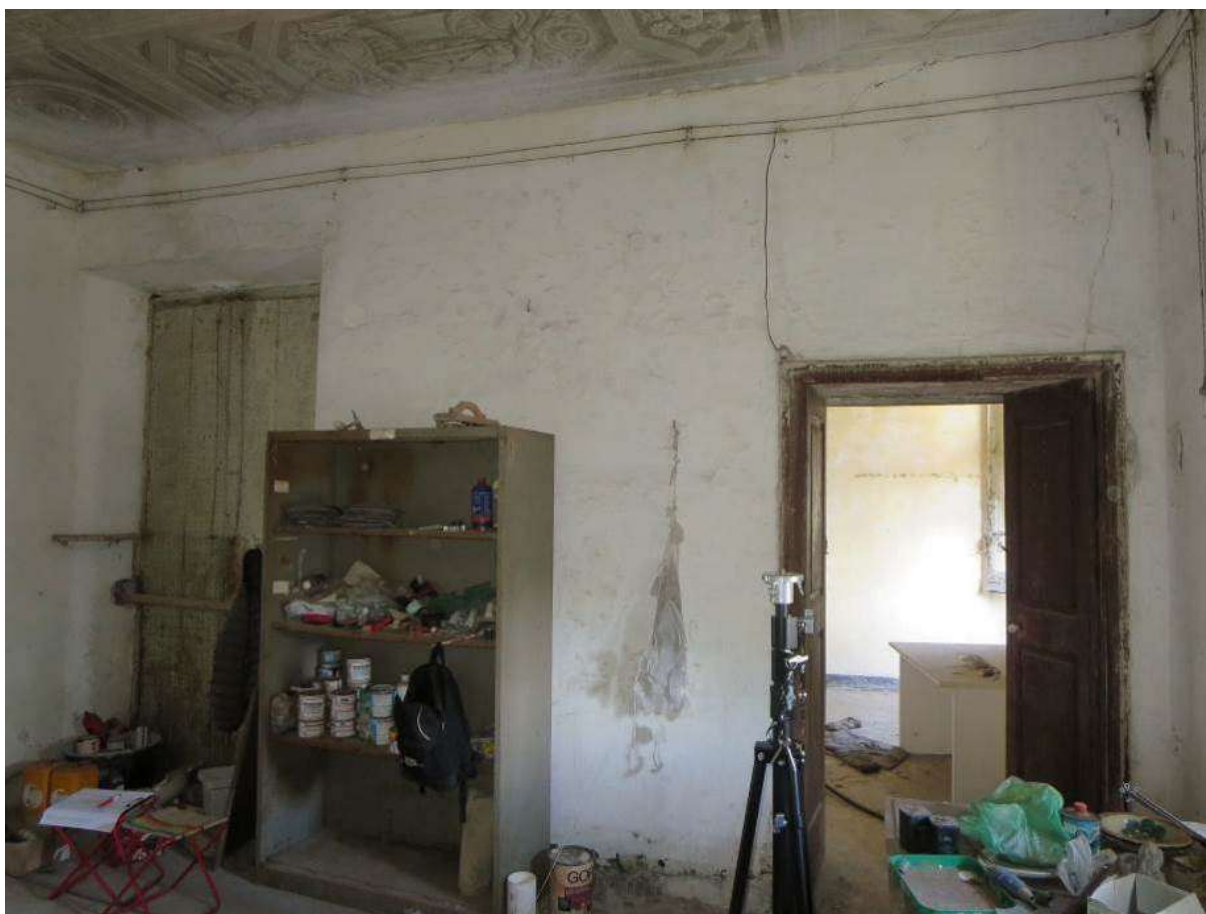
Figura 4-132. PALAZZO PARETO – P1 - Vano 5 – Parete D
