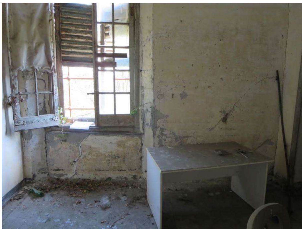
Figura 4-122. PALAZZO PARETO – P1 - Vano 4 – Parete A
