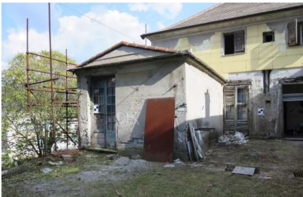
Figura 4-230. PALAZZO PARETO – Facciata nord
