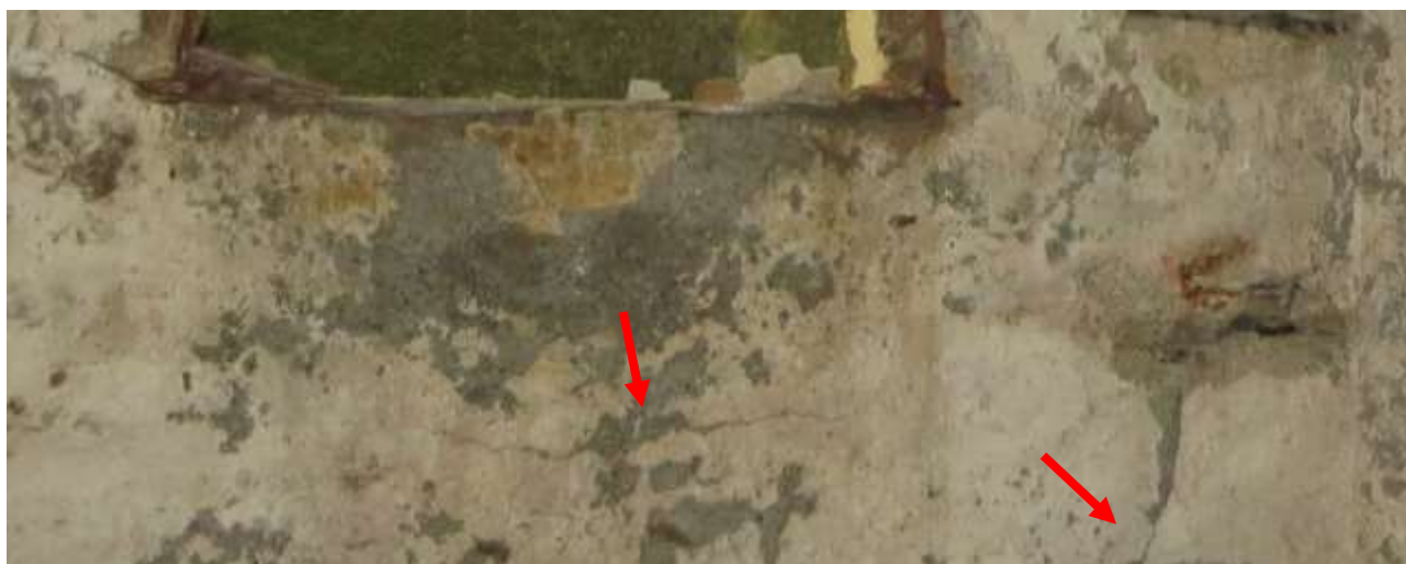
Figura 4-47. PALAZZO PARETO – PT - Vano 7 – Fessure su Parete D
