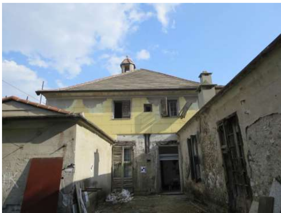
Figura 4-229. PALAZZO PARETO – Facciata nord
