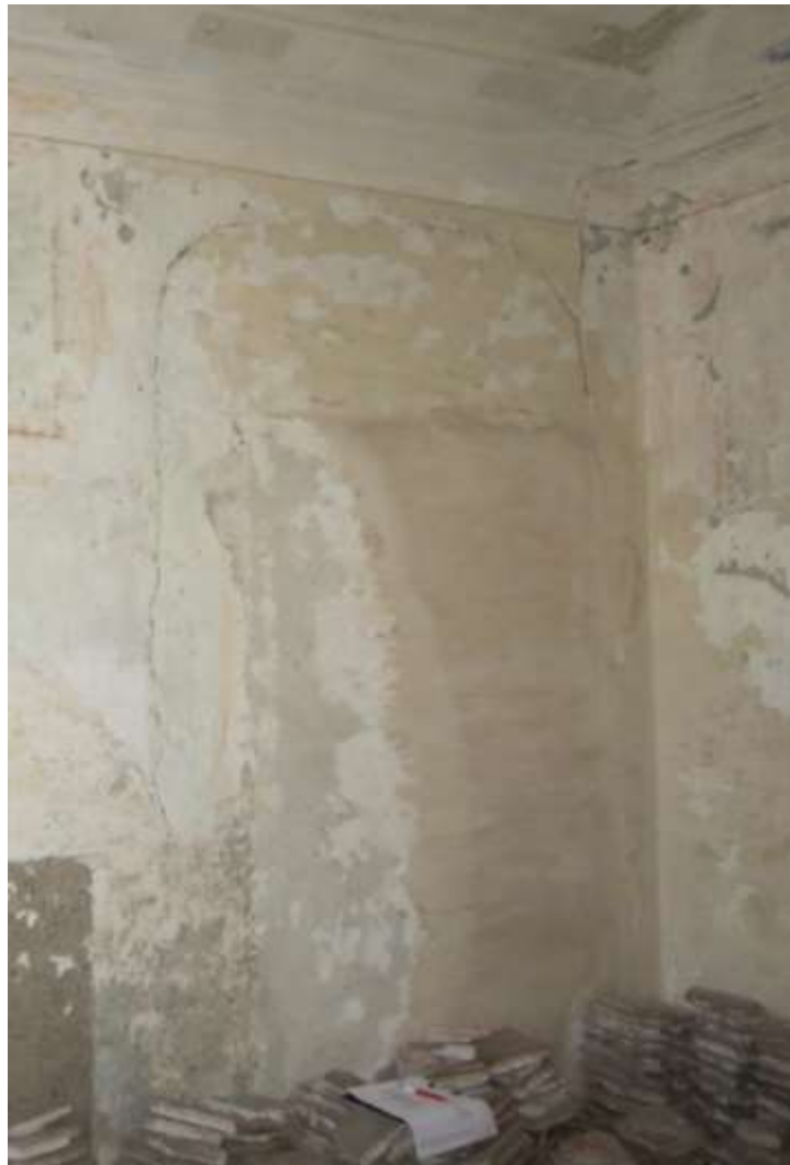
Figura 4-173. PALAZZO PARETO – P1 - Vano 11 – Dettaglio Parete B con porta di destra tamponata o nicchia tamponata
