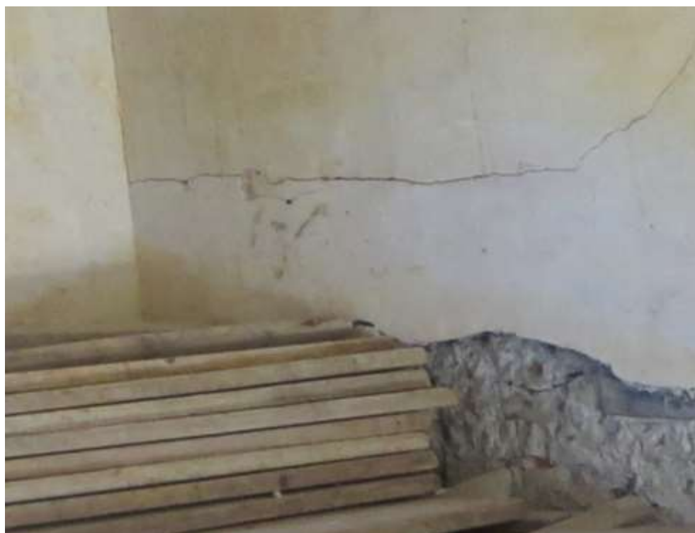
Figura 4-4. PALAZZO PARETO – PT - Vano 1 – Dettaglio fessura orizzontale/inclinata su Parete B
