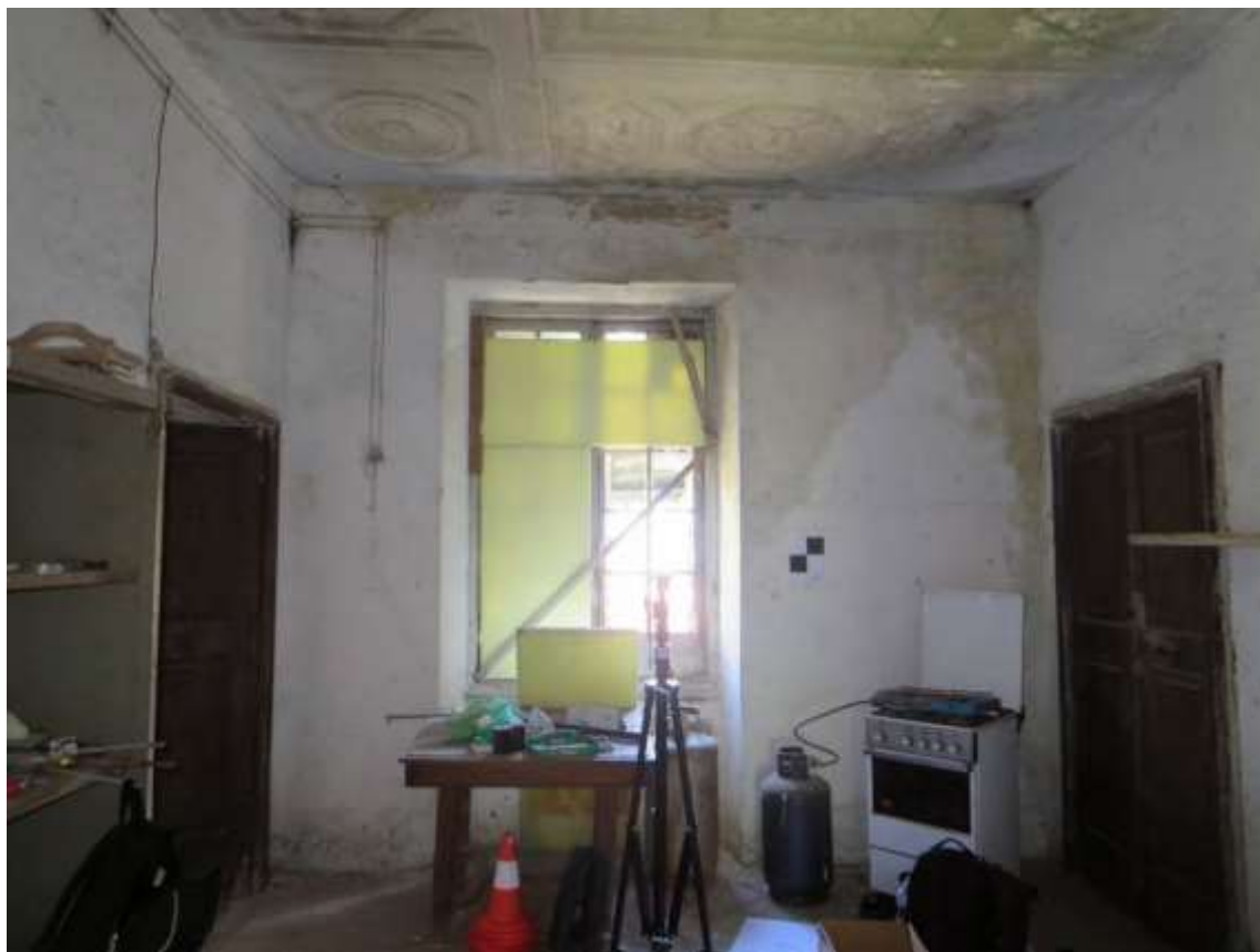
Figura 4-129. PALAZZO PARETO – P1 - Vano 5 – Parete A
