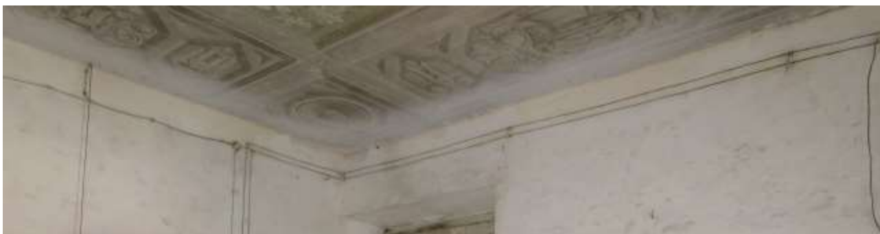
Figura 4-136. PALAZZO PARETO – P1 - Vano 5 – Soffitto (Angolo Parete C-D) con tracce di efflorescenze lungo i muri
