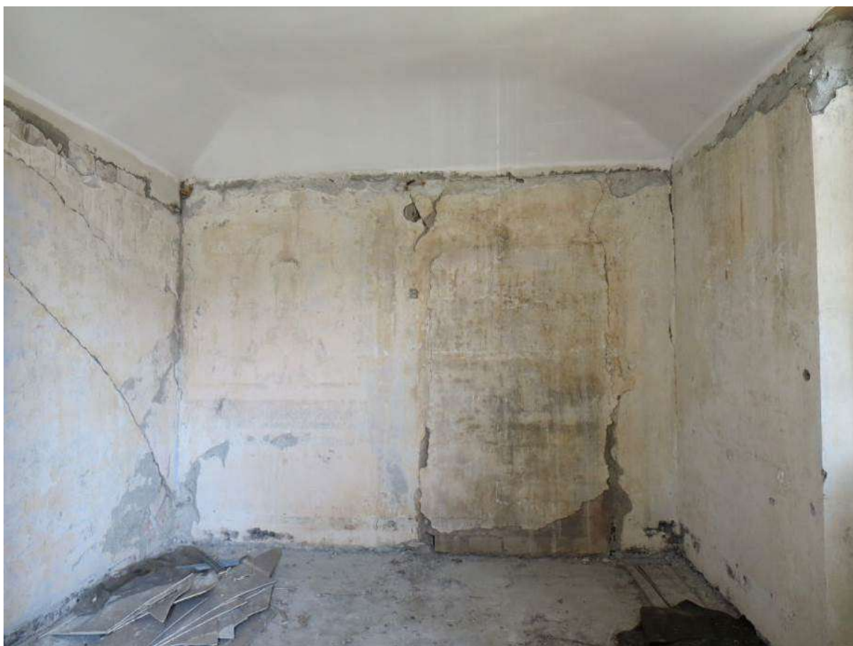
Figura 4-166. PALAZZO PARETO – P1 - Vano 10 – Parete D
