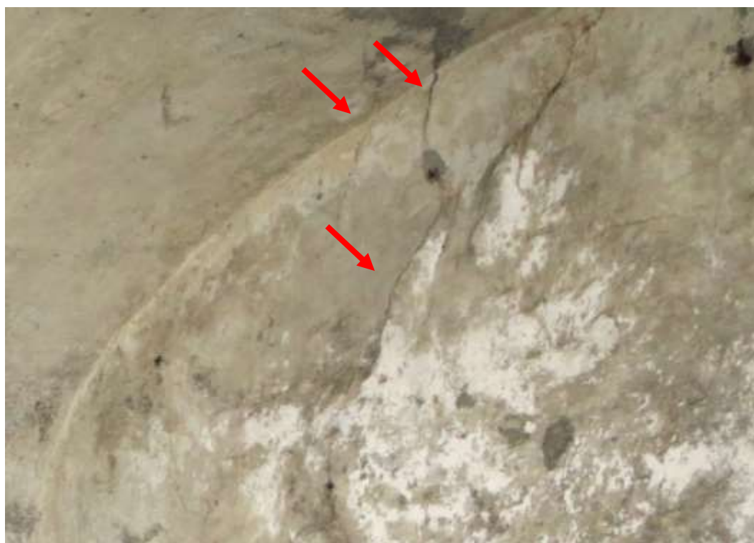
Figura 4-48. PALAZZO PARETO – PT - Vano 7 – Fessure su Parete B
