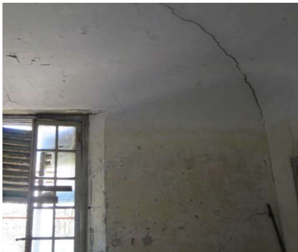
Figura 4-124. PALAZZO PARETO – P1 - Vano 4 – Fessura diagonale a soffitto na partire dal lato destro di Parete A
