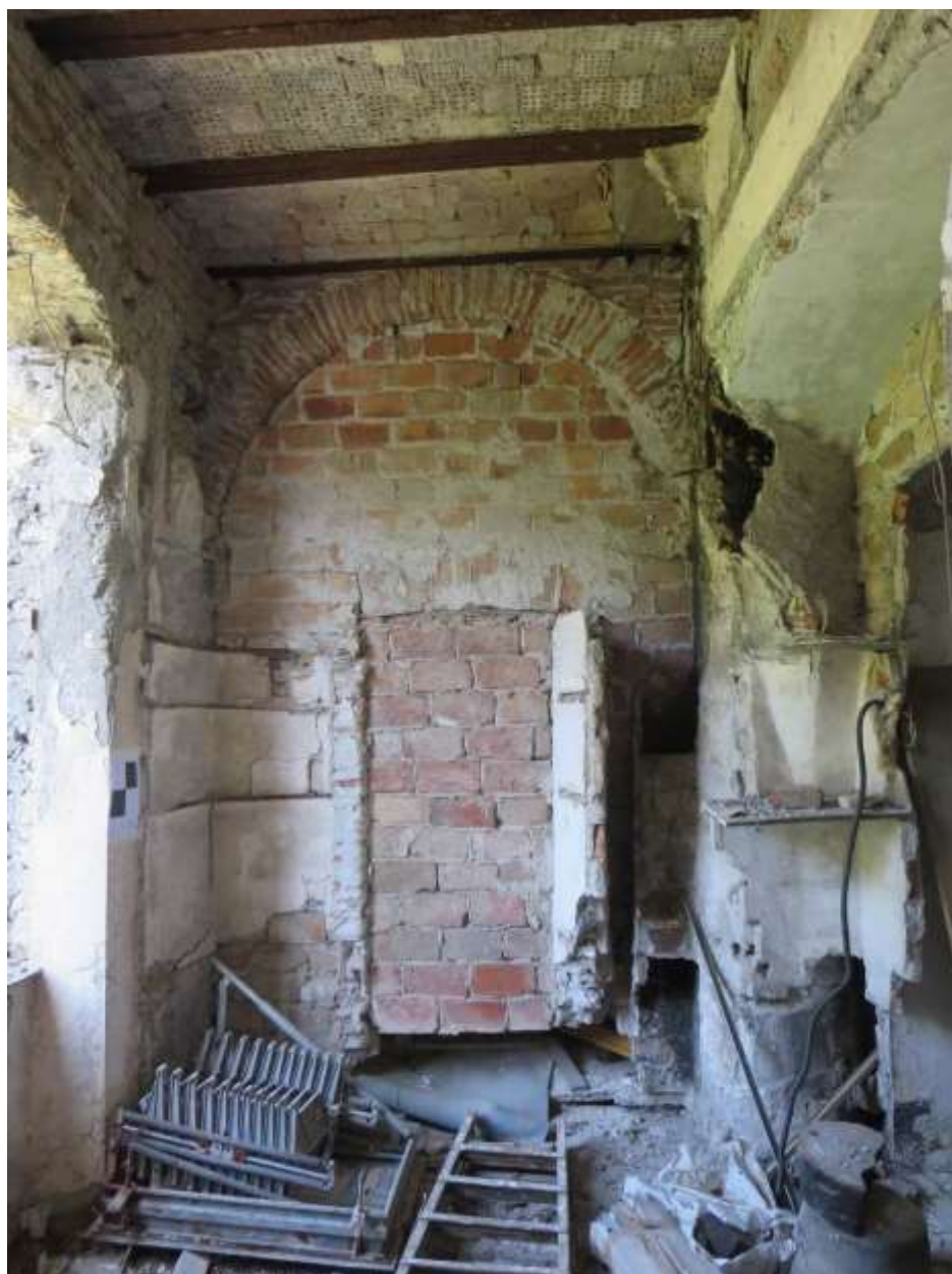
Figura 4-120. PALAZZO PARETO – P1 - Vano 3” – Parete D
