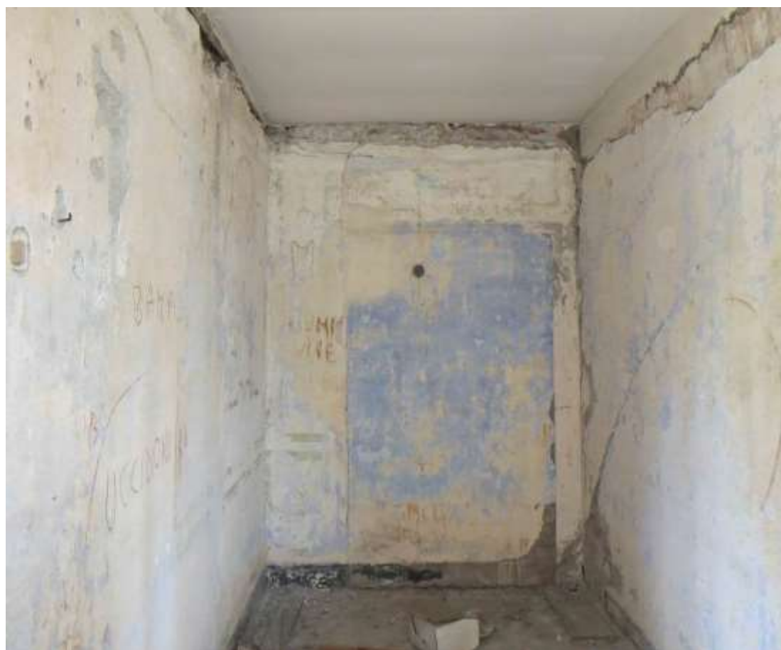
Figura 4-161. PALAZZO PARETO – P1 - Vano 9 – Parete D
