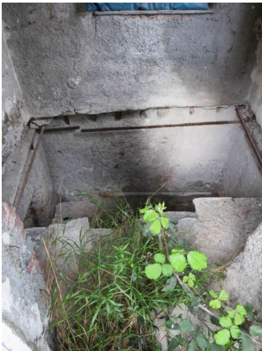
Figura 6-2. TORRETTA – Primo impalcato (crollato)
