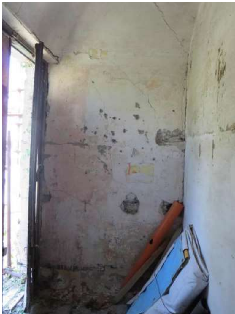
Figura 4-178. PALAZZO PARETO – P1 - Vano 12 – Parete A
