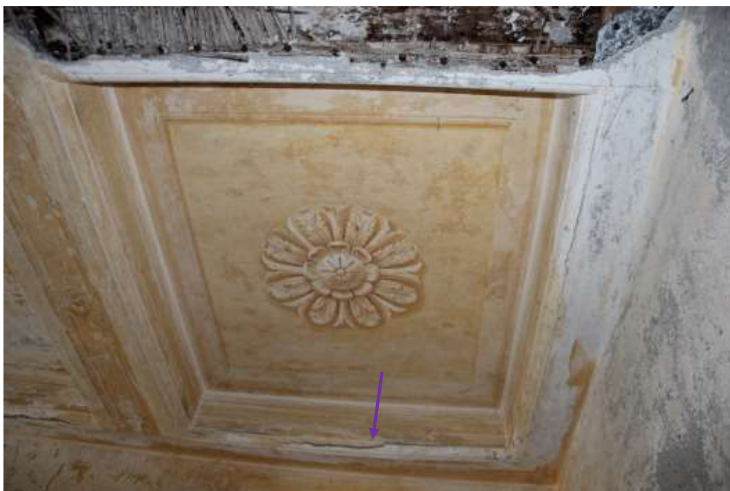
Figura 4-9. PALAZZO PARETO – PT - Vano 1 – Dettaglio 3 (fessure a soffitto sopra Parete C)
