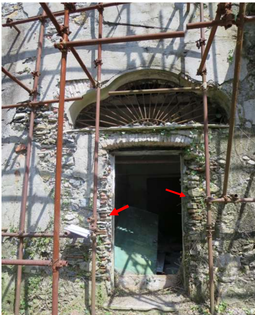
Figura 4-221. PALAZZO PARETO – Facciata ovest, particolare muratura attorno alla porta del Vano 11-PT
