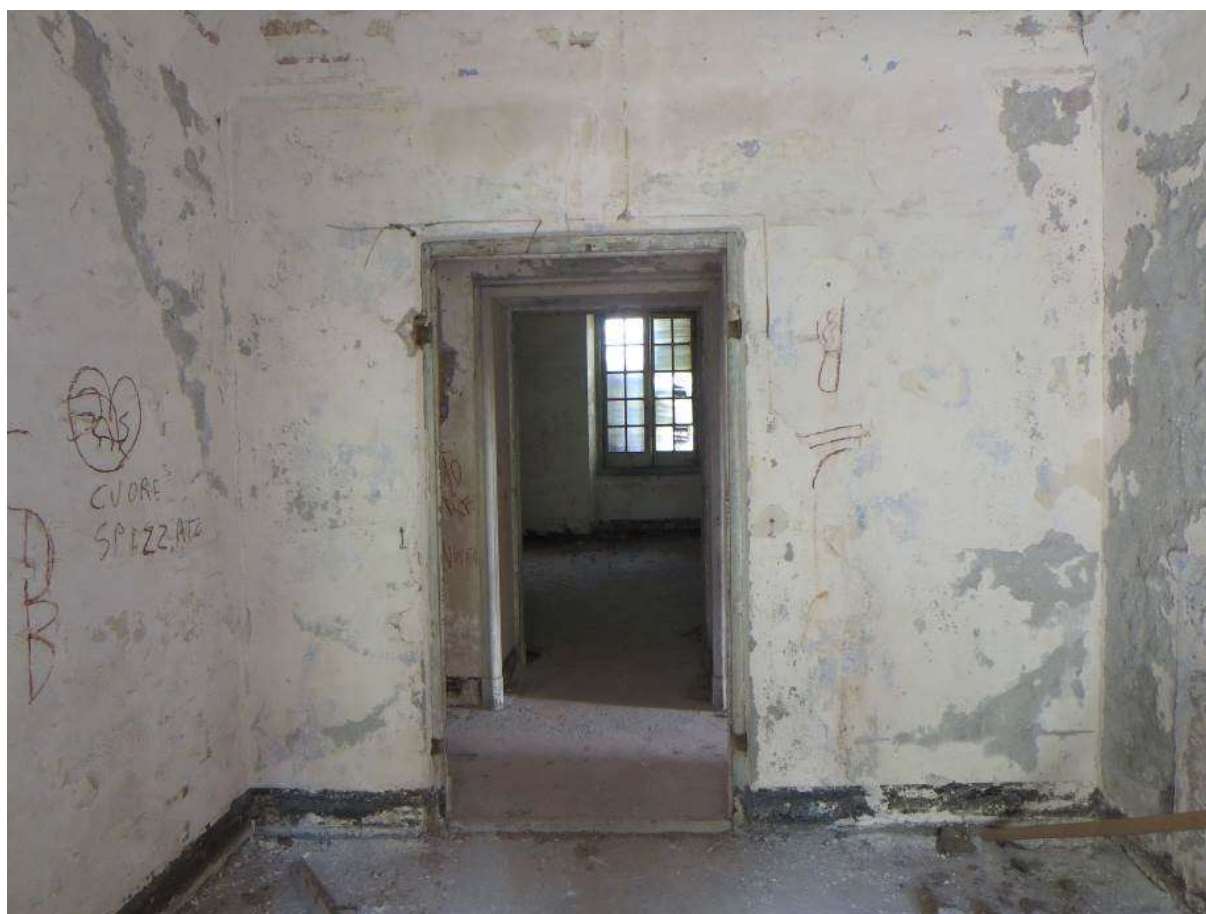
Figura 4-189. PALAZZO PARETO – P1 - Vano 14 – Parete A
