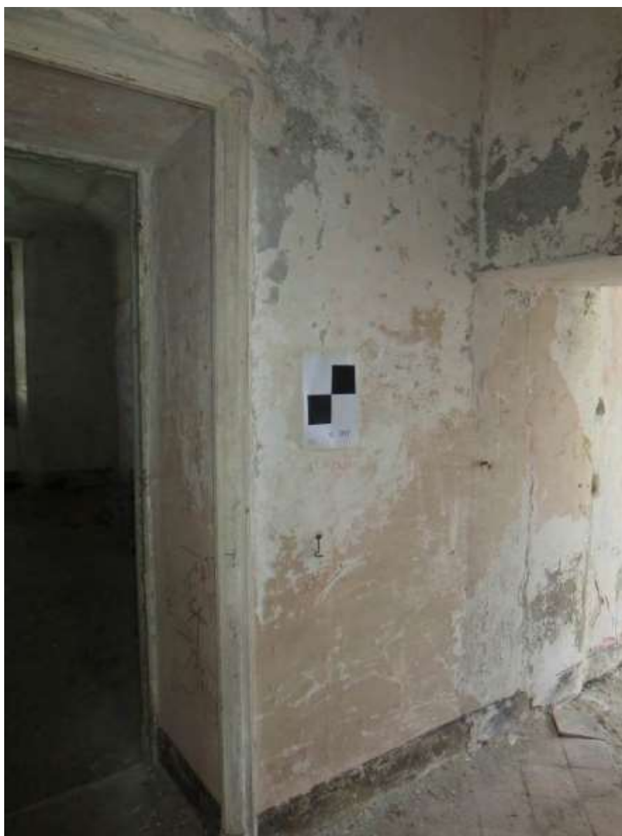
Figura 4-183. PALAZZO PARETO – P1 - Vano 13 – Parete A
