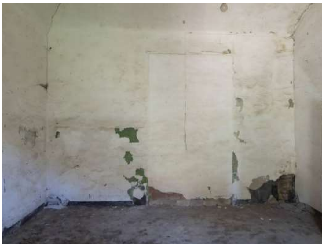
Figura 4-100. PALAZZO PARETO – P1 - Vano 1 – Parete A
