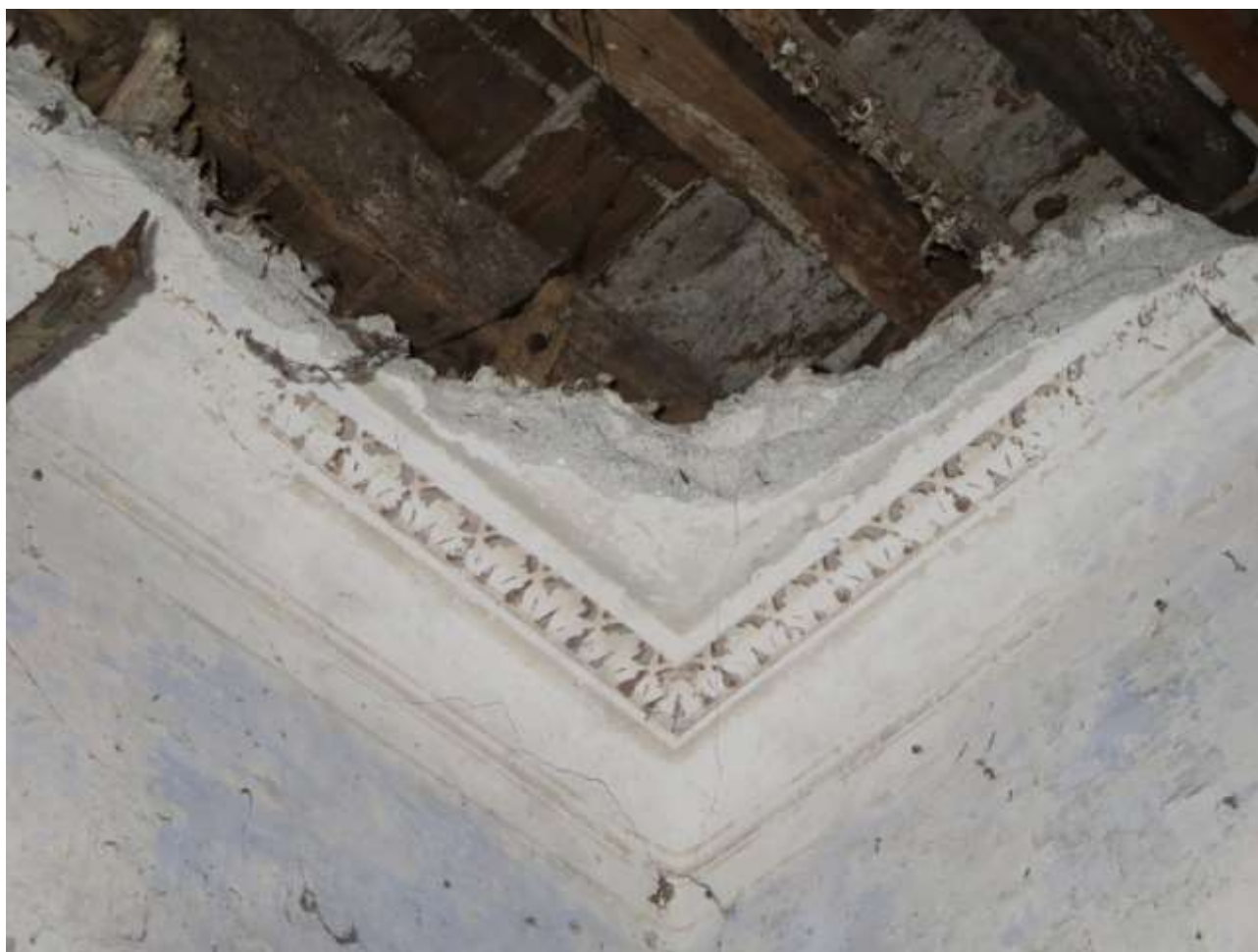
Figura 4-13. PALAZZO PARETO – PT - Vano 2 – Dettaglio 1 soffitto angolo Parete A-Parete B
