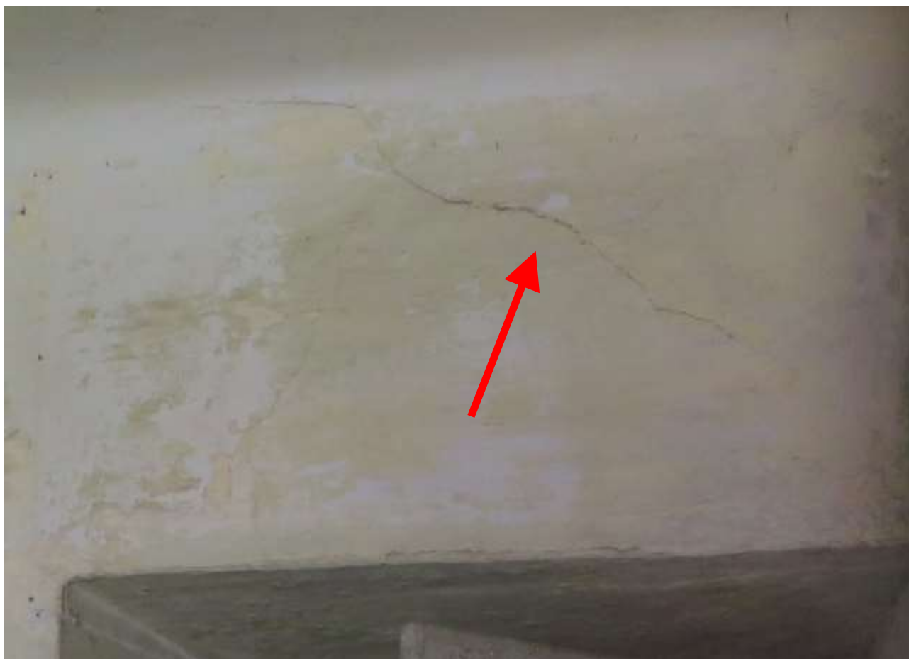
Figura 4-31. PALAZZO PARETO – PT - Vano 4 – Fessura inclinata sopraporta Parete C
