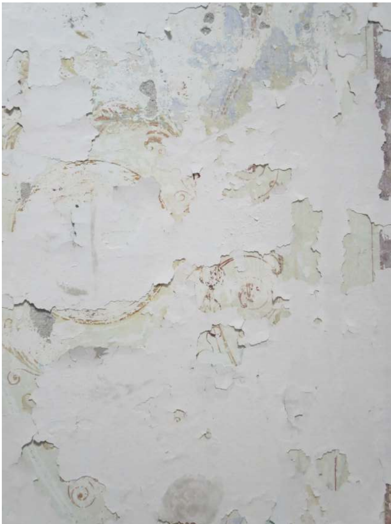
Figura 4-196. PALAZZO PARETO – P1 - Vano 14 – Resti di decorazioni a Soffitto
