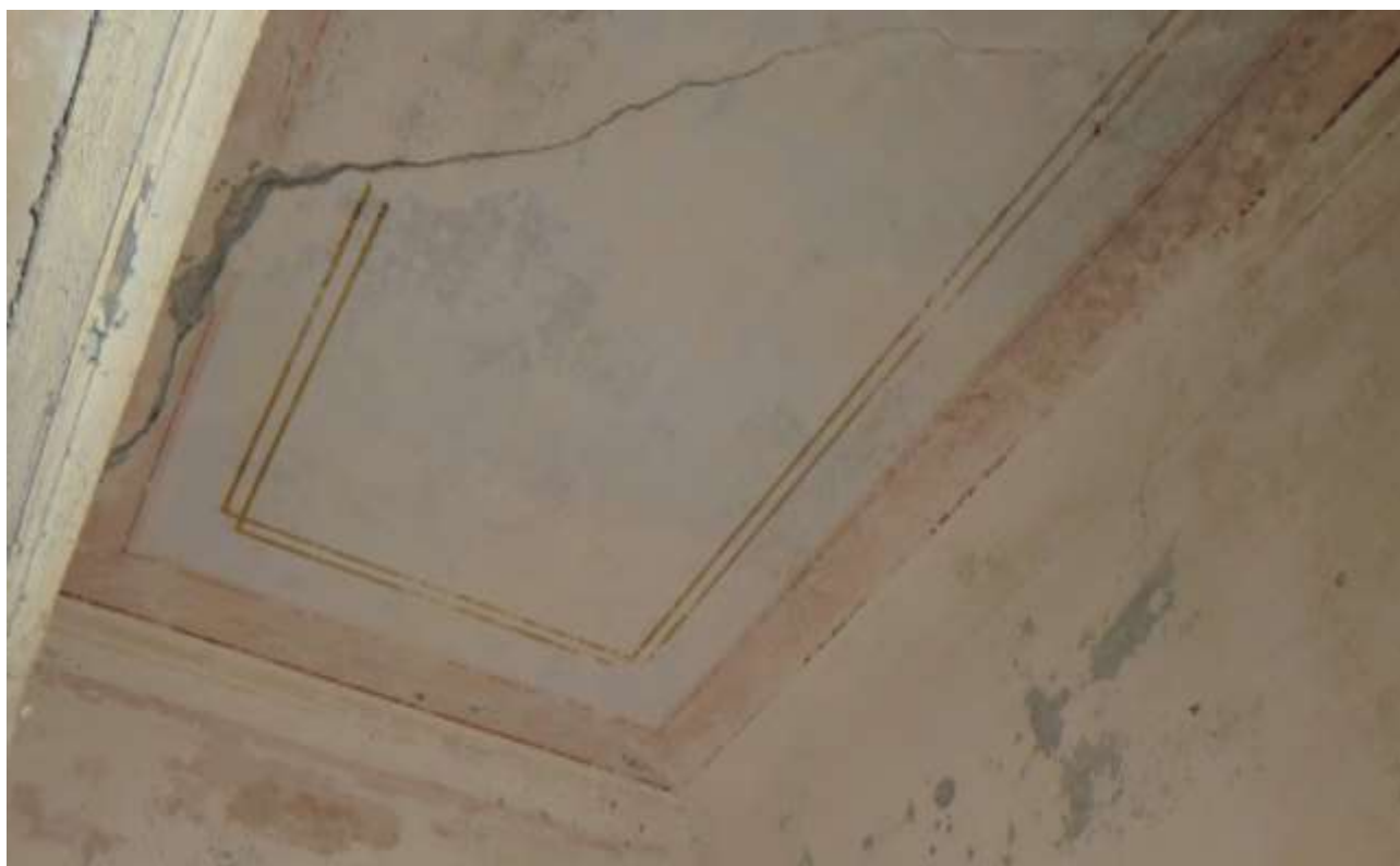
Figura 4-185. PALAZZO PARETO – P1 - Vano 13 – Soffitto decorato con fessura (sul fondo pareti B e C)
