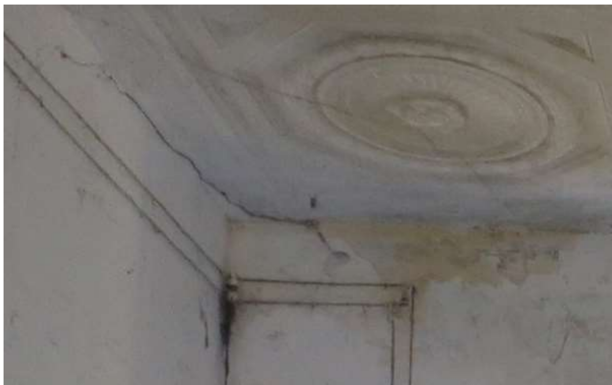
Figura 4-134. PALAZZO PARETO – P1 - Vano 5 – Dettaglio 1 Fessure a Soffitto (sul fondo Parete A)
