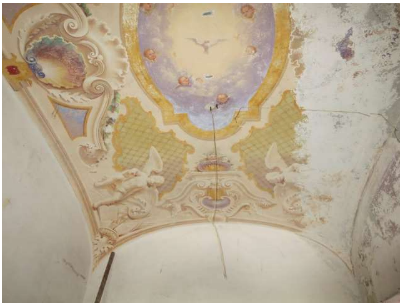
Figura 4-86. PALAZZO PARETO – PT - Vano 12 – (sul fondo Parete A) Soffitto con porzione lato destro ammalorata (da precedente umidità)
