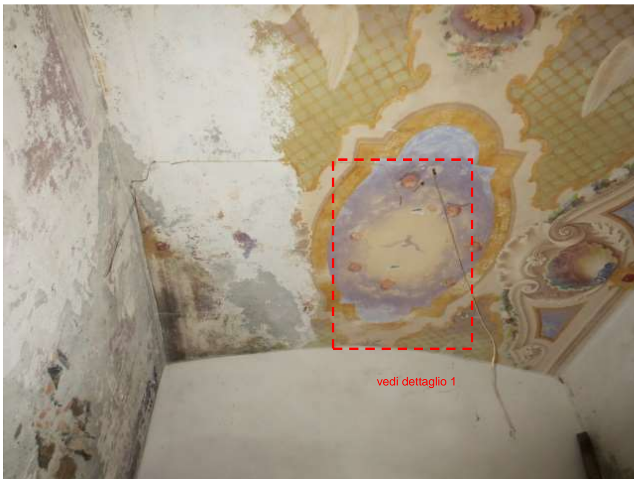
Figura 4-87. PALAZZO PARETO – PT - Vano 12 – (sul fondo Parete C) Soffitto con porzione lato sinistro ammalorata (da precedente umidità)
