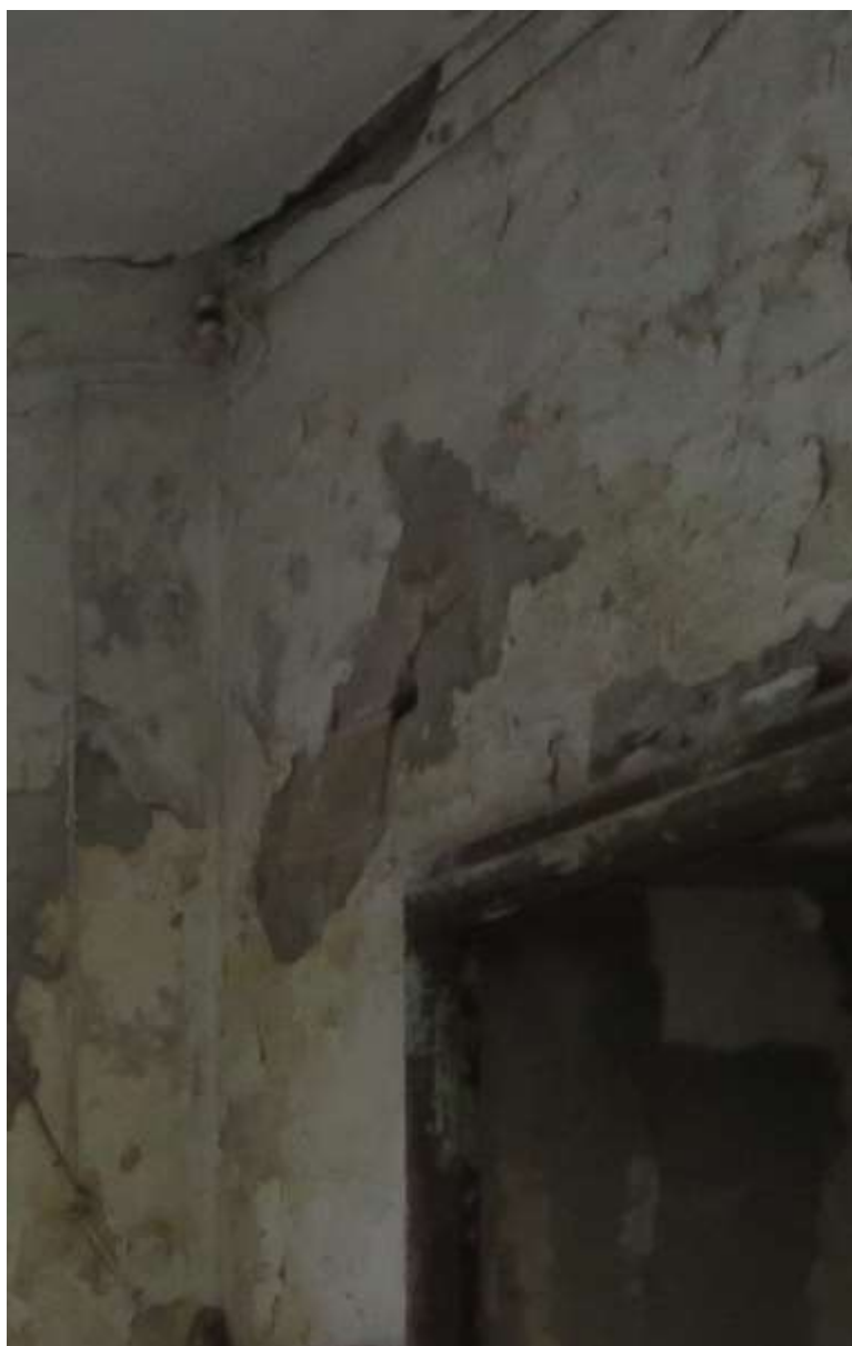
Figura 4-147. PALAZZO PARETO – P1 - Vano 7 – Angolo sopraporta di Parete D-C
