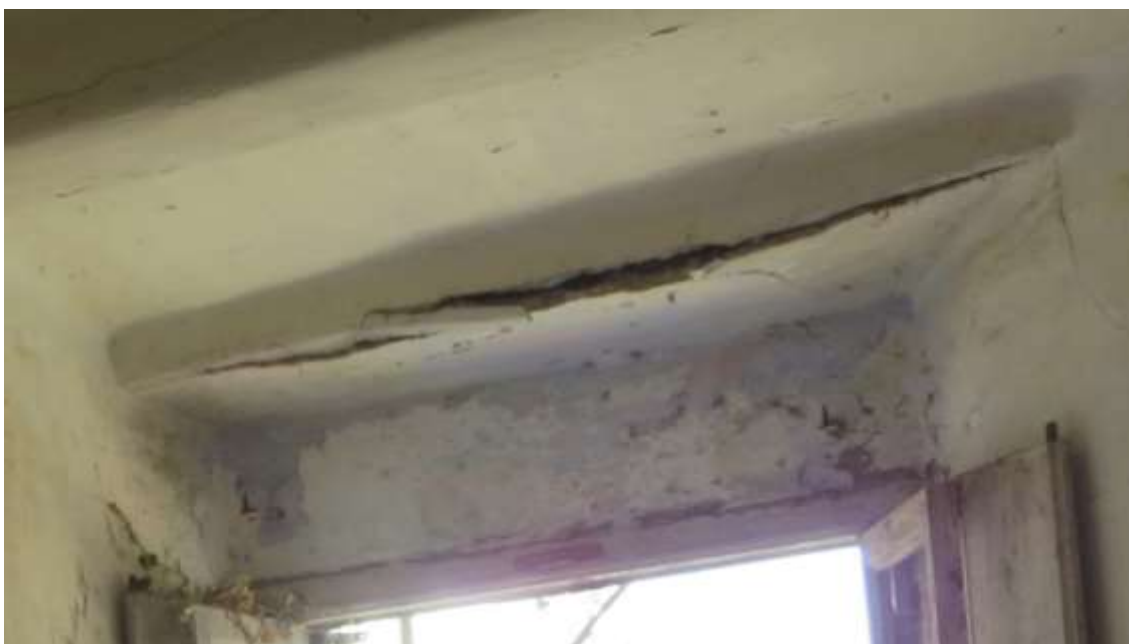
Figura 4-28. PALAZZO PARETO – PT - Vano 4 – Fessura sopra finestra di Parete A
