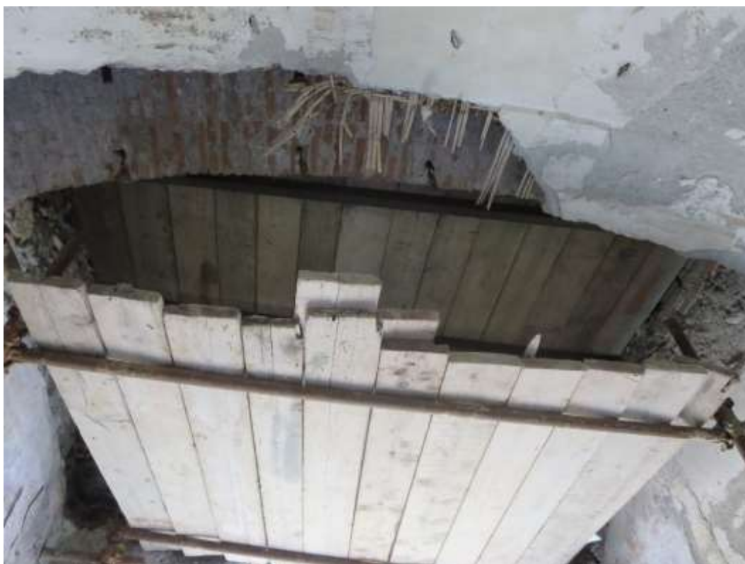
Figura 4-74. PALAZZO PARETO – PT - Vano 11 – Controsoffitto in arelle (crollato)
