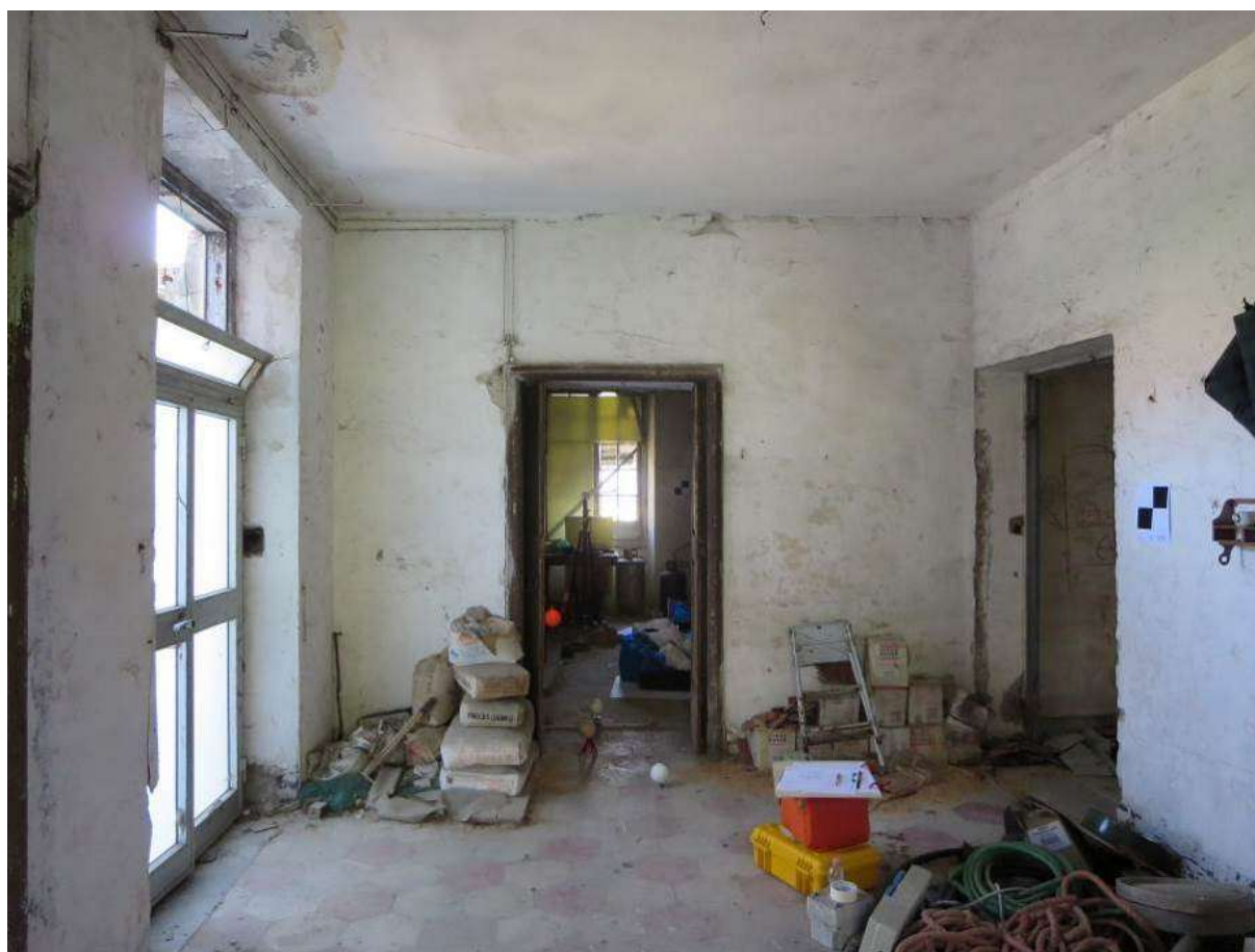
Figura 4-144. PALAZZO PARETO – P1 - Vano 7 – Parete A
