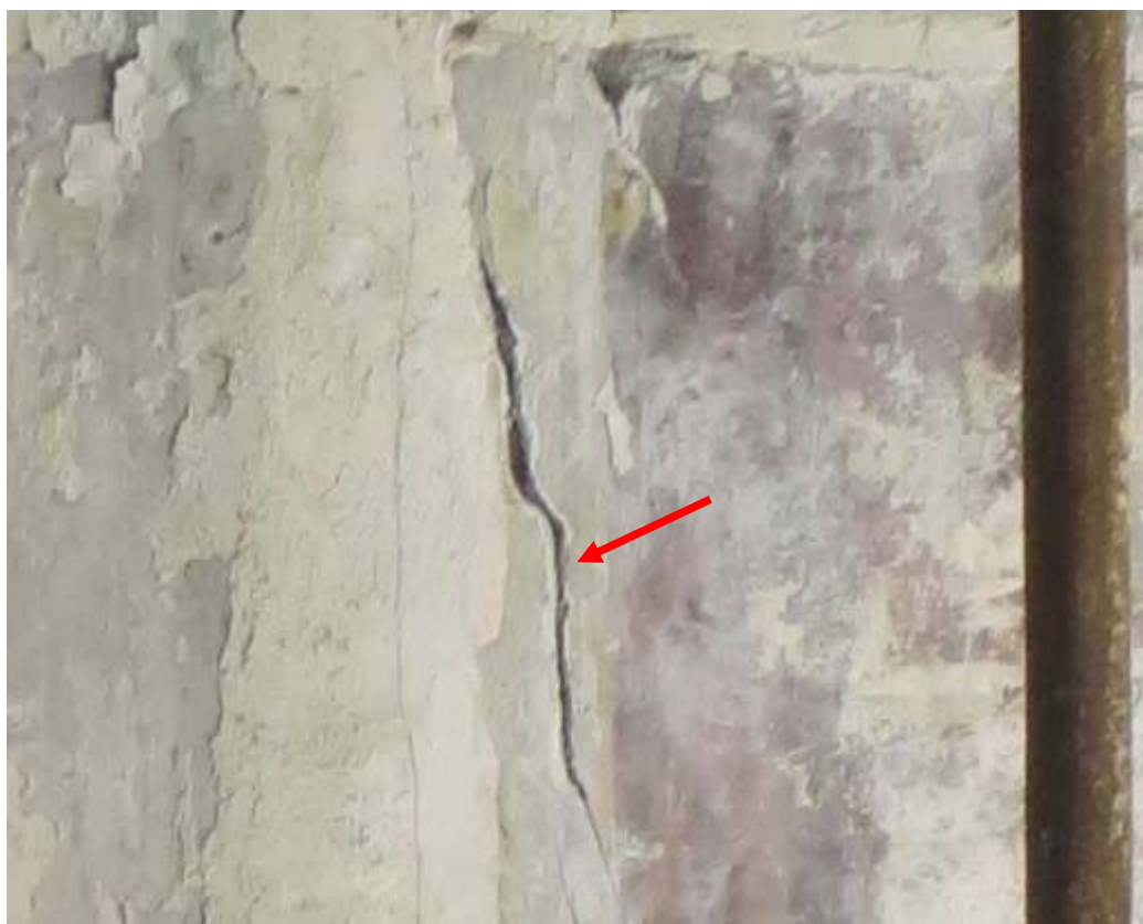
Figura 4-76. PALAZZO PARETO – PT - Vano 11 – Fessura Dettaglio 1 Parete B
