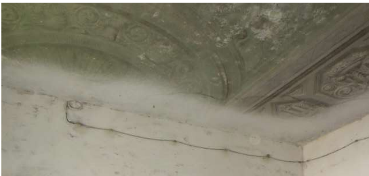
Figura 4-135. PALAZZO PARETO – P1 - Vano 5 – Soffitto (Angolo Parete B-C) con tracce di efflorescenze lungo i muri
