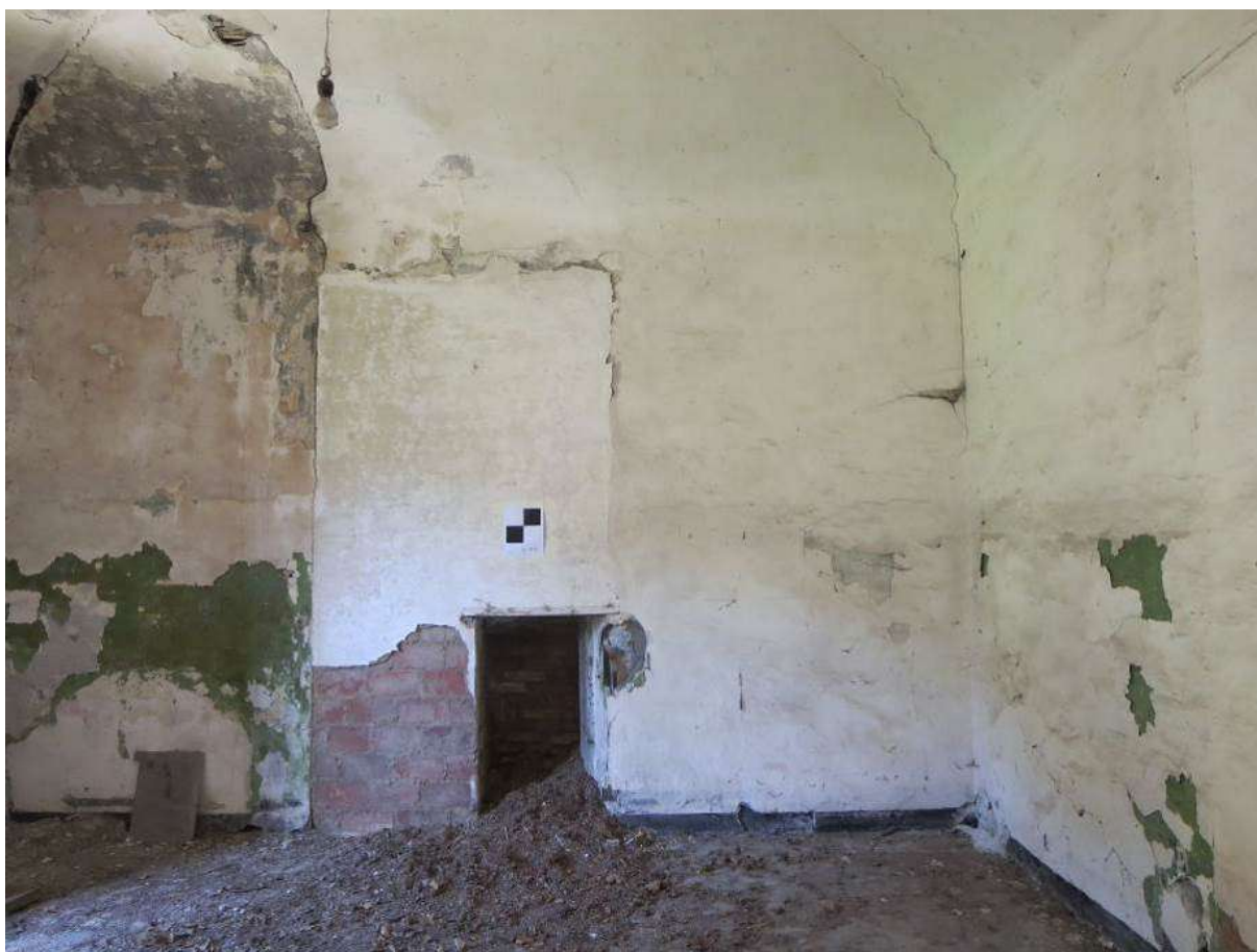
Figura 4-103. PALAZZO PARETO – P1 - Vano 1 – Parete D
