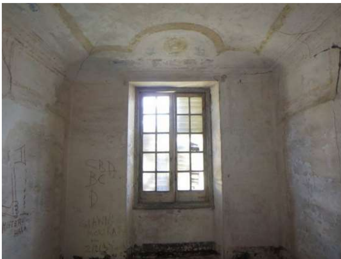
Figura 4-168. PALAZZO PARETO – P1 - Vano 11 – Parete A
