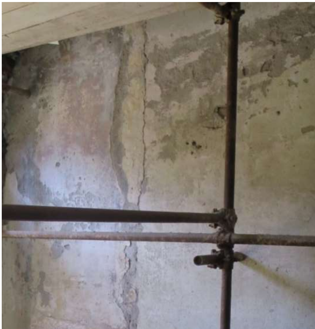
Figura 4-80. PALAZZO PARETO – PT - Vano 11 – Fessura Parete D
