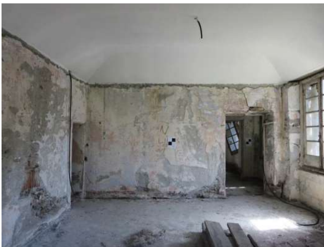
Figura 4-150. PALAZZO PARETO – P1 - Vano 8 – Parete A
