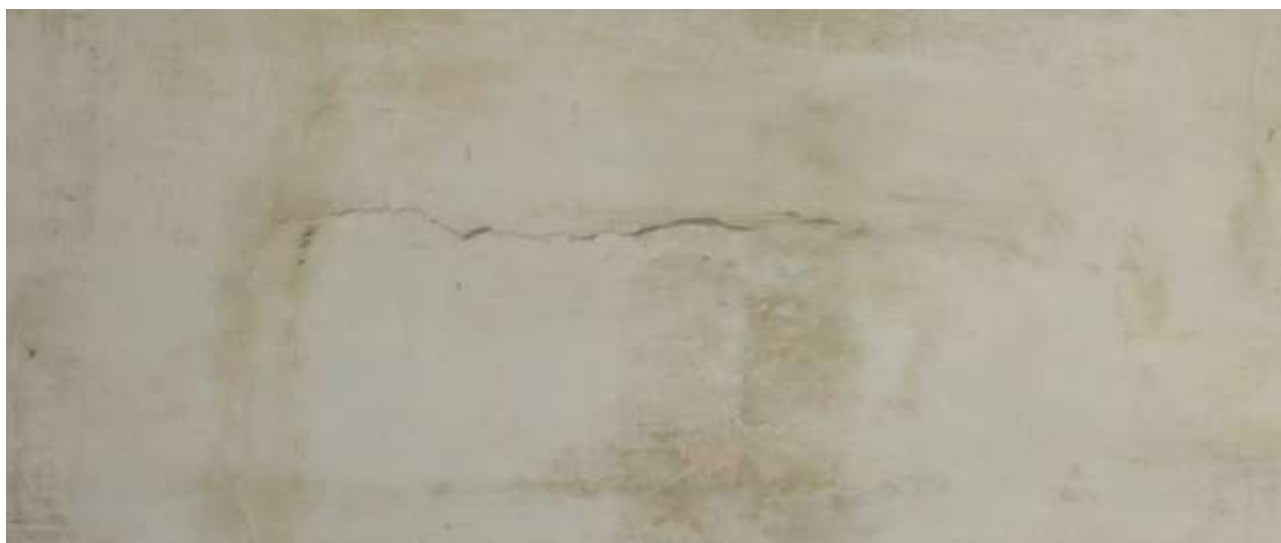
Figura 4-25. PALAZZO PARETO – PT - Vano 3 – Fessura orizzontale Parete D
