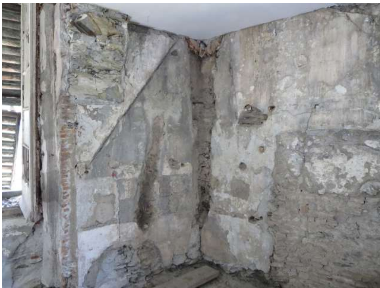
Figura 4-154. PALAZZO PARETO – P1 - Vano 8 – Particolare Angolo Parete C-D (demolizioni perpetrate nel tempo)
