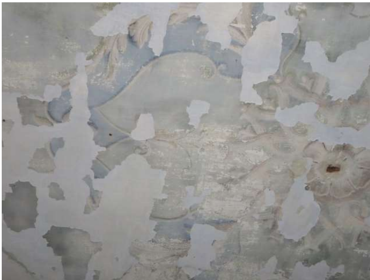
Figura 4-18. PALAZZO PARETO – PT - Vano 2 – Stato di degrado a soffitto (centro stanza)
