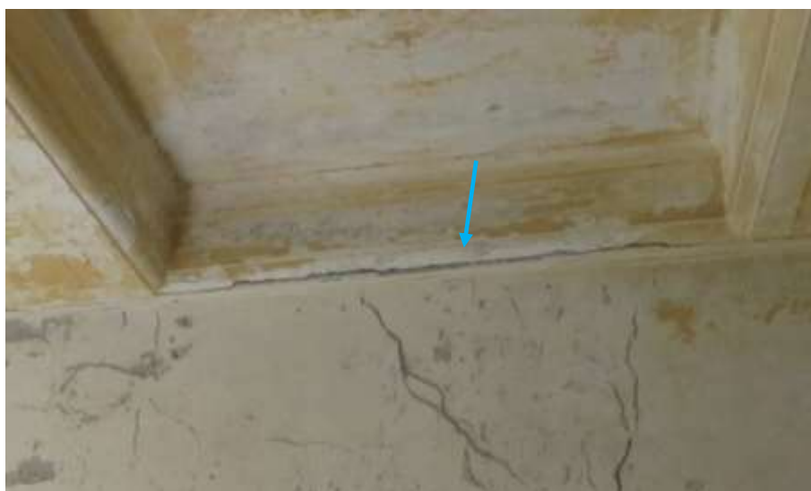
Figura 4-8. PALAZZO PARETO – PT - Vano 1 – Dettaglio 2 (fessure a soffitto sopra Parete C)
