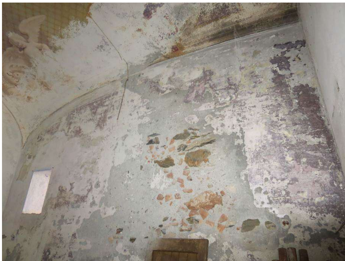
Figura 4-83. PALAZZO PARETO – PT - Vano 12 – Parete B (muro danneggiato da precedente umidità)
