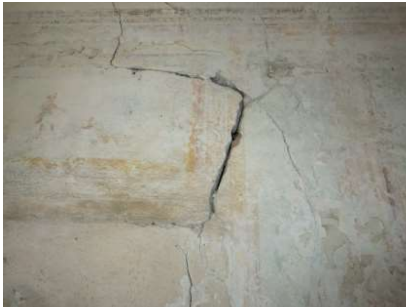
Figura 4-171. PALAZZO PARETO – P1 - Vano 11 – Dettaglio Parete B con porta di sinistra tamponata (particolare fessure sopraporta)
