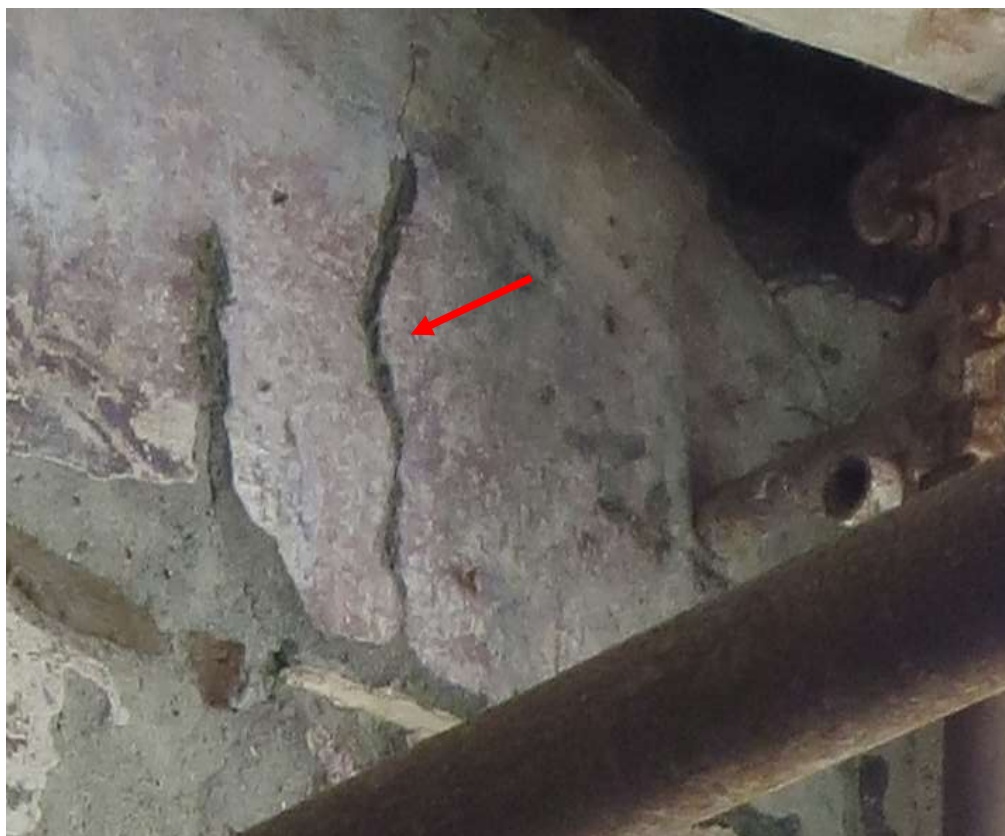
Figura 4-77. PALAZZO PARETO – PT - Vano 11 – Fessura Dettaglio 2 Parete B
