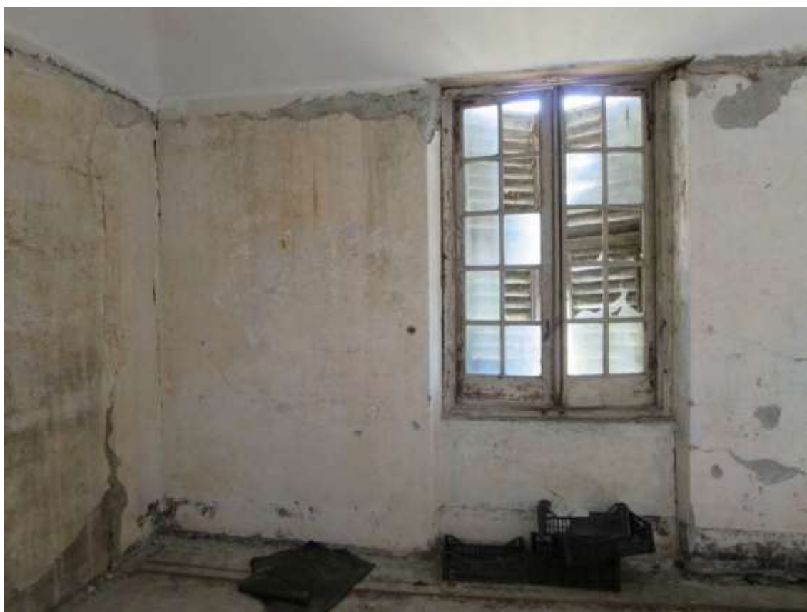
Figura 4-163. PALAZZO PARETO – P1 - Vano 10 – Parete A
