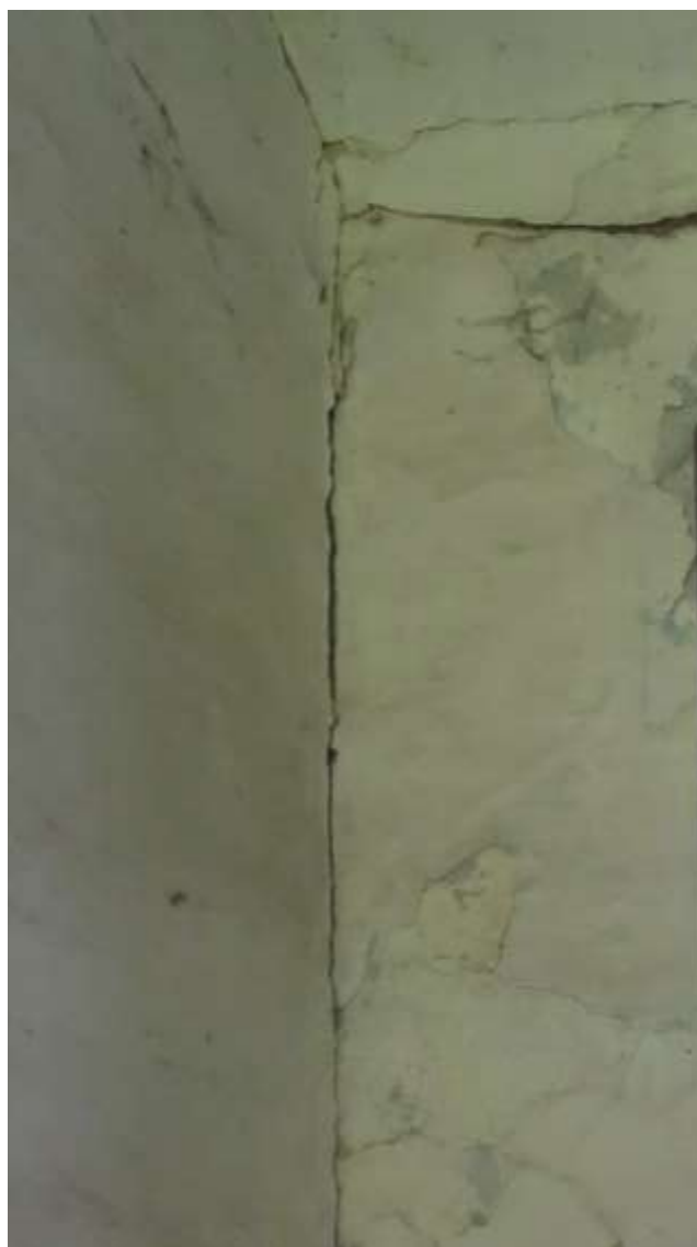
Figura 4-106. PALAZZO PARETO – P1 – Dettaglio 1 fessura verticale Vano 2 – Parete A
