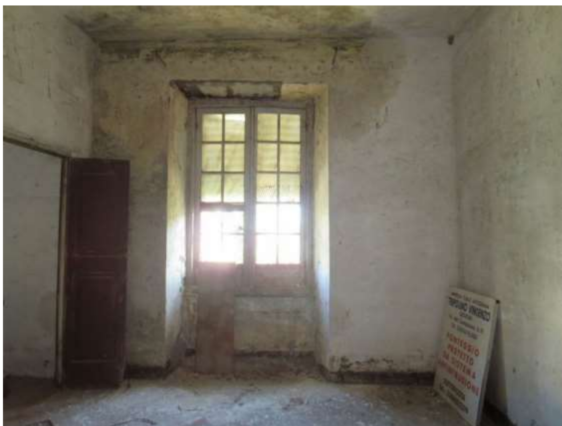
Figura 4-138. PALAZZO PARETO – P1 - Vano 6 – Parete A
