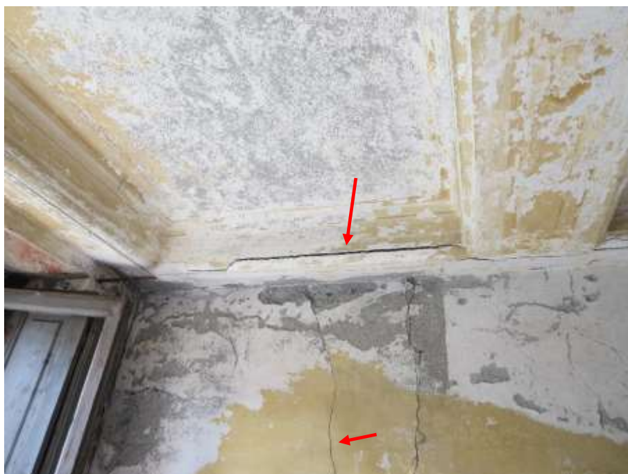
Figura 4-7. PALAZZO PARETO – PT - Vano 1 – Dettaglio 1 (fessure a soffitto sopra Parete C e verticale su Parete C)
