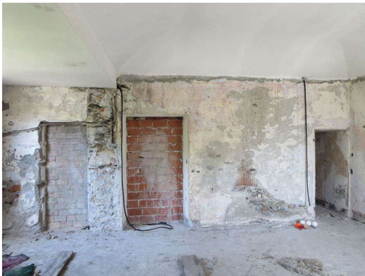
Figura 4-153. PALAZZO PARETO – P1 - Vano 8 – Parete D
