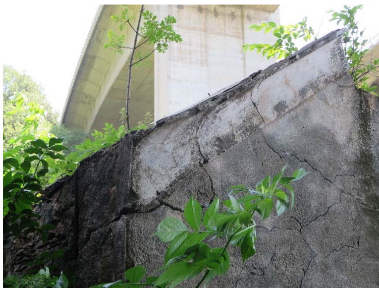
Figura 5-9. FILANDA – Lesione cornicione angolo Nord-Ovest
