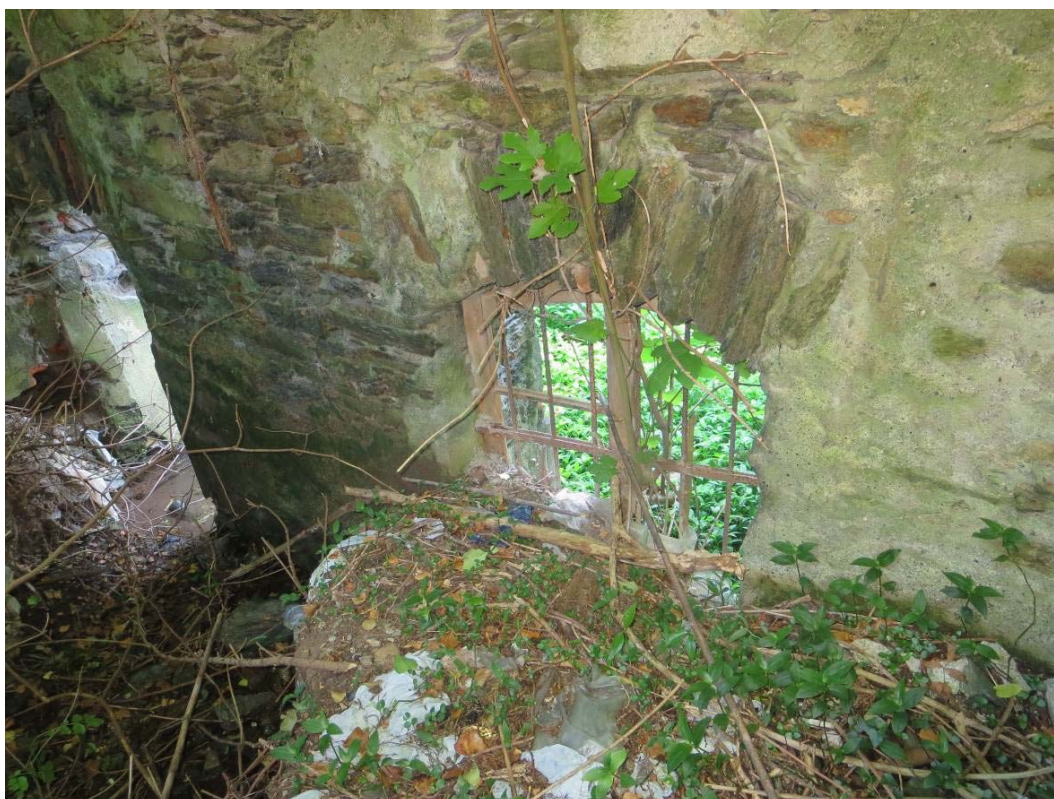
Figura 5-7. FILANDA – Finestra con depositi fermati dalla grata
