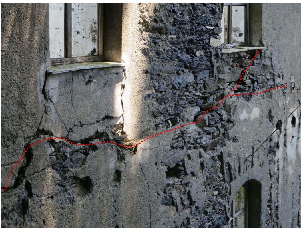
Figura 3-3. FILANDA – Linea di frattura/scivolamento del fuori piombo Muro lato sud-ovest
