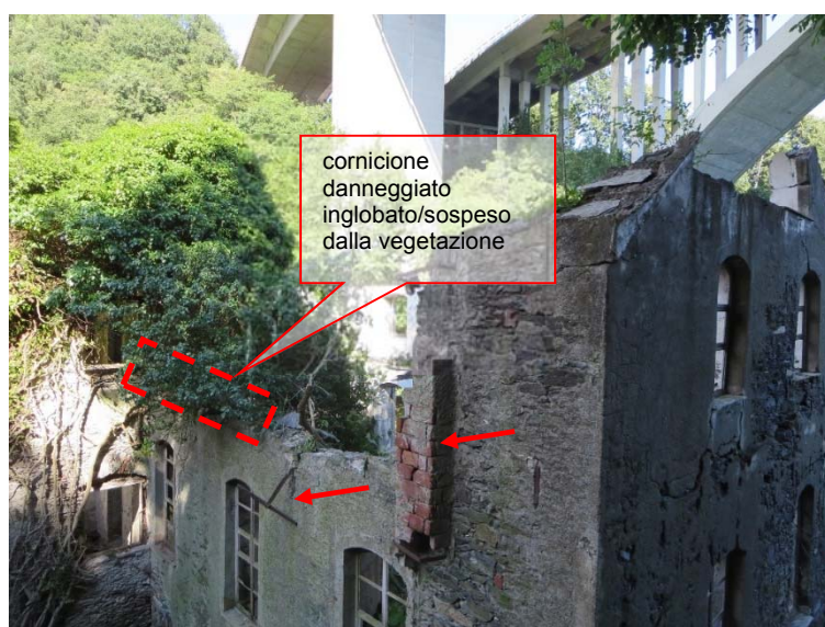
Figura 5-10. FILANDA – Catene metalliche spezzate e canna fumaria parzialmente crollata
