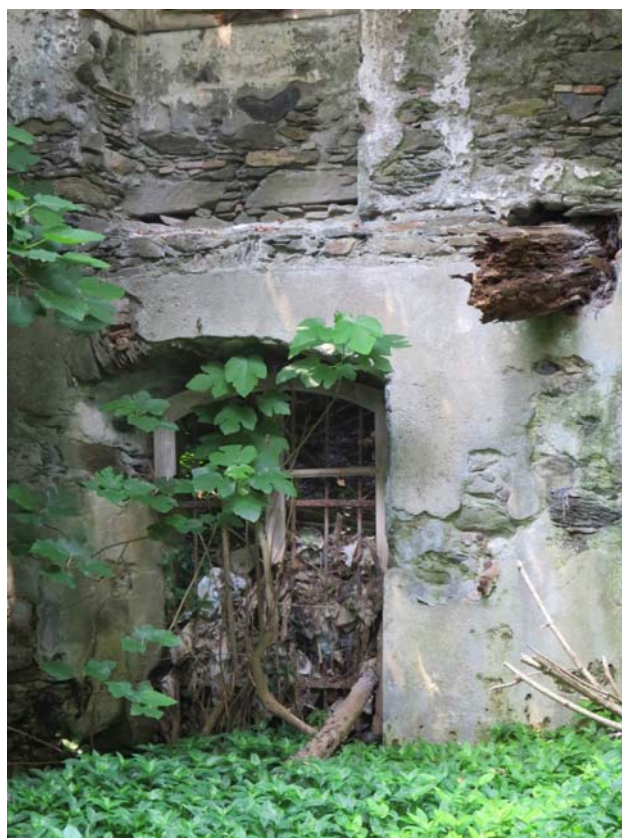
Figura 5-8. FILANDA – Finestra con depositi fermati dalla grata
