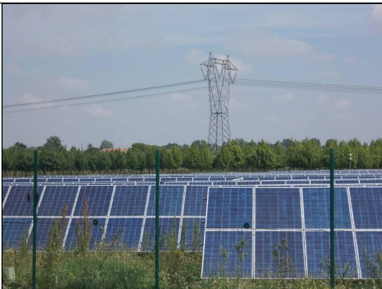
Foto 15: Parco fotovoltaico nei pressi del Cluster E È Area Pozzo n. 18
