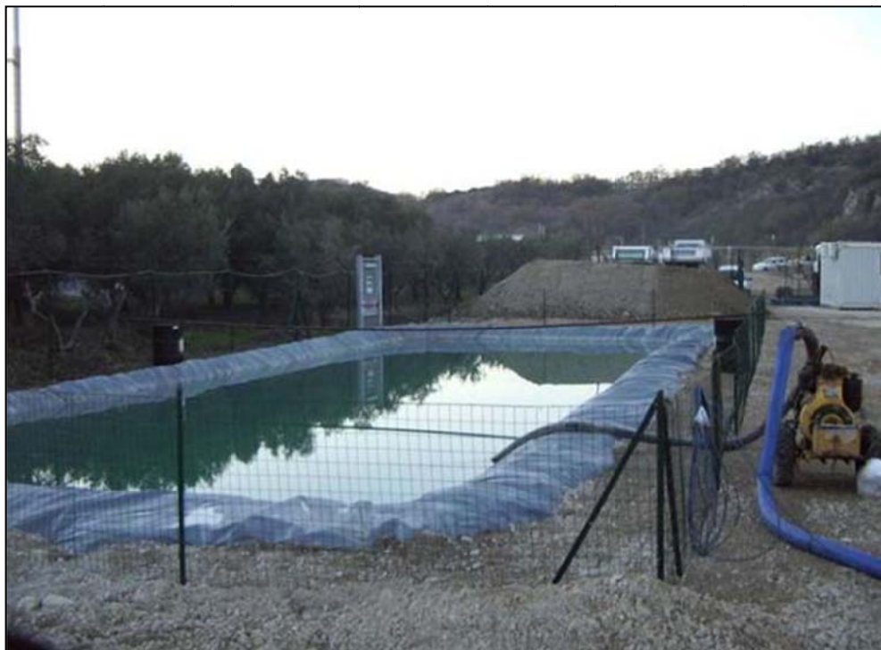
Figura 2.5: Vascone per lo Stoccaggio in Cantiere dell'Acqua Industriale
