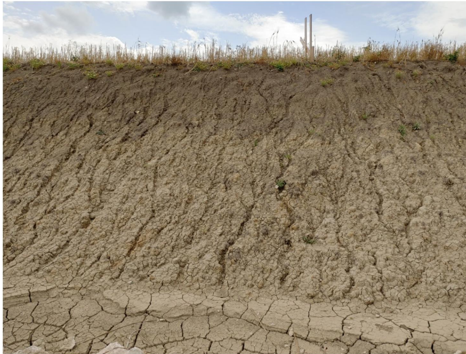
Fig.6.7 . Fenomeno generalizzato di ruscellamento e colamento di terra al piede di una scarpata con Argille Subappennine affioranti, presso Masseria Monaca lungo il Tracciato A (progr. 26.500 del tratto in categoria C1)
