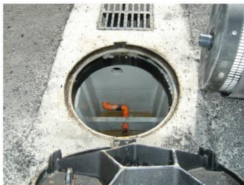
Figura 5-1 Esempio di impianto monoblocco
