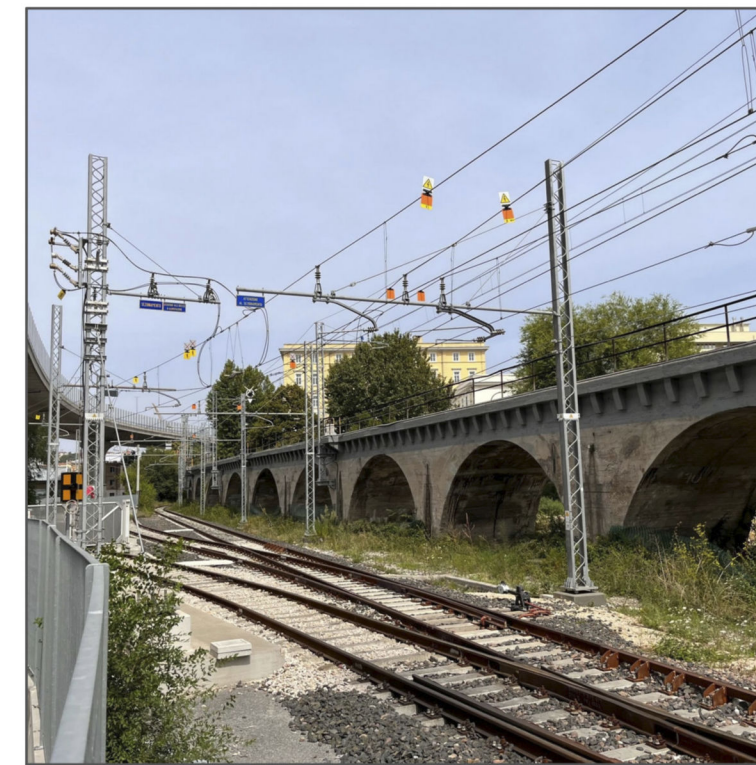
11 Sezionamento elettrico raccordo HHLA
