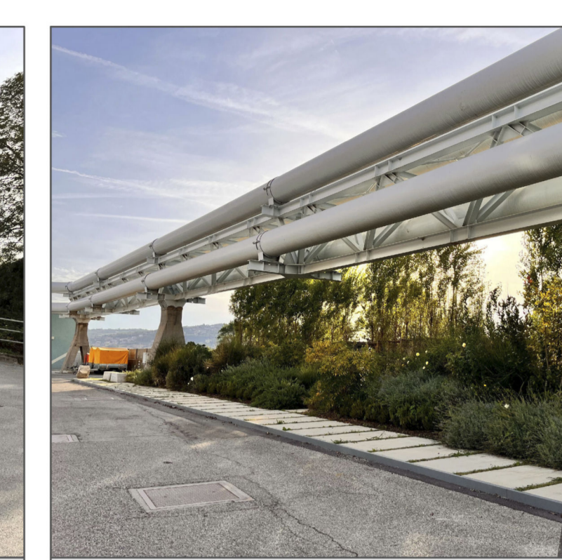
27 Tubi dell'adiacente terminal SIOT per lo scarico del petrolio al di sotto dei quali è prevista la realizzazione dell'accesso all'Acciaieria Arvedi
