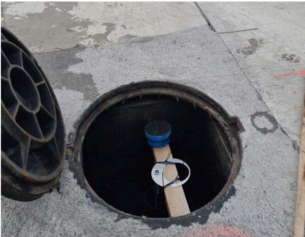
Figura 3 – dettaglio installazione sensore su piezometro PSP2
