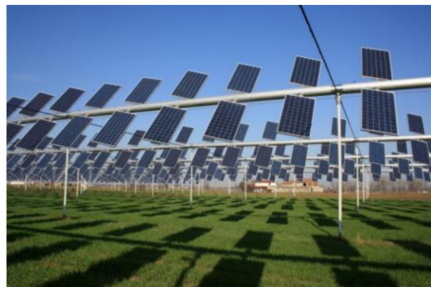
Figura 11: rete di cavi di acciaio che connette i pannelli fotovoltaici
