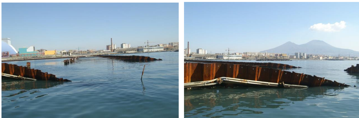
Figura 2-2: Dettagli del tratto di paratia divelto (foto 2010 dopo mareggiata)
