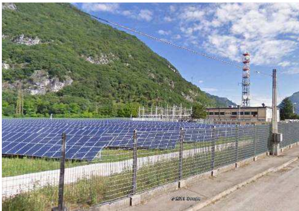
stazione elettrica esistente
