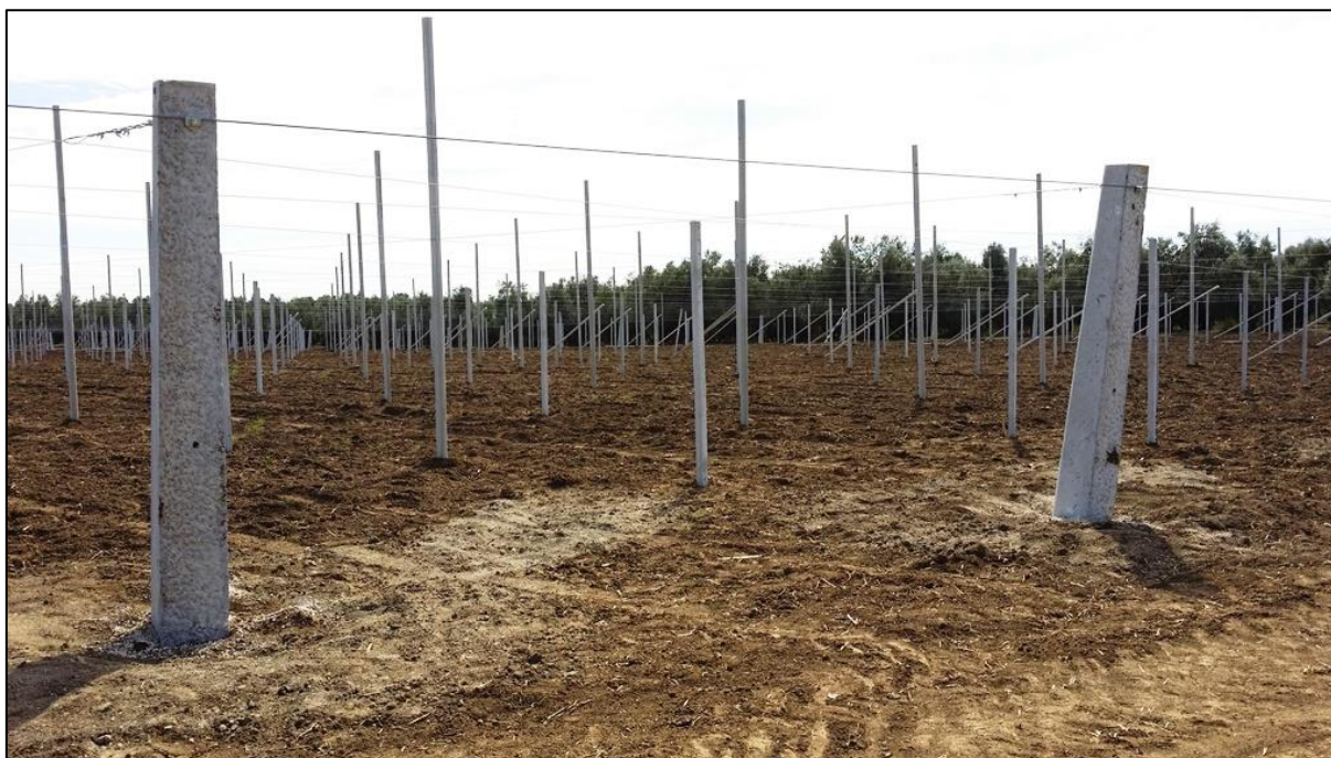
Figura 11. Piloni di ancoraggio cavi
