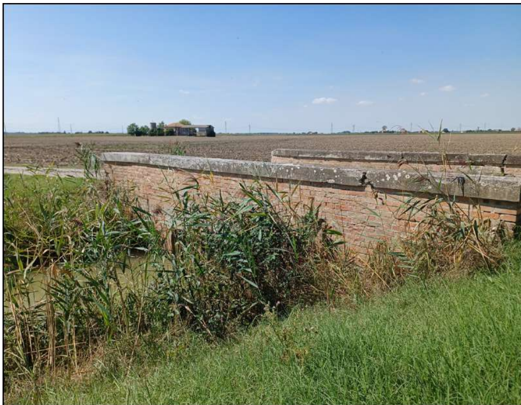
Ponte non idoneo lato nord
