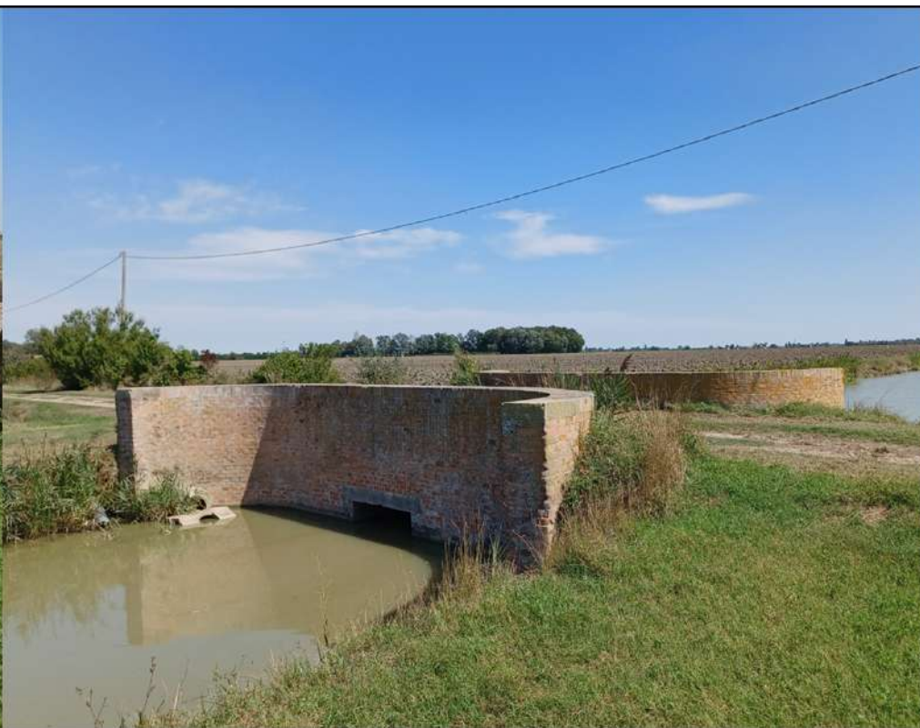
Ponte non idoneo lato nord
