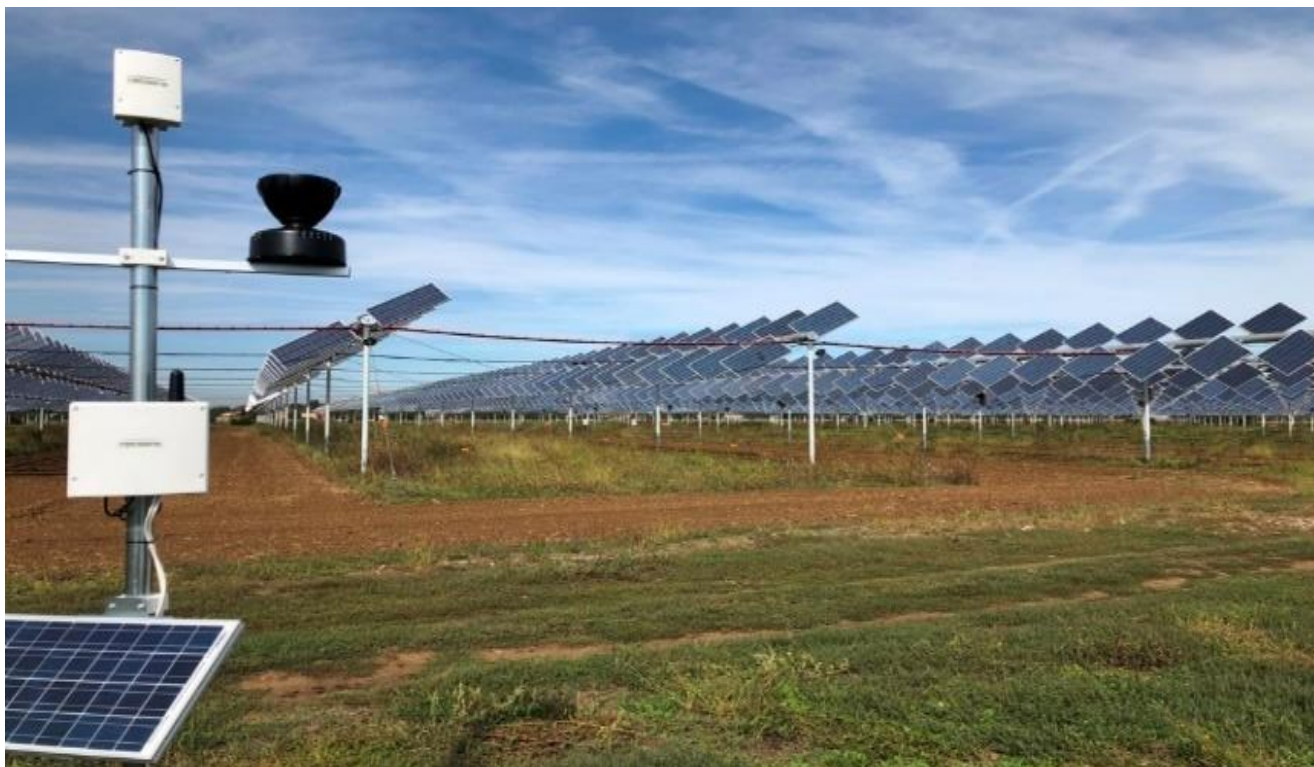
Figura 7 - Stazione di monitoraggio ambientale del tipo Netsense o equivalente
