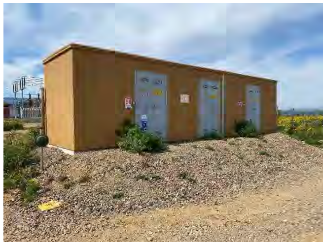
Immagine 12: tipologia cabina inverter
