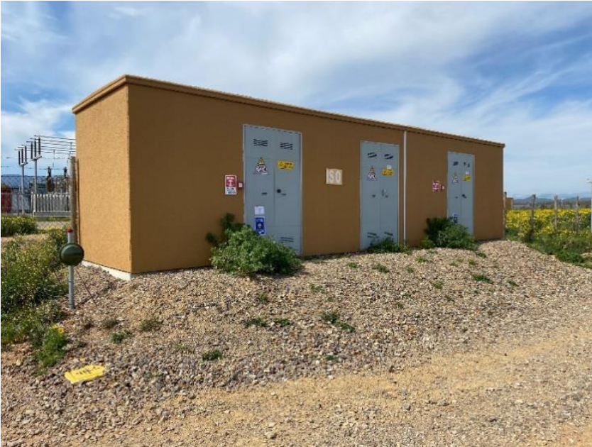
Immagine 3.3: tipologia cabina inverter
