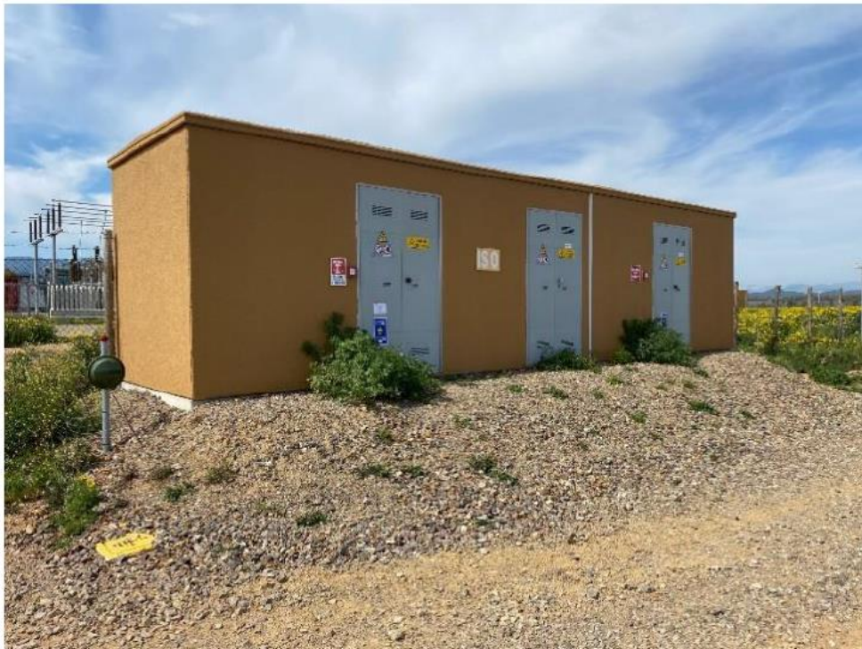
Figura 14 - tipologia delle cabine di campo
