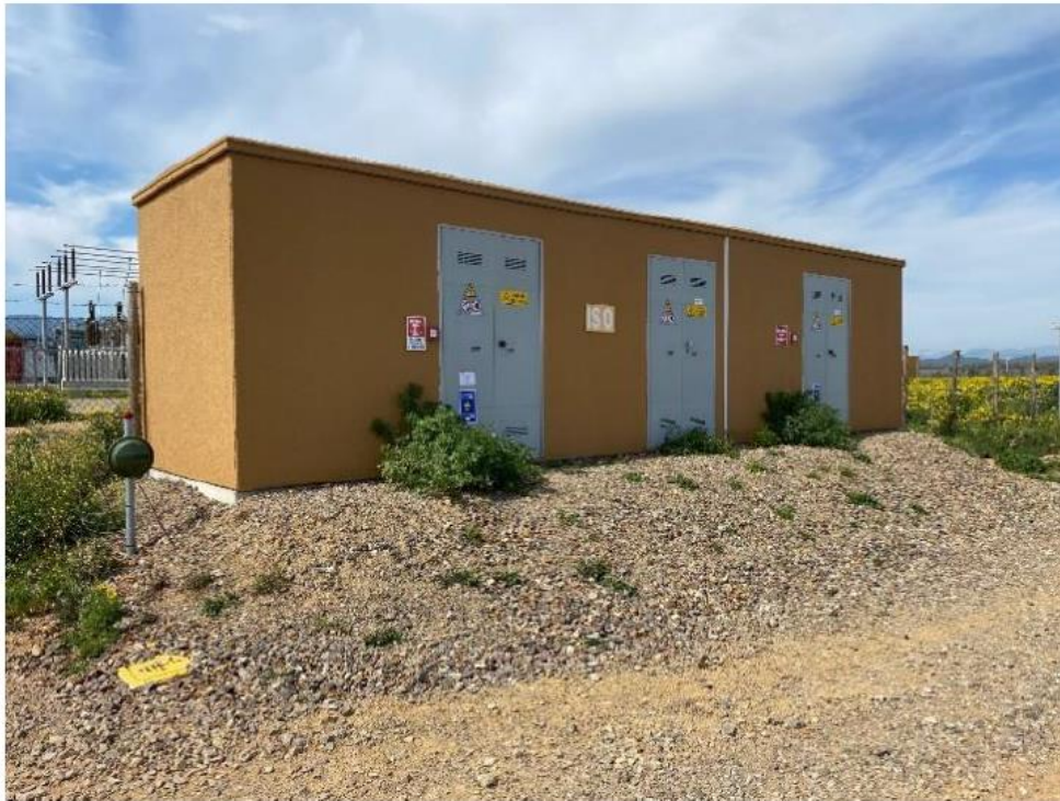
Figura 13 - tipologia delle cabine di campo
