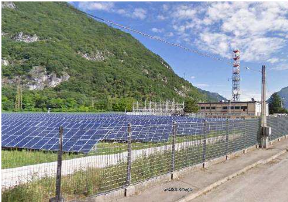
stazione elettrica esistente
