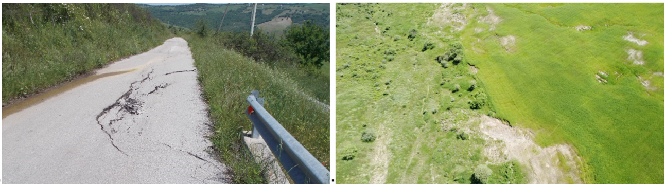
Panoramica dei fenomeni gravitativi e di instabilità osservati
