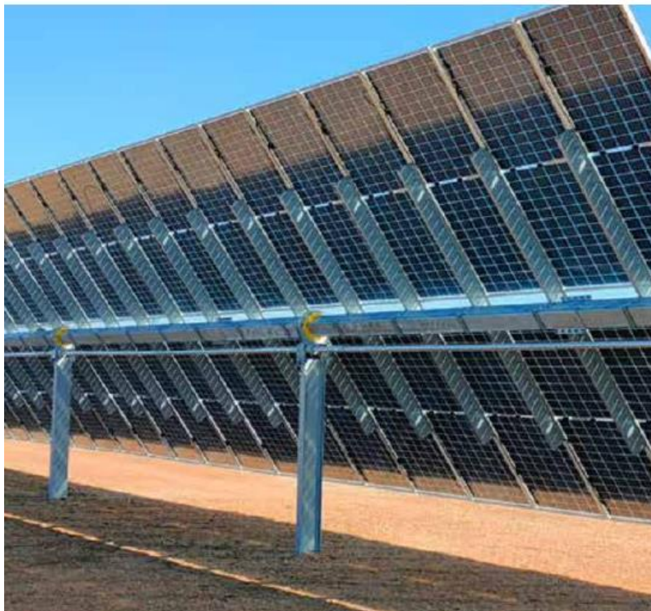
Figura 4 – Inseguitori monoassiali Est-Ovest
