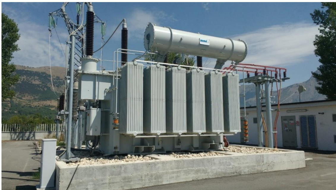
Figura 2 – Esempio di trasformatore MT/AT installato in una SSE
