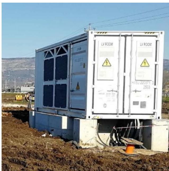
Figura 9 – Smart Tasformer Station-3000K-H1 all'interno di un impianto FV esistente
