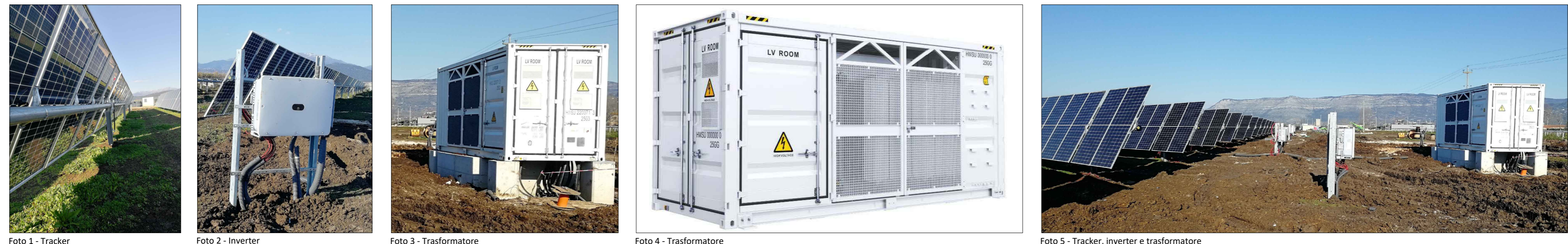
Foto 1 - Tracker Foto 2 - Inverter Foto 3 - Trasformatore Foto 4 - Trasformatore Foto 5 - Tracker, inverter e trasformatore
